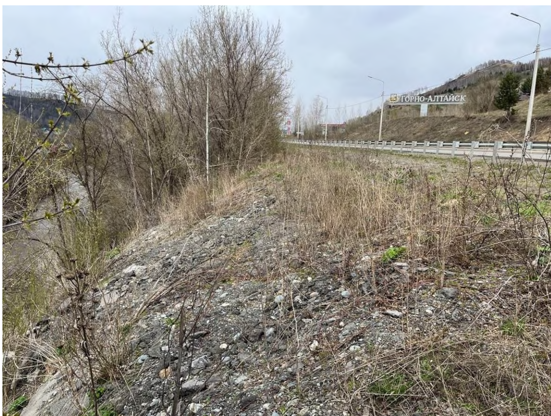
Фото 04-11-00010. Серия трещин и уступов в вершине оползня, автодорога Горно-Алтайск – Кызыл-Озек, 0,125 км, Майминский район, Республика Алтай, 25.04.2024
