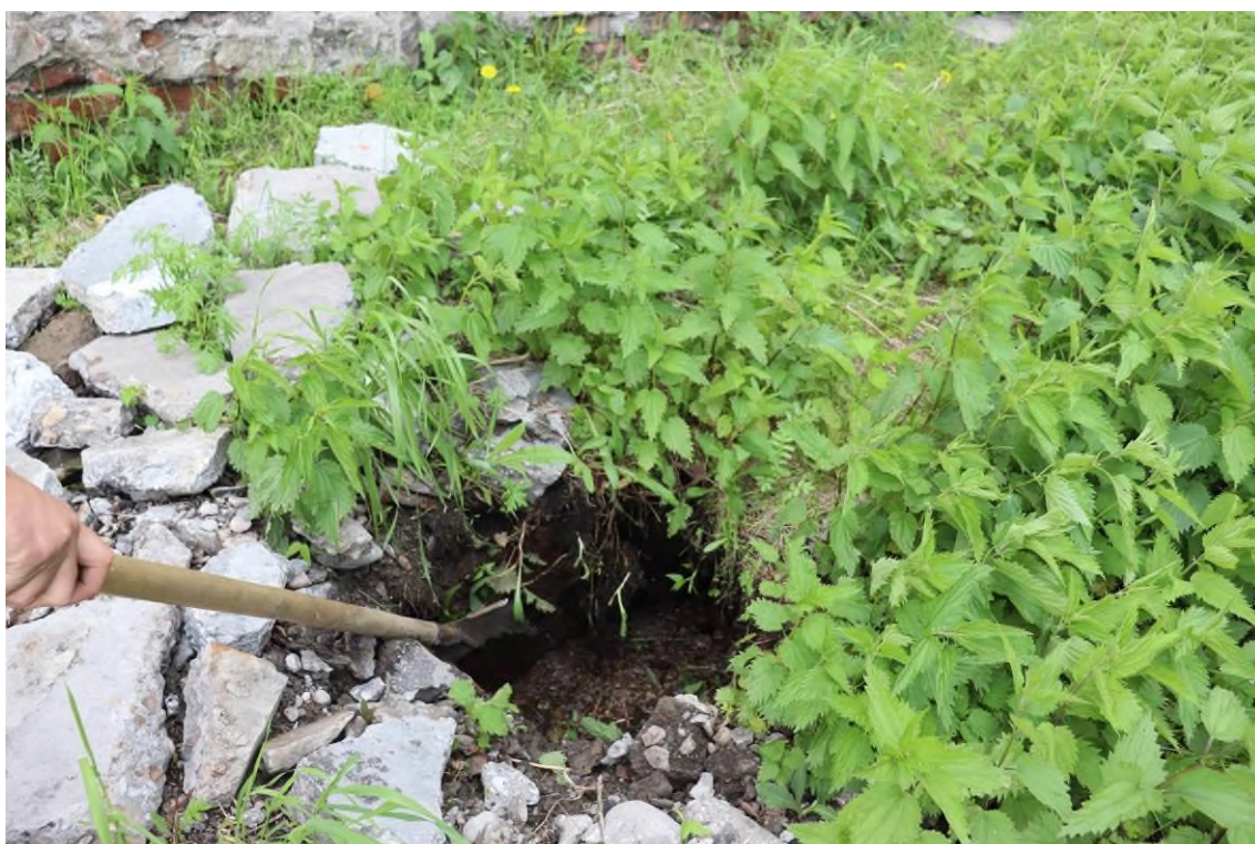
Фото 38-13-00001. В провале у стены дома по ул. Павлова, 22 УГВ составляет 0,5 м от поверхности, г. Черемхово, Черемховский район, Иркутская область, 05.06.2024
