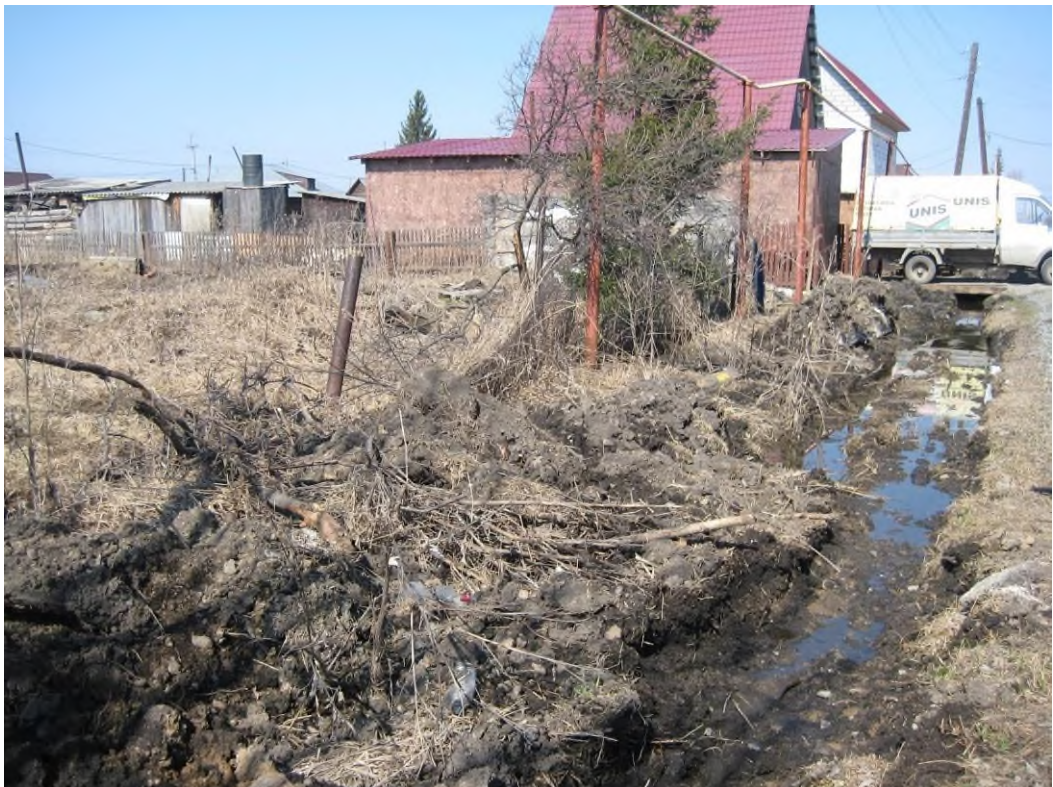
Фото 54-13-00006.б. Ул. Комсомольская, 11. Уровни воды в придорожных канавах находятся на тех же отметках, что и уровни грунтовых вод. пгт. Мошково, Мошковский район, Новосибирская область, 26.04.2024
