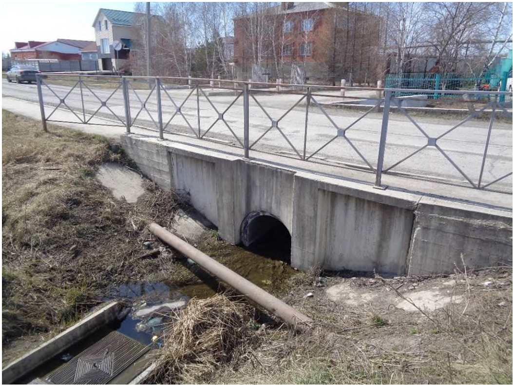
Фото 54-13-00001.б. Магистральный канал по ул. Островского - дренажная труба через улицу постоянно выше отметки уровня воды в канале. г. Барабинск, Барабинский район, Новосибирская область, 27.04.2024
