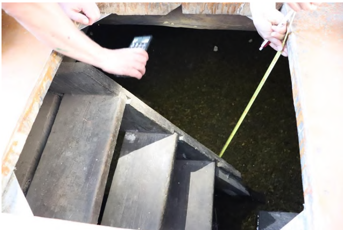
Фото 38-13-00004. Подтопленное подполье по ул. Покрышкина, 33, г. Иркутск, п. Жилкино, Иркутская область, 31.05.2024
