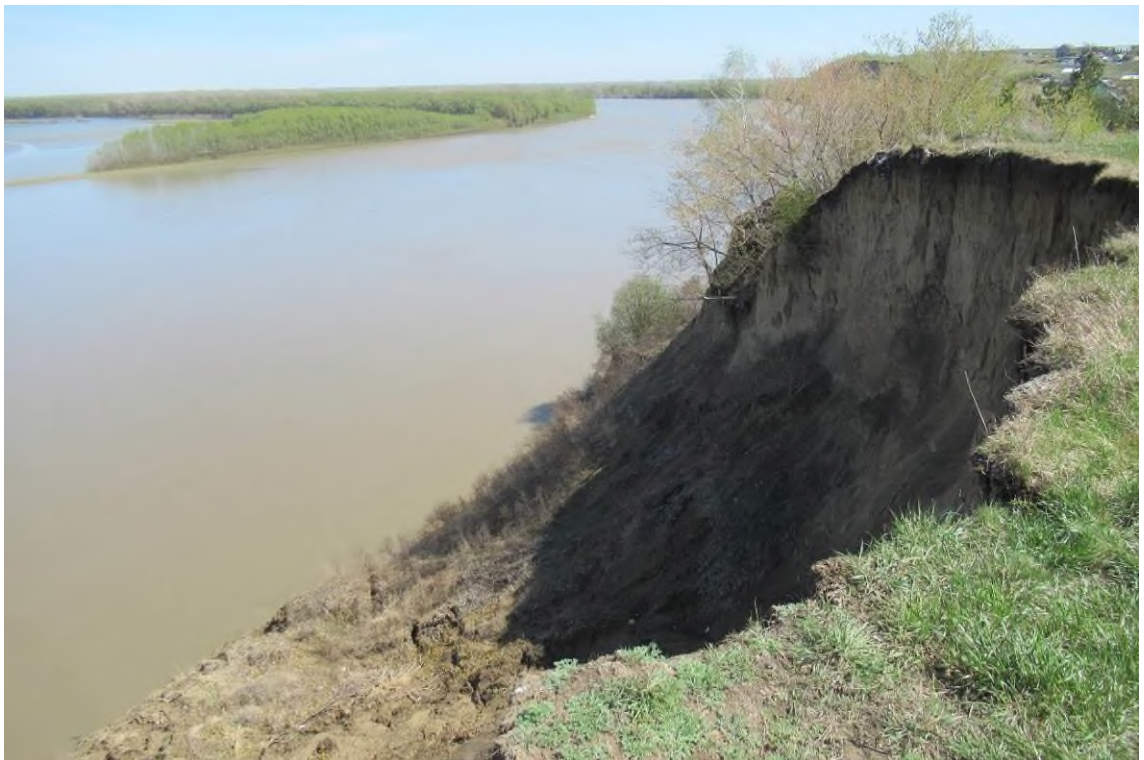
Фото 22-11-00039. Эрозионный оползень на левом береговом склоне долины р. Оби на участке с. Казённая Заимка, в 40 м В ул. Набережная, 25, в г. Барнаул, Алтайский край, 07.05.2024
