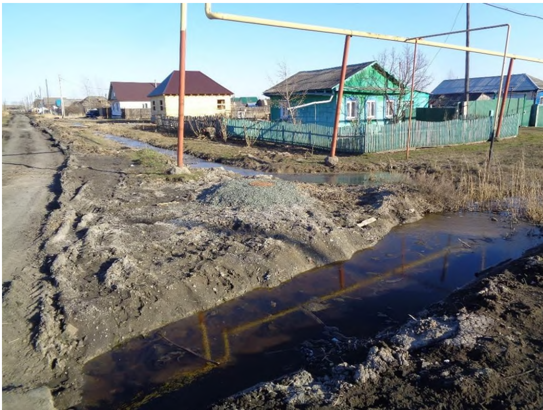
Фото 54-13-00002.б. В магистральном канале по ул. Краснознаменная вода стоит. Уровень грунтовых вод близок к поверхности. г. Татарск, Татарский район, Новосибирская область, 27.04.2024
