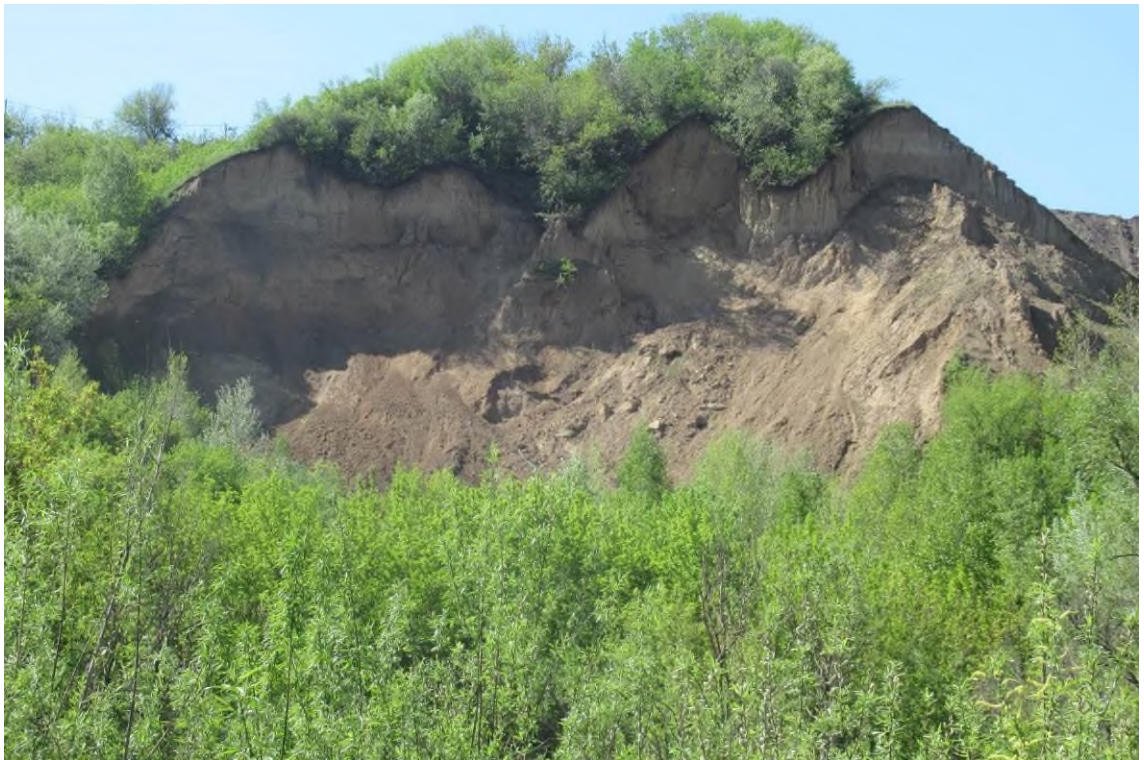
Фото 22-11-00041. Эрозионный оползень на левом береговом склоне долины р. Обь на участке ул. Квартал 953а, 19, в г. Барнаул, Алтайский край, 16.05.2024
