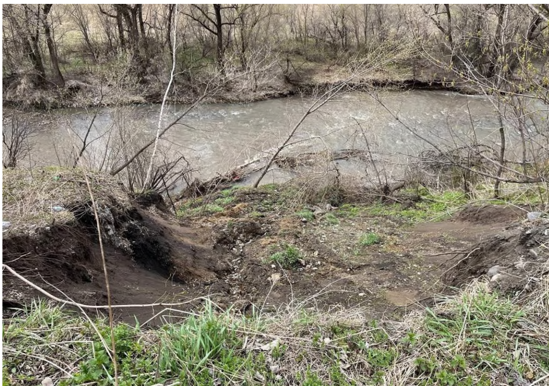
Фото 04-11-00066. Язык оползня, образованного в апреле 2024 г., размыв водами р. Майма, автодорога Горно-Алтайск – Кызыл-Озек, 0,11 км, Майминский район, Республика Алтай, 24.04.2024
