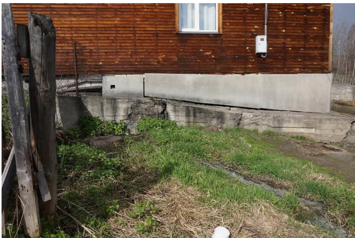
Фото 04-11-00004. Деформация фундамента и отмосток дома в результате активизации оползня по ул. Черноплодная, 10, г. Горно-Алтайск, Республика Алтай, 24.04.2024
