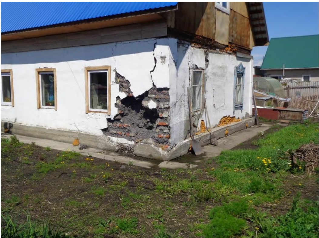
Фото 54-13-00005. Вследствие активизации подтопления грунтовыми водами рушится дом по ул. Октябрьская 29. г. Бердск, Новосибирская область, 23.05.2024
