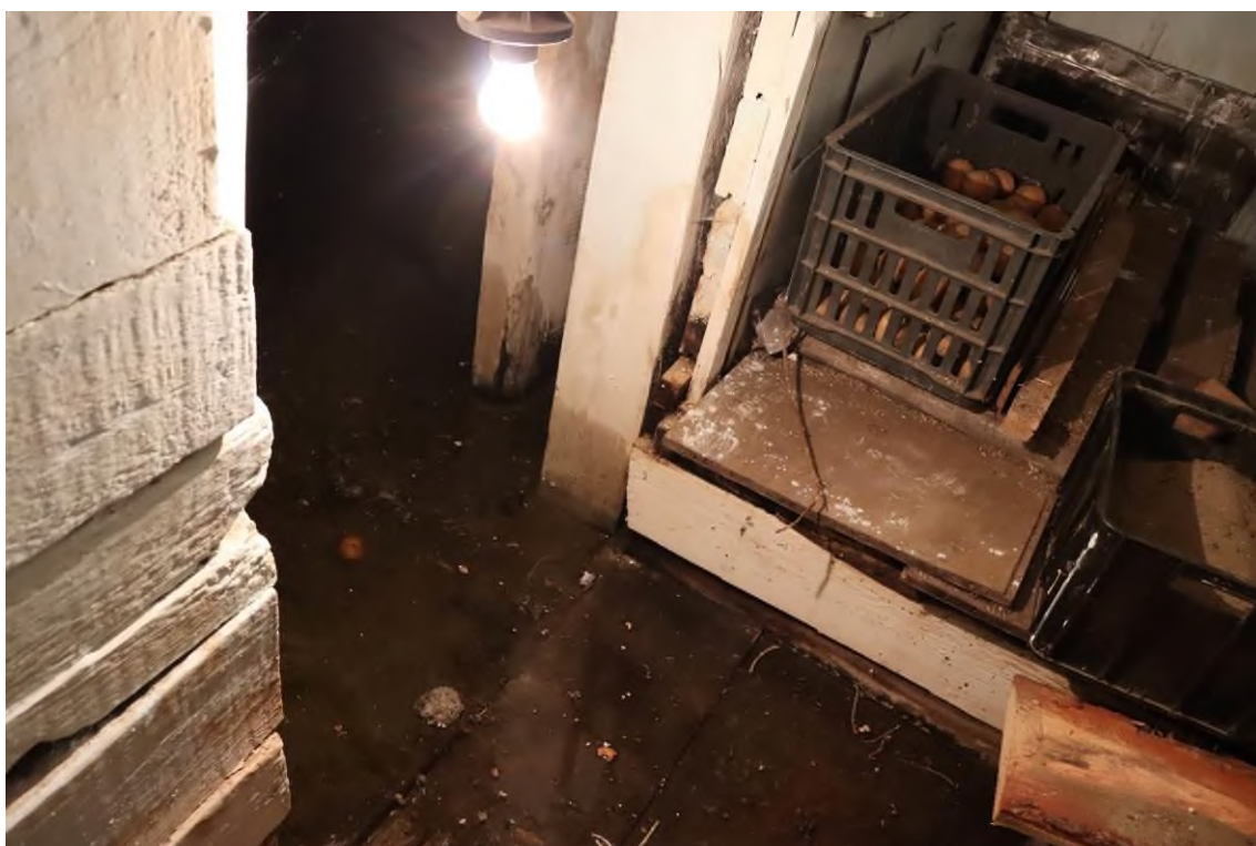
Фото 38-13-00007. Подтопленное подполье по ул. 1-я Линия, 3, г. Иркутск, п. Кирова, Иркутская область, 31.05.2024
