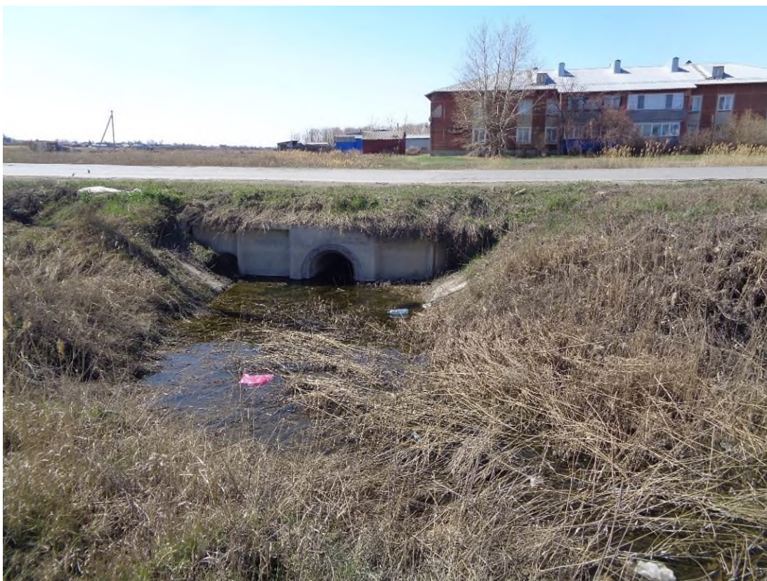
Фото 54-13-00013. Уровень грунтовых вод в районе ул. Розы Люксембург на глубине около 1,0 м. г. Купино, Купинский район, Новосибирская область, 26.04.2024
