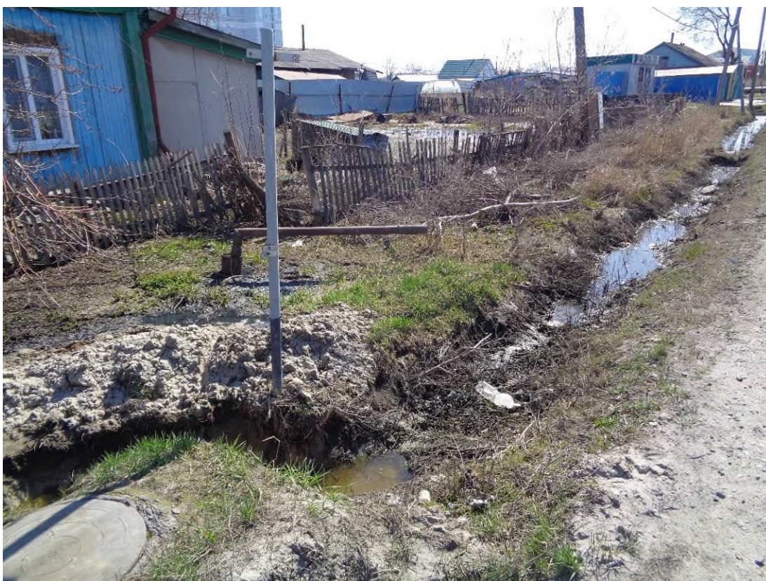
Фото 54-13-00012.б. По ул. Зюнова уровни воды в придорожных канавах находятся на тех же отметках, что и уровни грунтовых вод (около 0,5 м от дневной поверхности). пгт. Чистоозёрное, Чистоозёрный район, Новосибирская область, 26.04.2024
