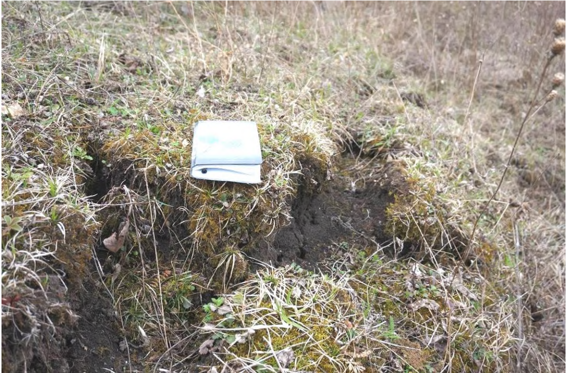
Фото 04-11-00001. Нитевидные трещины в подошве уступа оползня II порядка, с. Майма, Майминский район, Республика Алтай, 23.04.2024
