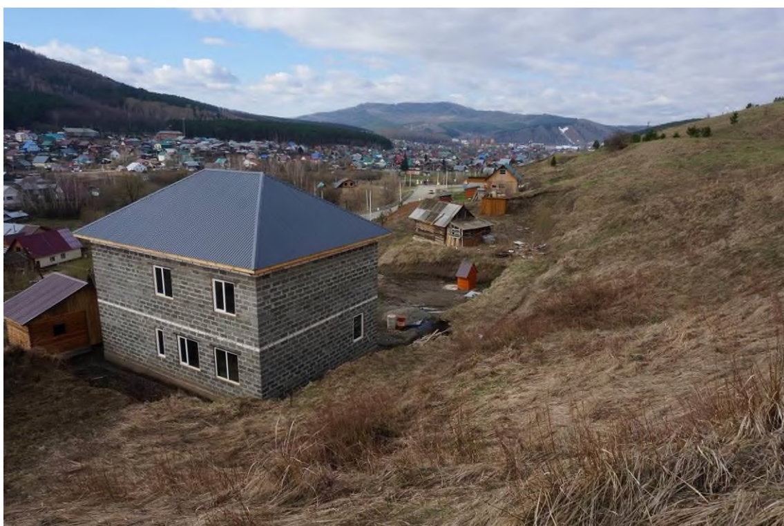
Фото 04-11-00012. Жилые дома расположены на языке древнего оползня по ул. Центральная, № 1, 1А, 1Б, с. Алферово, Майминский район, Республика Алтай, 24.04.2024
