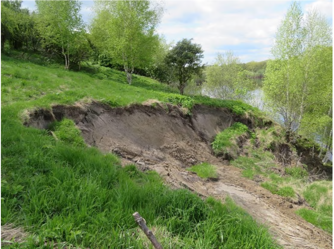
Фото 70-11-00035. Оползневой процесс в с. Подгорное, Чаинский район, Томская область, 07.06.2024
