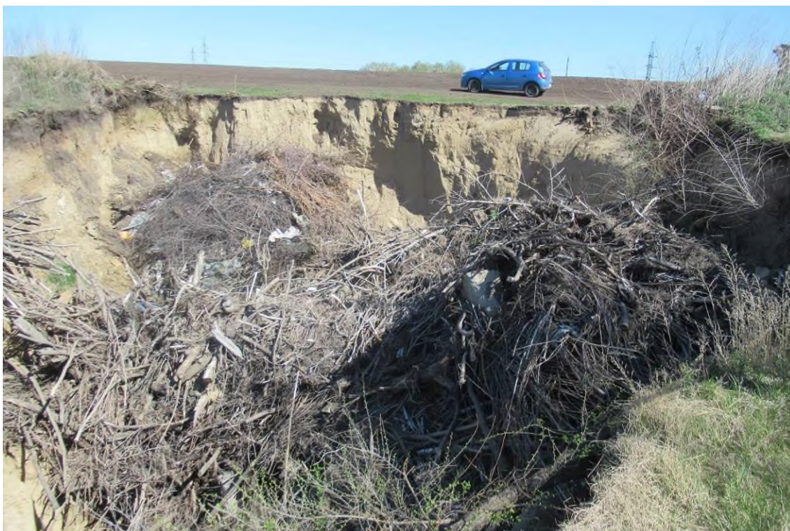
Фото 22-22-00006. Активизация овражной эрозии на склоне надпойменной террасы долины р. Чумыш на пункте Тальменский, овраг № 6, в окрестностях пгт. Тальменка, Тальменский район, Алтайский край, 12.05.2024
