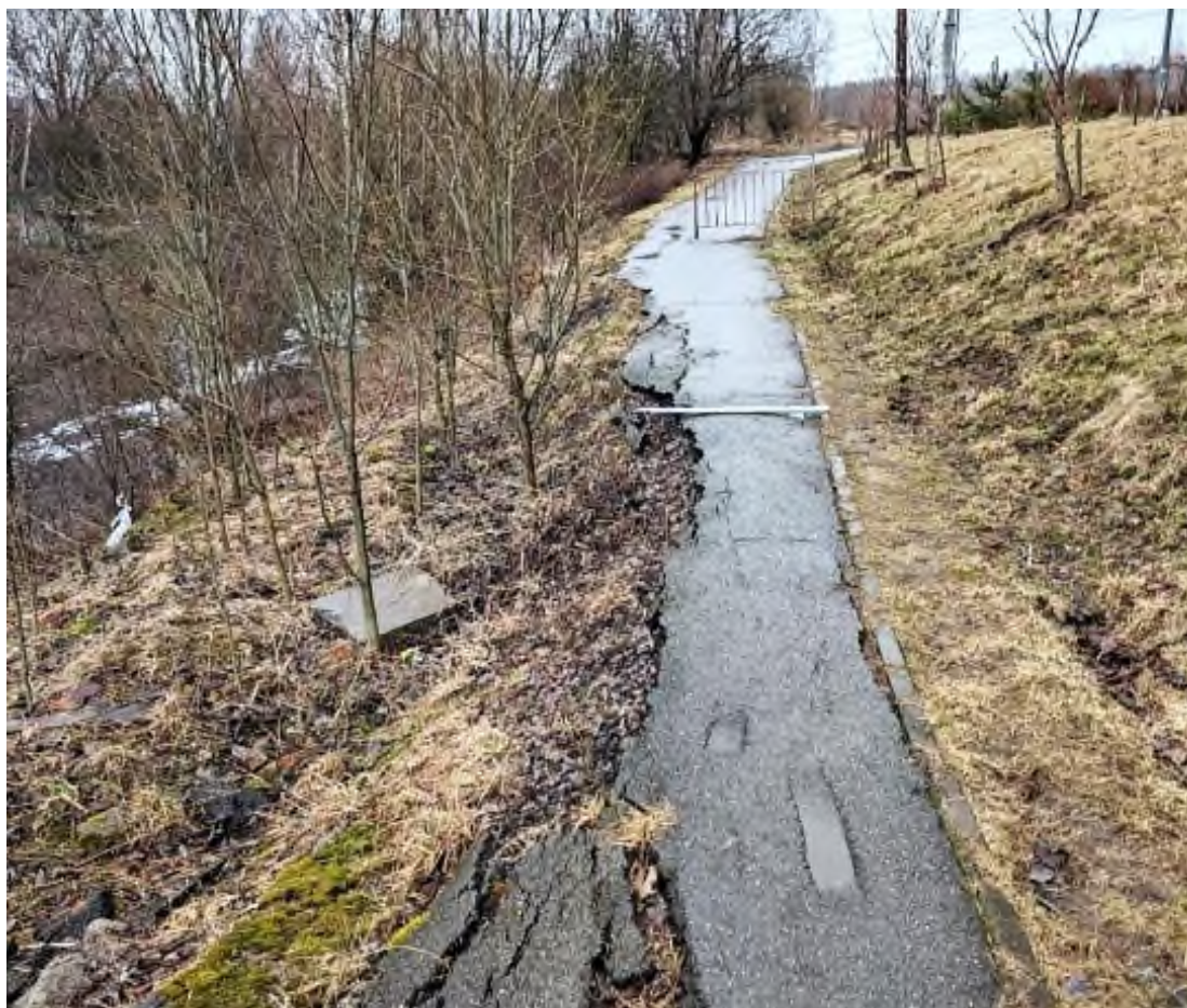
Фото 131. Формирование свежих трещин в асфальтном покрытии и его дробление на куски под воздействием оползневого процесса вблизи д. 7 по 6-й Жерновской ул. (со стороны ЛЭП) Красногвардейского района г. Санкт-Петербурга
