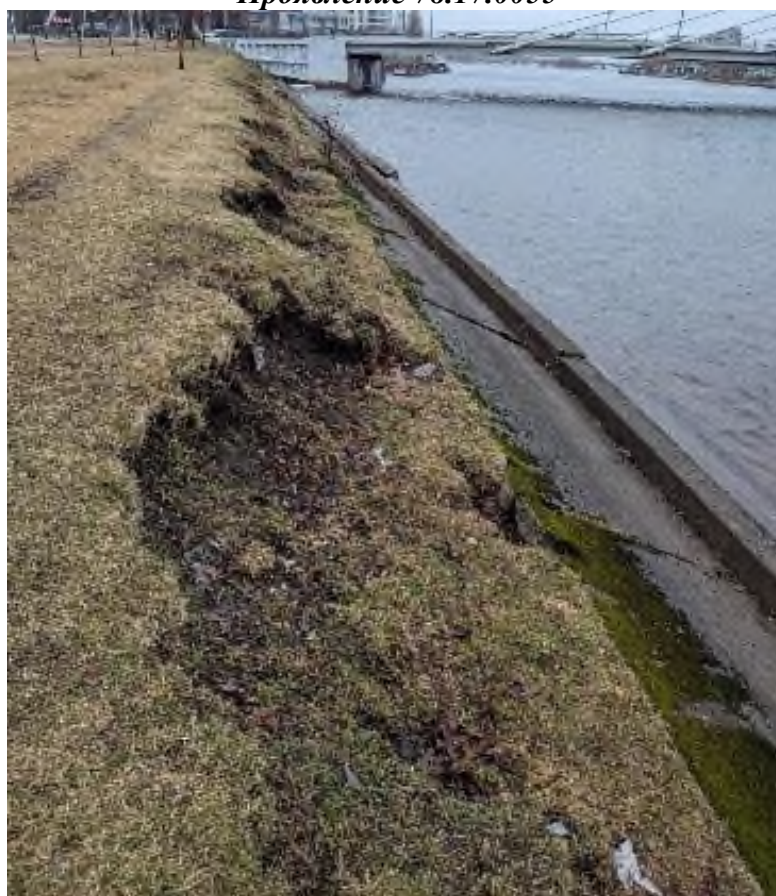
Фото 128. Общий вид на береговой уступ, поражённый суффозионным процессом у д. 24 по набережной Адмирала Лазарева Петроградского района г. Санкт-Петербурга
