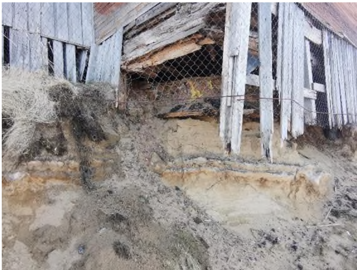
Фото 135. Обрушение берега под жилой постройкой; 13.06.2024 г.
