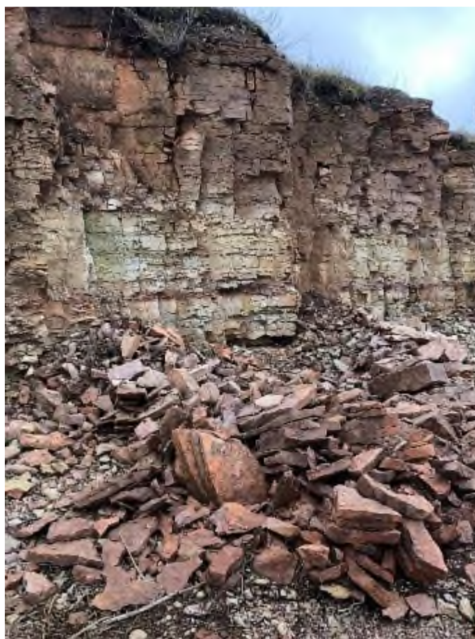
Фото 80. Трещины в теле склона, нависшие блоки известняков, обвалившиеся и осыпавшиеся массы породы на береговом уступе вдоль ул. Набережная в д. Устрека
