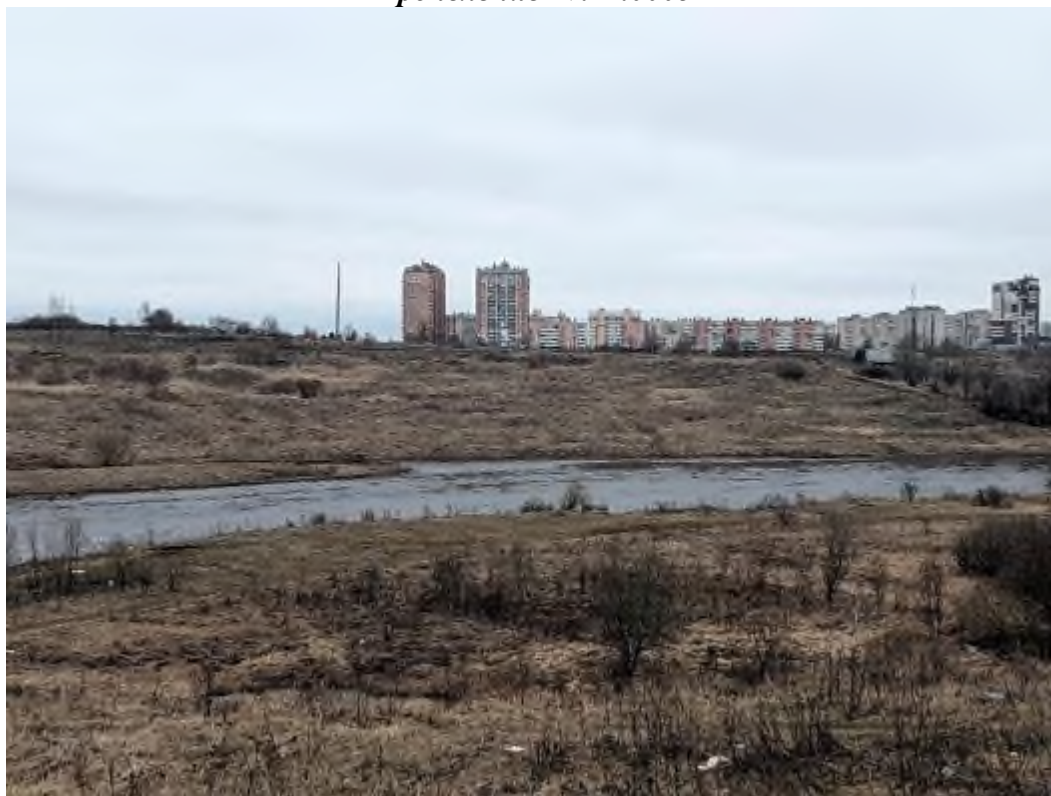
Фото 44. Общий вид на участок оползневой склона со свежей бровкой на левом берегу р. Тосна в г. Никольское Тосненского района Ленинградской области
