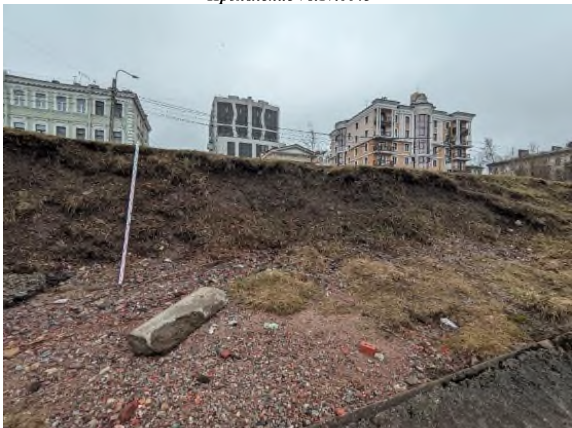
Фото 124. Развитие суффозии над берегоукрепительными сооружениями на набережной Адмирала Лазарева у пересечения с ул. Резной д. 19/8 Петроградского района г. Санкт-Петербурга
