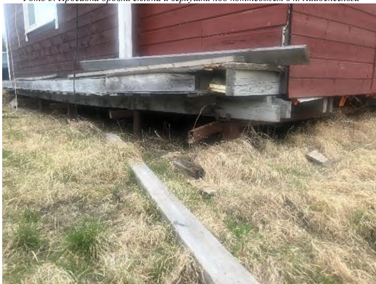
Фото 6. Деформация пола коттеджа в результате просадки верхушки склона в п. Хийденсельга
