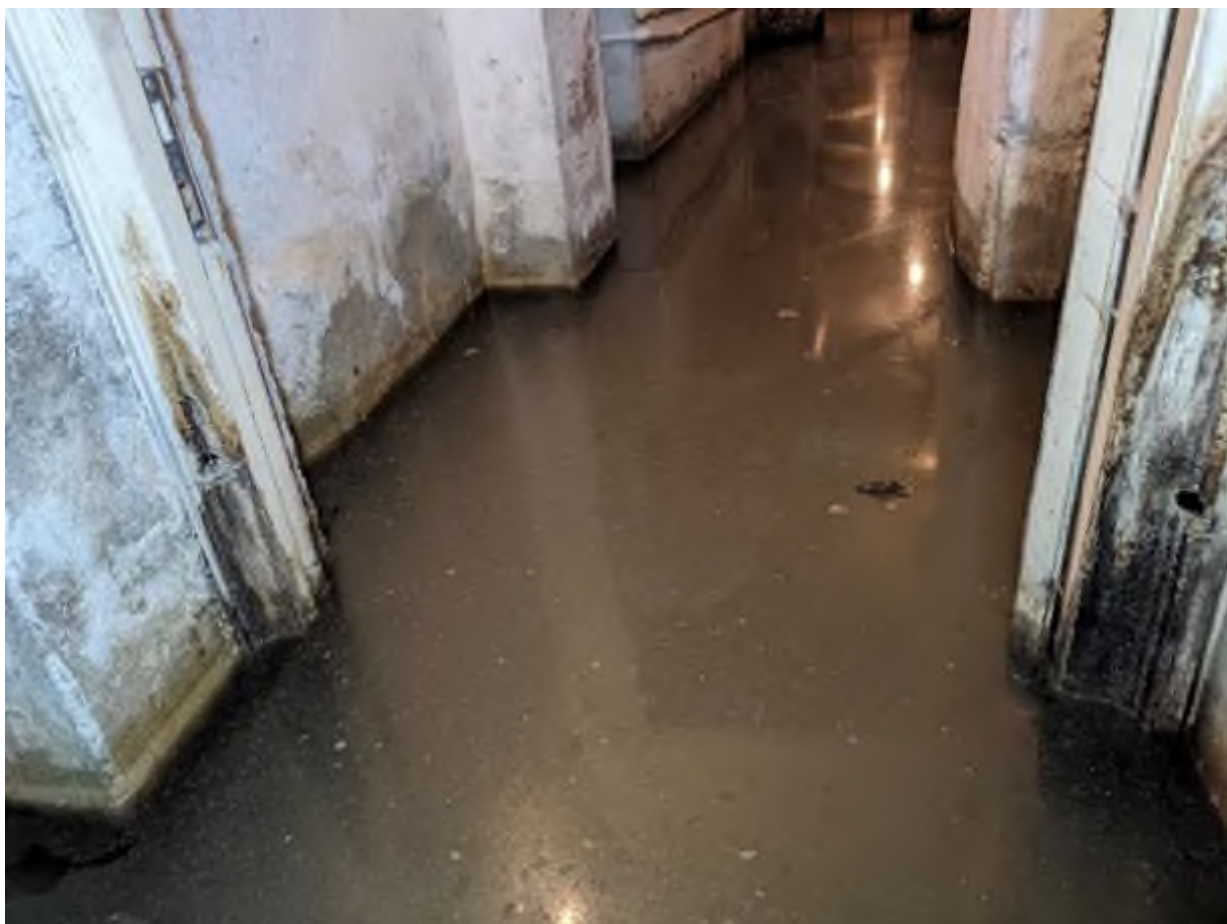
Фото 29. Подтопление подвального помещения д. 25/6 по ул. Ленина на 04.04.2024 г.
