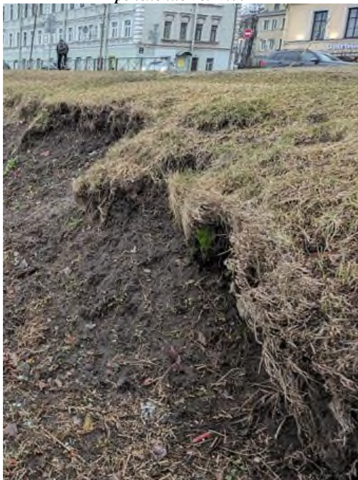
Фото 126. Развитие суффозионного процесса над берегоукрепительными плитами на набережной Адмирала Лазарева, д. 10 Петроградского района г. Санкт-Петербурга
