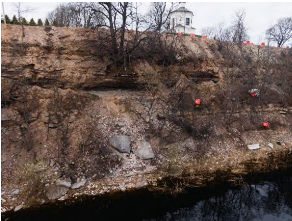
Фото 103. Нависание трещиноватой породы и обвал в т.н. 0078 на склоне «Снетогорский монастырь» в г. Псков
