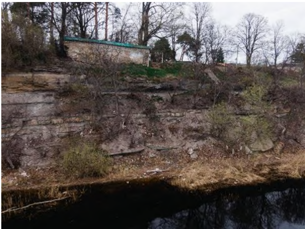
Фото 101. Обвальный склон в т.н. 0076 на участке «Снетогорский монастырь» в г. Псков с частичным разрушением каменной ограды
