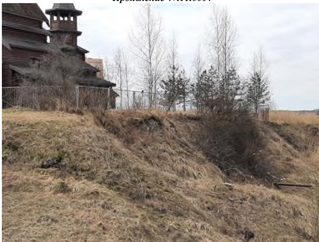
Фото 42. Вид на обрывистый оползневой склон правого берега р. Тосна в месте расположения церкви Царя Николая по ул. Зелёная 7А в г. Никольское Тосненского района Ленинградской области
