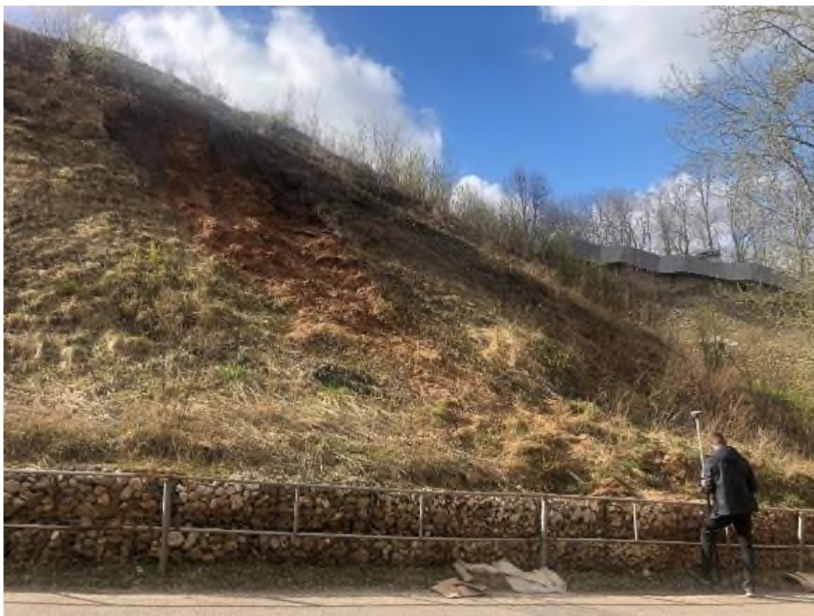
Фото 117. Свежая активизация оползневого процесса в т.н. 2, у восточной стены Псково-Печерского монастыря в г. Печоры
