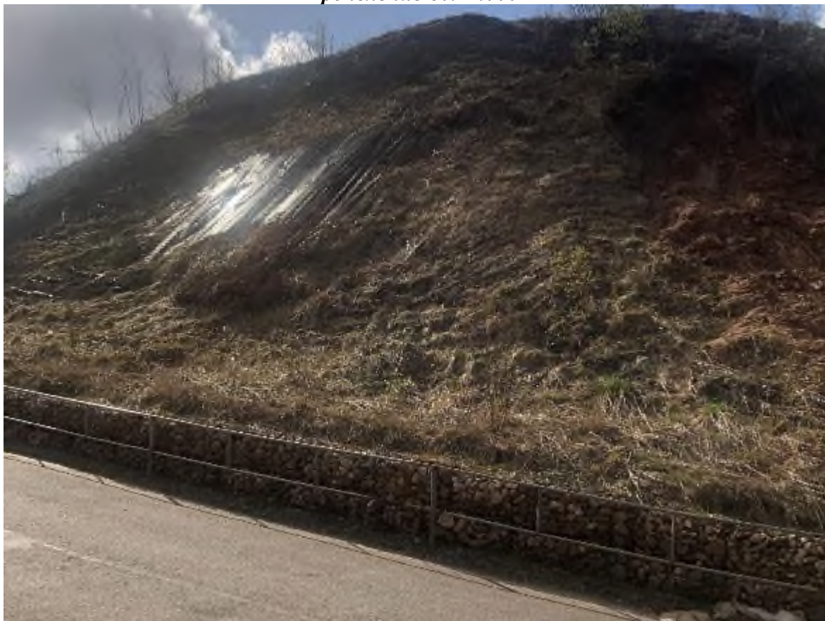
Фото 115. Общий вид на активный оползневой склон в Псково-Печерском монастыре г. Печоры
