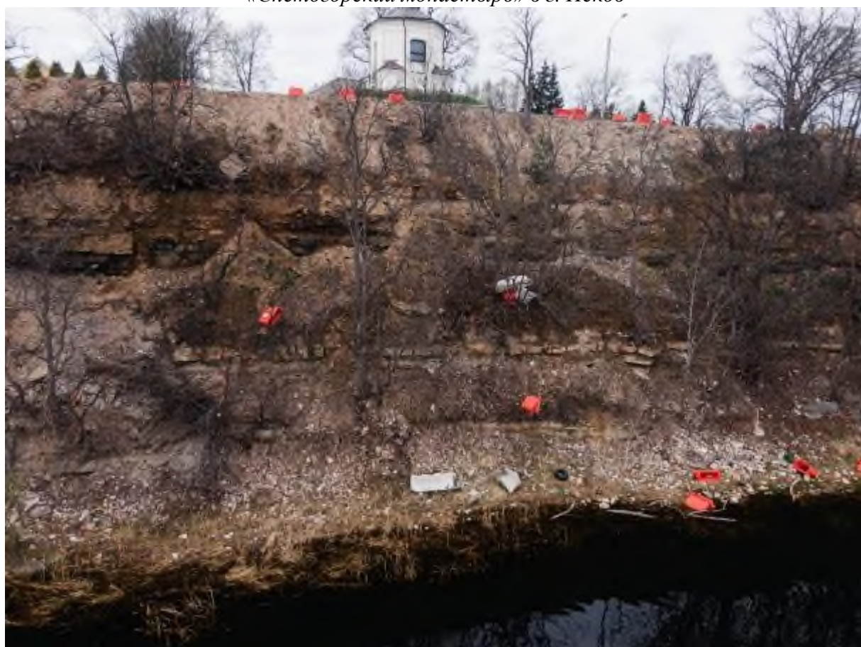
Фото 104. Осыпь в т.н. 0078 на склоне «Снетогорский монастырь» в г. Псков
