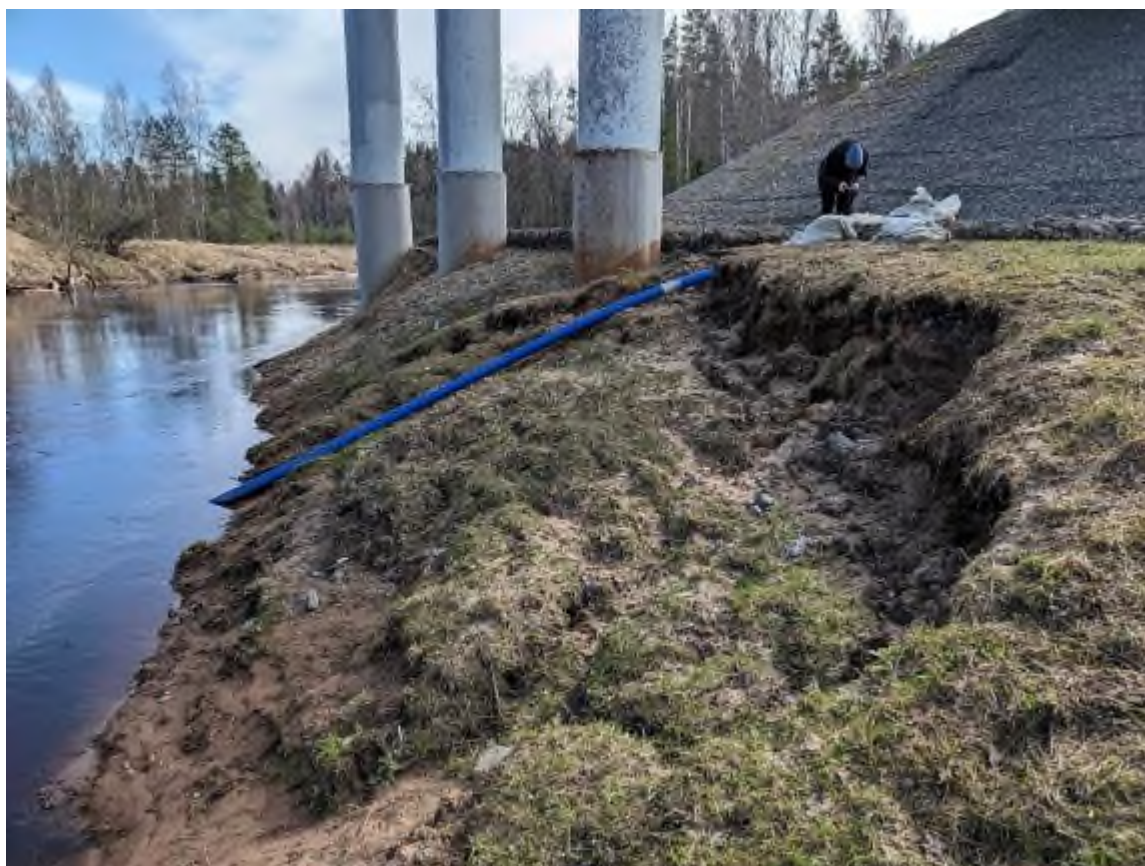
Фото 55. Свежий оползень оседания на левом берегу под мостом через р. Ящера вблизи д. Долговка Лужского района, Ленинградской области
