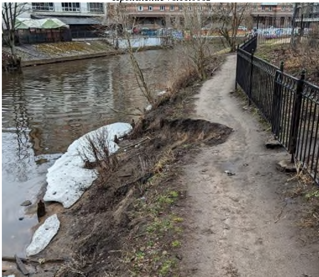
Фото 121. Развитие оползневого процесса на правом берегу р. Смоленка возле кладбища Остров Декабристов в Василеостровском районе г. Санкт-Петербурга.
