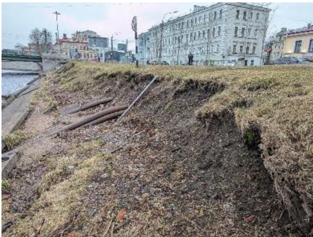
Фото 127. Оголение металлических труб коммуникационных систем и смещение берегоукрепительных конструкций в зоне развития проявления на набережной Адмирала Лазарева Петроградского района г. Санкт-Петербурга
