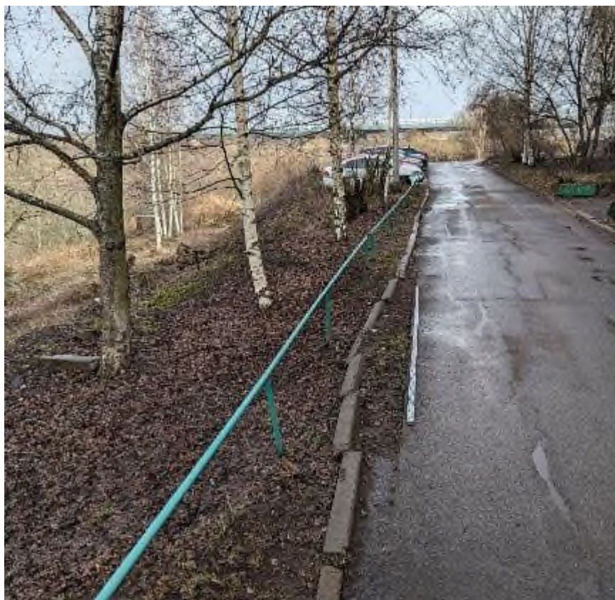
Фото 38. Сползание бетонного поребрика в сторону склона перед д. 6 в пгт. Войсковоро Тосненского района Ленинградской области
