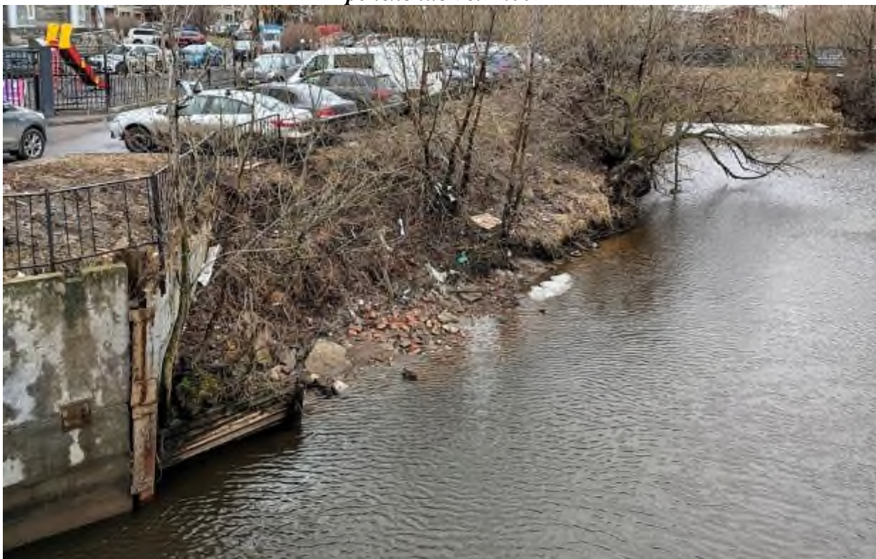
Фото 119. Вид на оползневой склон левого берега реки Смоленки вблизи пешеходного Ново-Андреевского моста в Василеостровском районе г. Санкт-Петербурга
