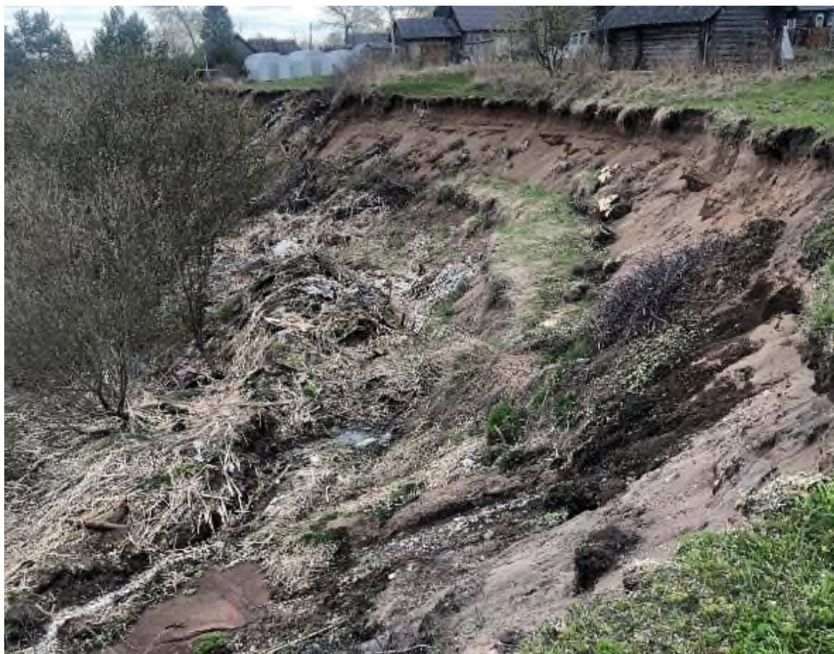
Фото 18. Террасированный оползневой склон в ТН 2, местами оголённый, с покосившимися деревьями, также на склоне отмечаются локальные разгрузки грунтовых вод с незначительными дебитами.
