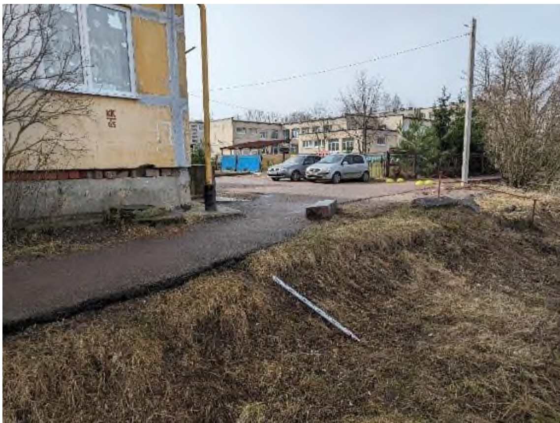
Фото 35. Оползневой уступ в пределах проявления перед д. № 5 в пгт. Войсковоро Тосненского района Ленинградской области
