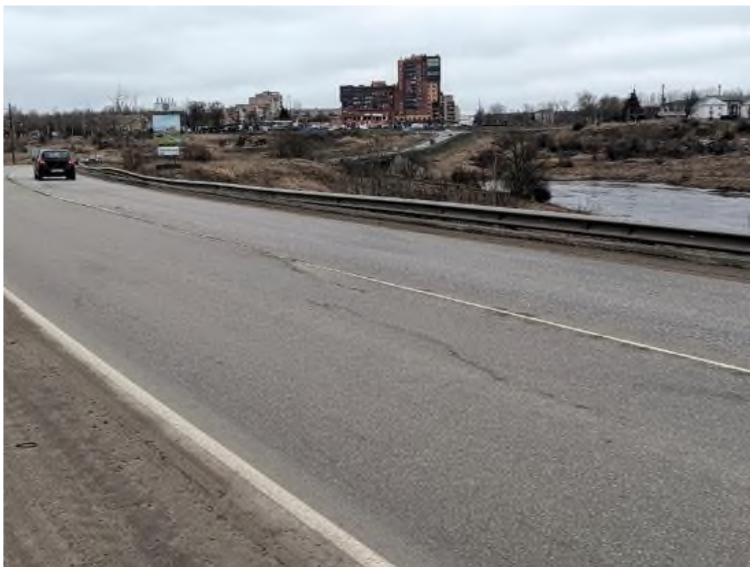
Фото 45. На участке региональной автодороги Ям-Ижора – Никольское в г. Никольское Тосненского района Ленинградской области отмечаются трещины в асфальте дорожного полотна
