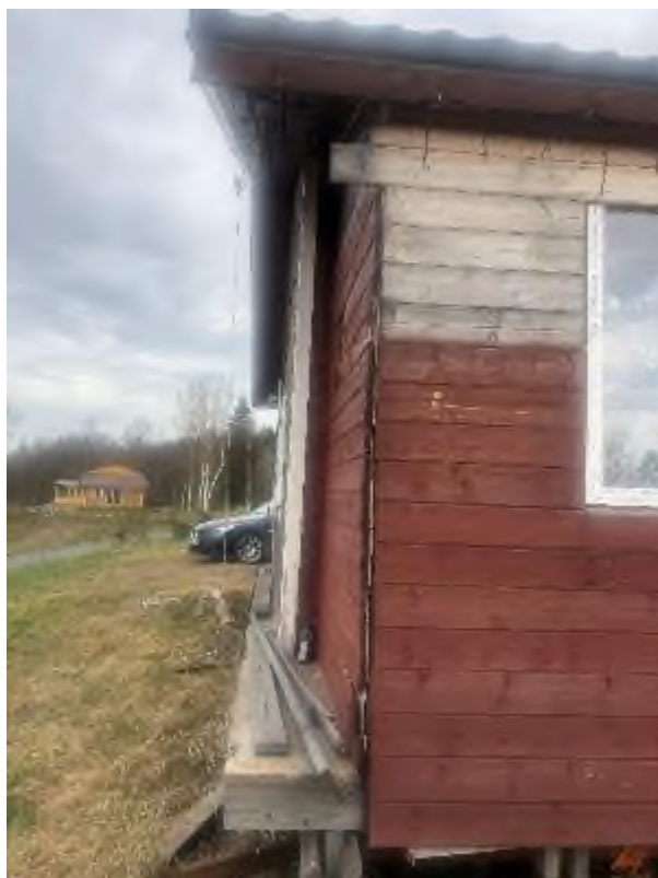
Фото 7. Деформация стен коттеджа в результате просадки вершины склона в п. Хийденсельга
