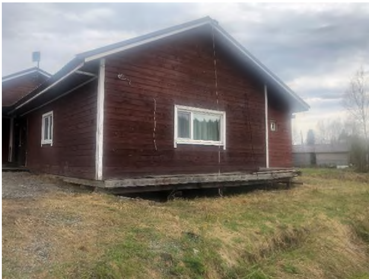
Фото 5. Просадка бровки склона и верхушки под коттеджем в п. Хийденсельга
