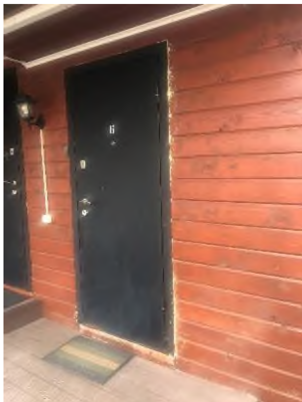
Фото 8. Деформация дверного проёма коттеджа в результате просадки вершины склона в п. Хийденсельга
