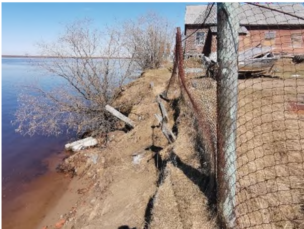
Фото 138. Обрушение берега вдоль забора у жилой постройки, 13.06.2024 г.
