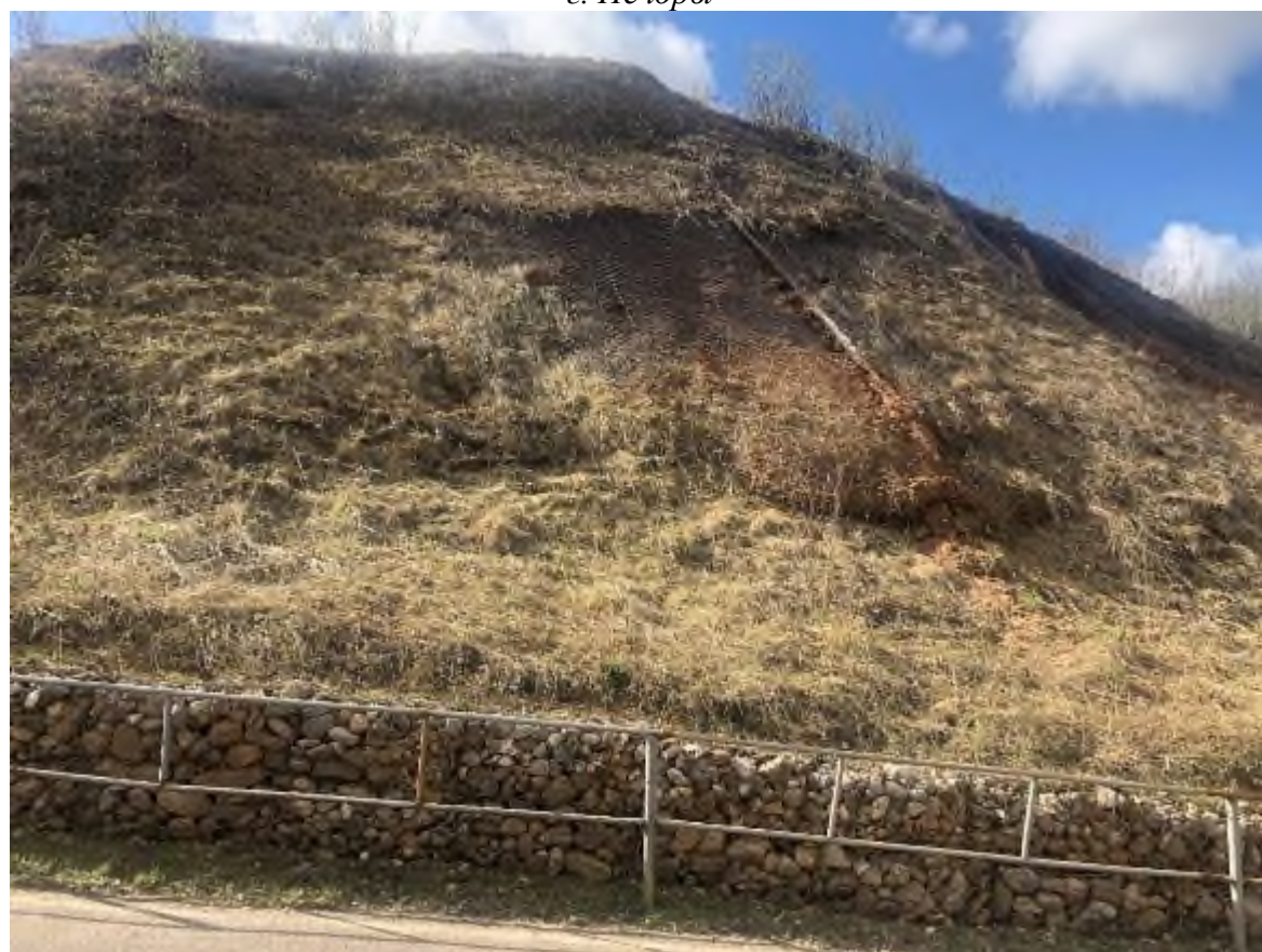
Фото 116. Свежая активизация оползневого процесса под геосеткой в т.н. 3, у восточной стены Псково-Печерского монастыря в г. Печоры
