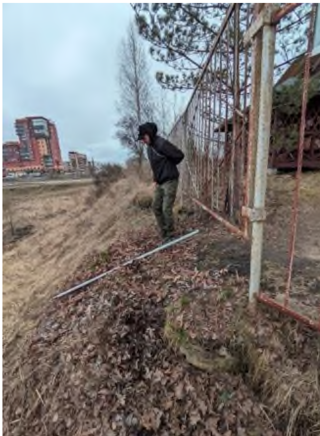
Фото 43. Расположение ограждения территории церкви Царя Николая по ул. Зелёная 7А в г. Никольское Тосненского района Ленинградской области на бровке отрыва оползневых масс и оголение бетонного основания опор
