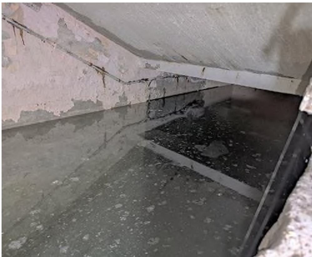
Фото 32. Полностью затопленный подвал Сланцевской швейной фабрики, г. Сланцы, ул. Баранова, д. 20
