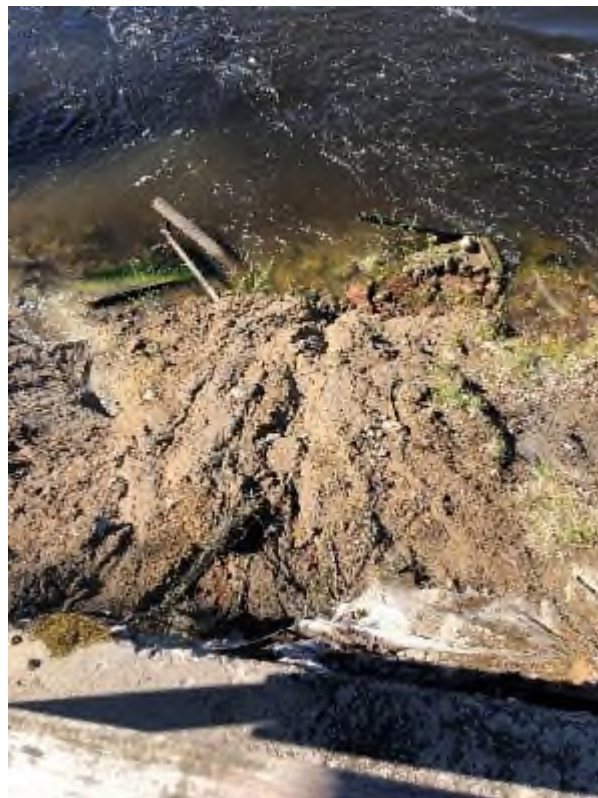
Фото 70. Свежие оползневые массы у подножия склона правого берега через р. Вуокса на участке «Лосевский порог» Ромашкинского СП, Приозерского района, Ленинградской области, 17.05.2024 г
