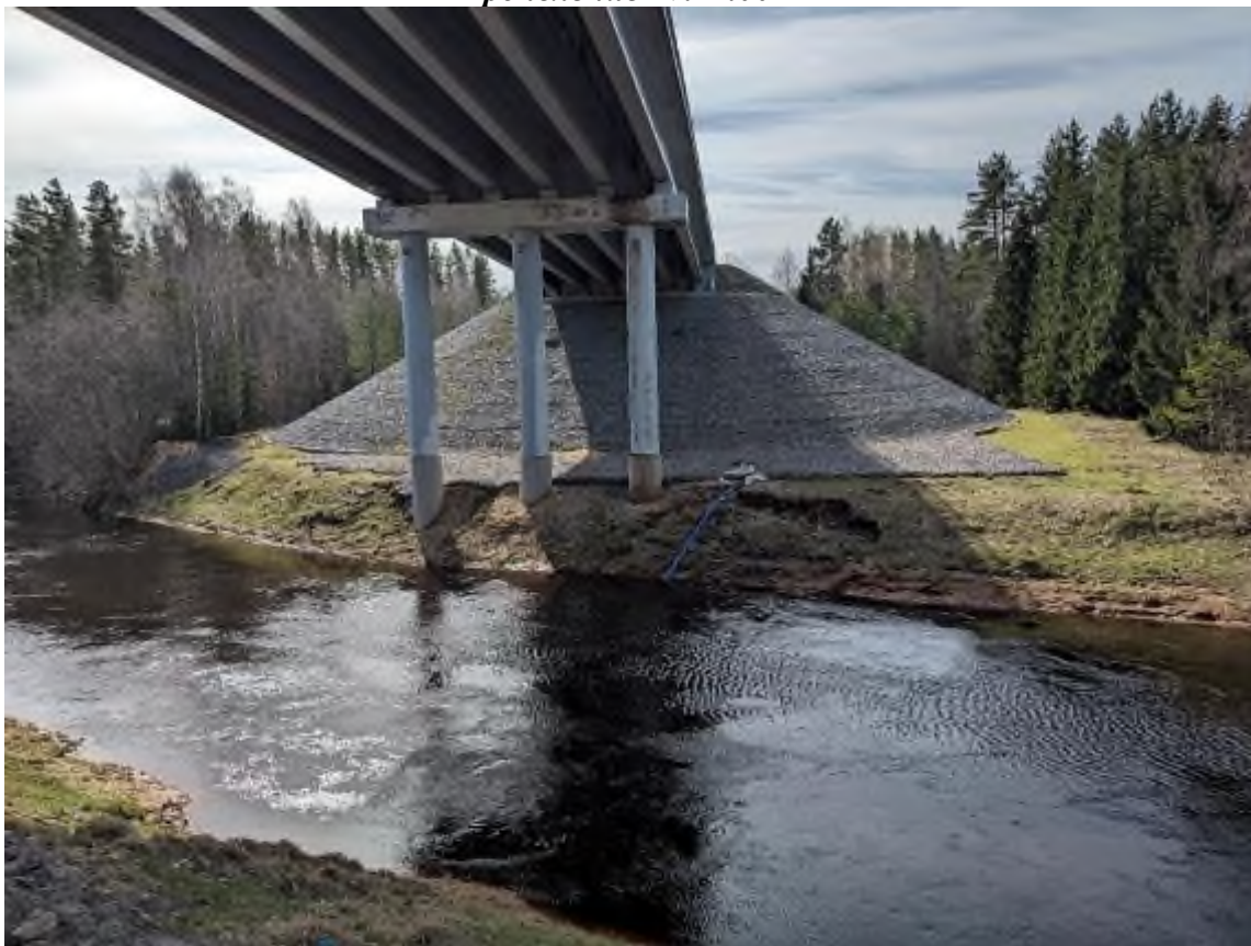
Фото 54. Вид на проявление оползневого процесса на левом берегу под мостом через р. Ящера вблизи д. Долговка Лужского района, Ленинградской области
