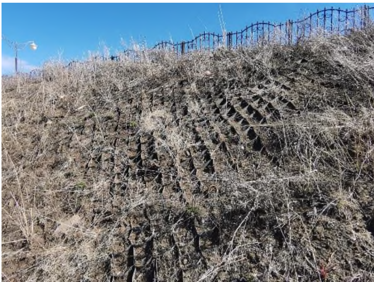
Фото 139. Оползание заново отсыпанных в 2022 г берегоукрепительных конструкций; 13.06.2024 г.
