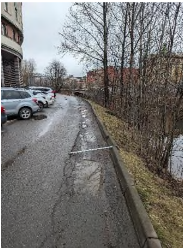
Фото 123. Деформированная часть асфальтового покрытия, воздействие оползневого процесса на поребрик и парковочную зону на оползневом склоне набережной реки Смоленки, д. 33
