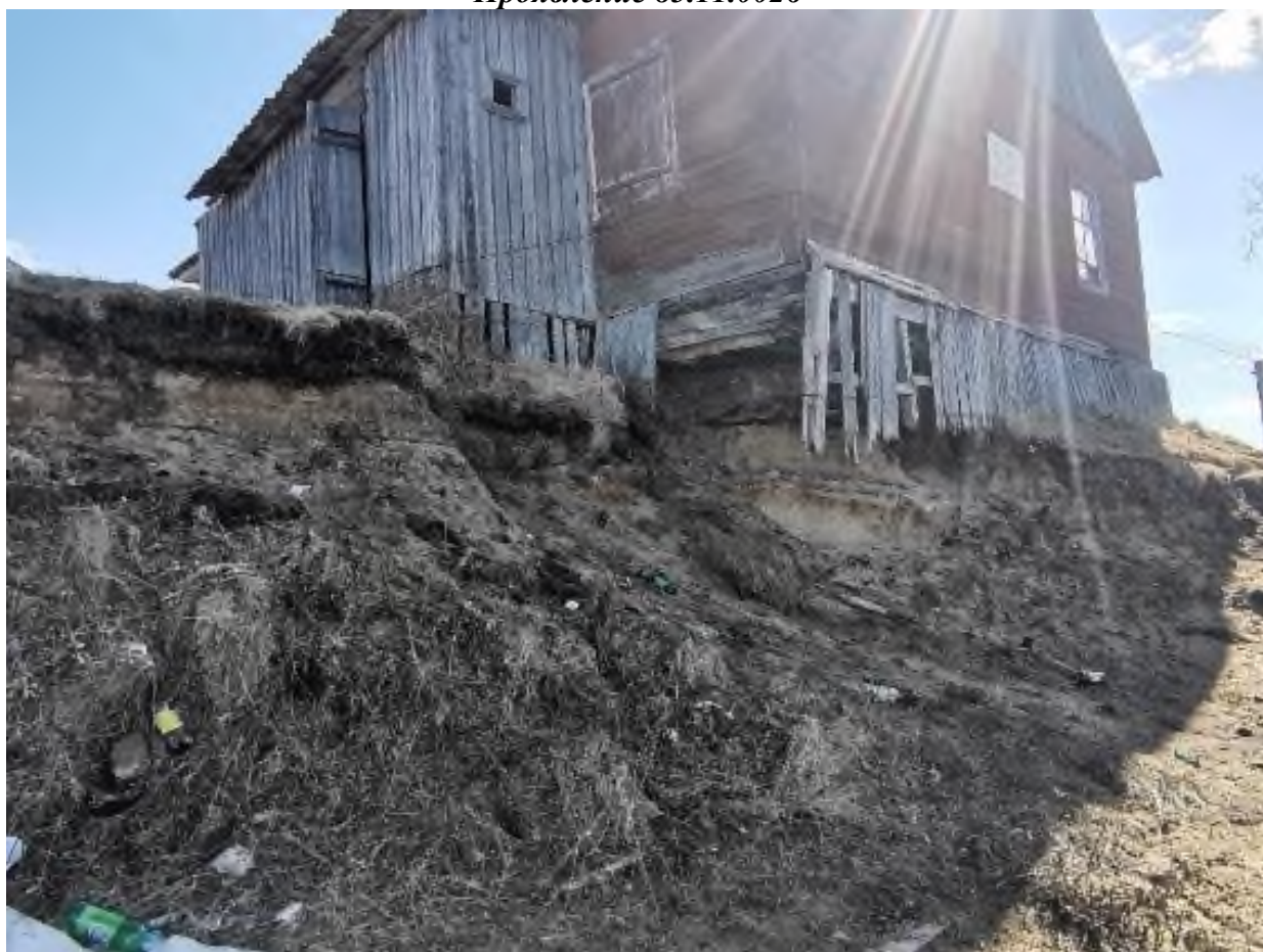
Фото 134. Обрушение берега под жилой постройкой, 13.06.2024
