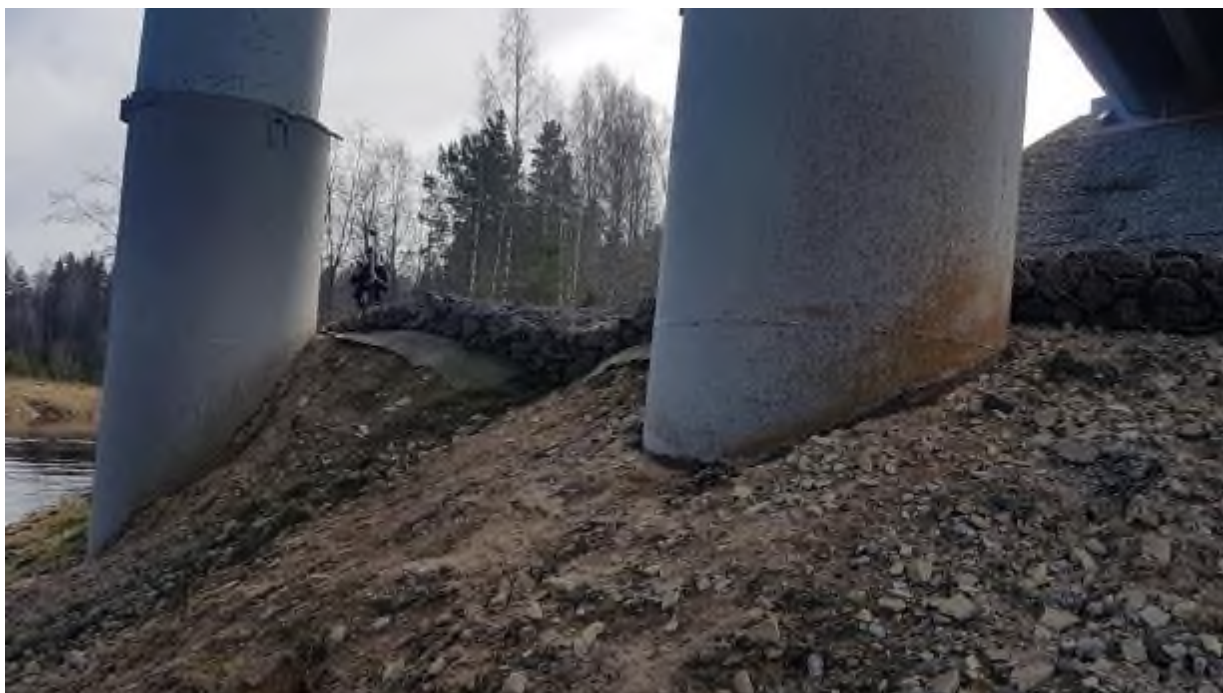
Фото 56. Проседание и выпучивание грунта и габиона непосредственно у опоры моста через р. Яцера (левый берег) вблизи д. Долговка Лужского района, Ленинградской области
