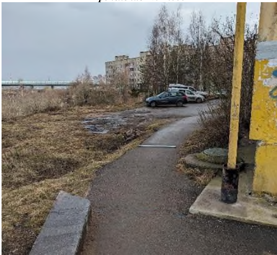
Фото 34. Бровка отрыва оползневого тела проявления и восстановленное асфальтное полотно с угловой части д. № 5 в пгт. Войскорово Тосненского района Ленинградской области
