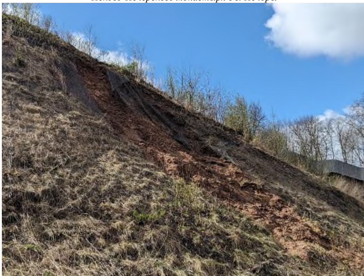
Фото 118. Полный разрыв остатков укрывающего защитного полотна в месте повторной активизации оползневого процесса в т.н. 2, у восточной стены Псково-Печерского монастыря в г. Печоры
