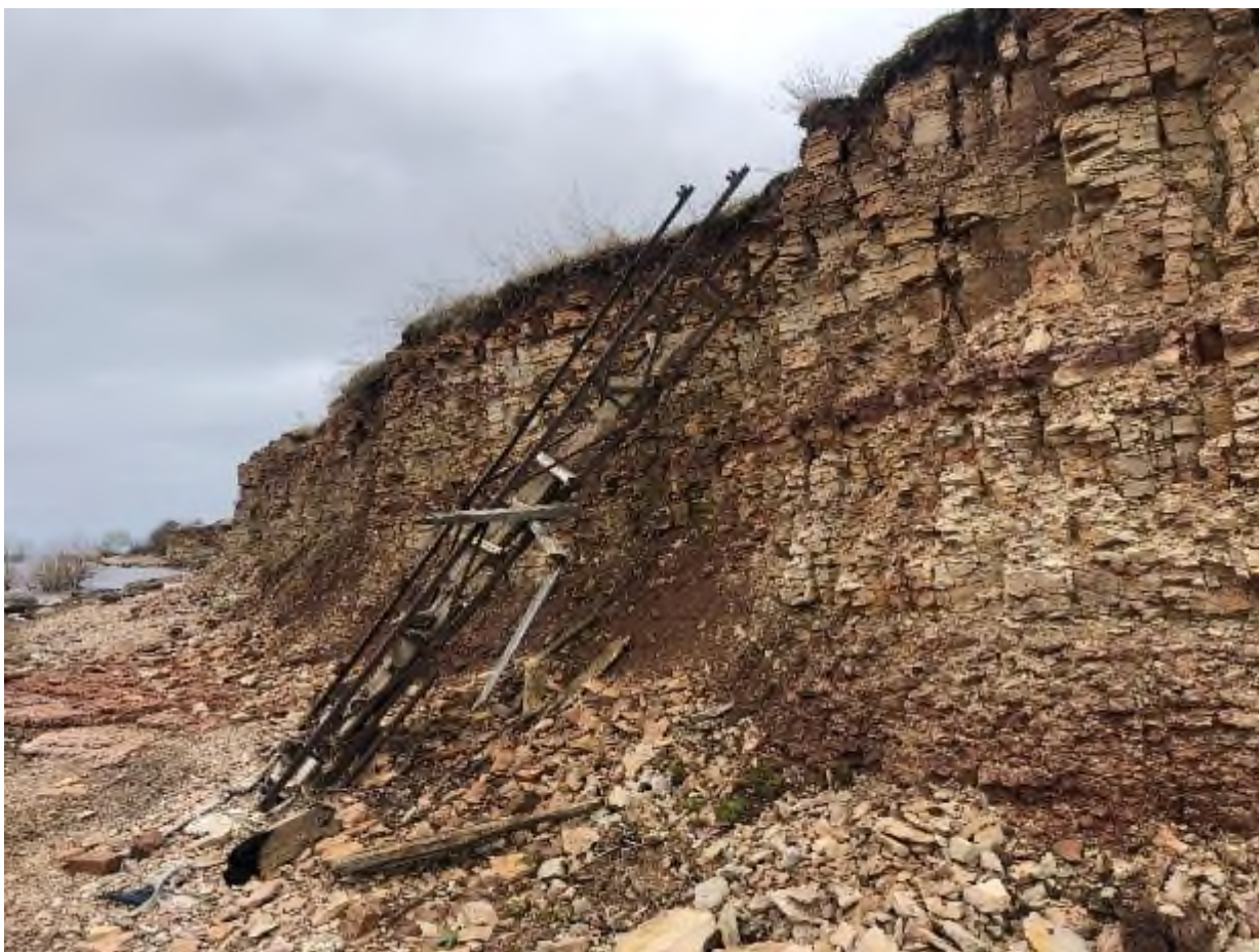
Фото 81. Деформация спусковых лестниц на береговом склоне вдоль ул. Набережная в д. Устрека
