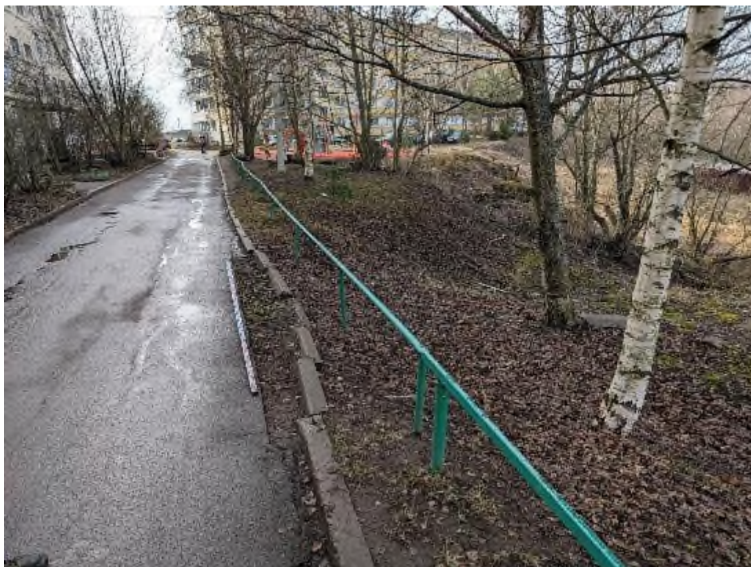
Фото 39. Расположение бровки отрыва непосредственно у проезжей части дороги перед домом № 6 в пгт. Войсковорово Тосненского района Ленинградской области
