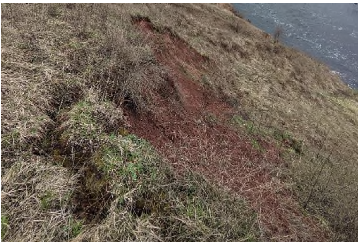
Фото 78. Свежие оголения на склоне, бровка отрыва с оползающими островками ПРС, небольшие оплывины из грунта и растительного слоя, 17.04.24 г.
