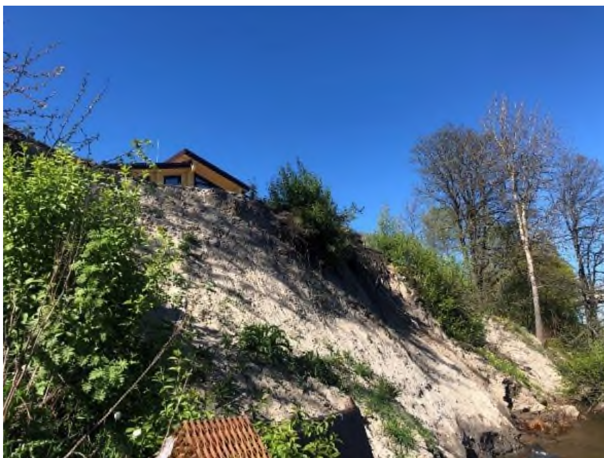
Фото 72. Общий вид на проявление оползневого процесса левого берега у моста «Лосевский порог» через р. Вуокса между д.д. Лосево и Варишко, Ромашкинского СП, Приозерского района, Ленинградской области, 17.05.2024 г.
