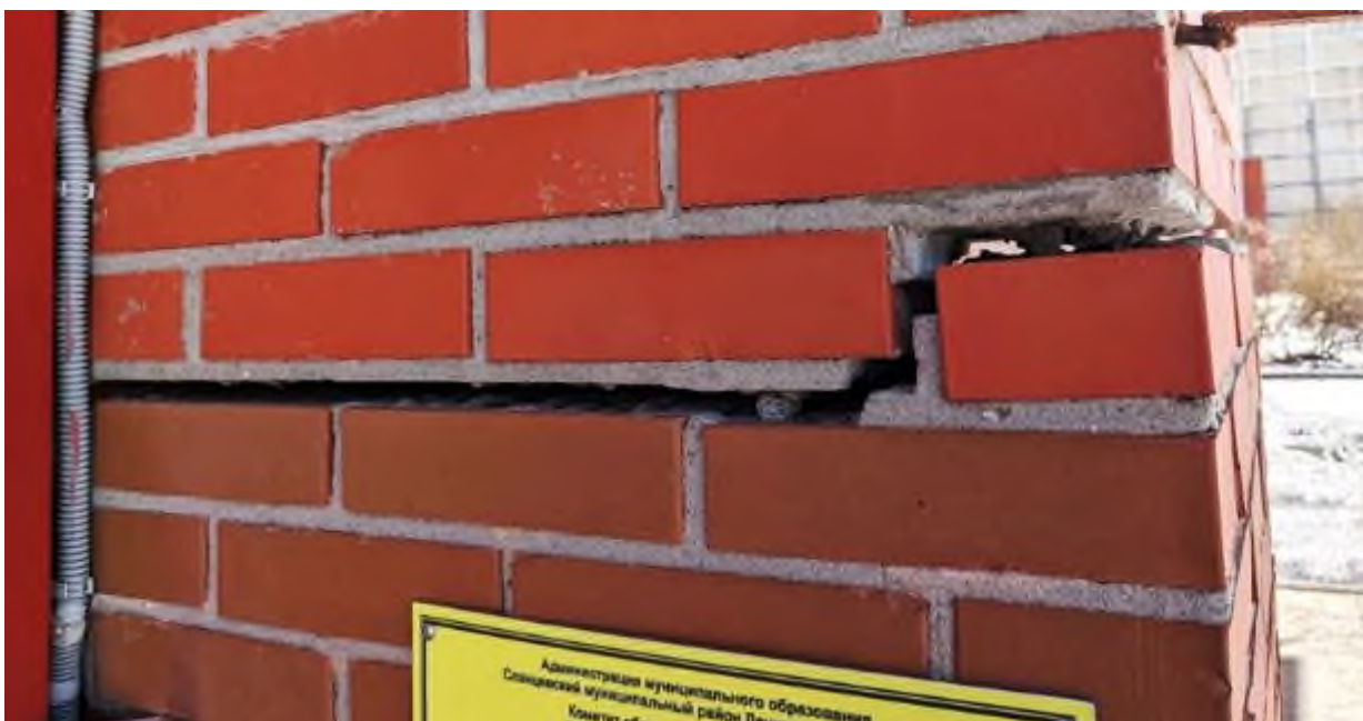
Фото 30. Трещина на фасаде у входа в художественную школу д. 25/6 по ул. Ленина на 04.04.2024 г.
