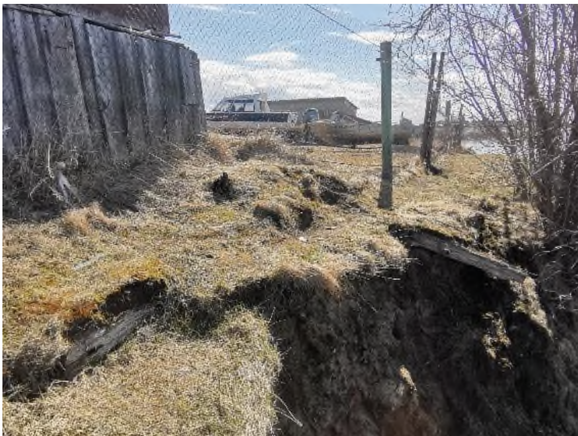
Фото 137. Обрушение берега вдоль забора у жилой постройки, 13.06.2024 г.
