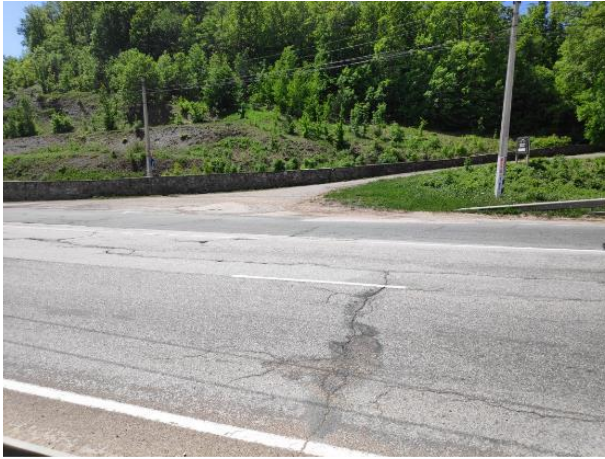
Фото 91-11-04702 Оползень № 266, средняя часть, правый борт. Трещины на асфальте а/д 35 ОП РЗ 35А-002.
