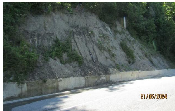
Фото 23-11-00495. Высачивание родников в теле оползня. МО город-курорт Сочи, Адлерский район, к северу от с. Хлебороб, участок дороги 03К-452. Фото ФГБУ «Гидроспецгеология». Дата съемки 21.05.2024.
