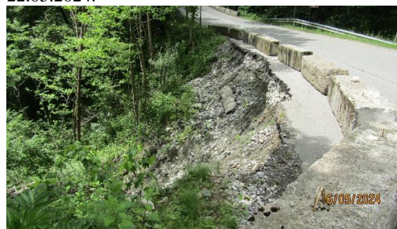
Фото 23-11-00597. Активный оползневой очаг в низовом откосе автодороги. МО город-курорт Сочи, Лазаревский район, автодорога 03К-466. Фото ФГБУ «Гидроспецгеология». Дата съемки 16.05.2024.
