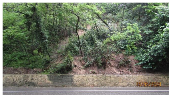
Фото 23-11-00350. Активное оползневое проявление в верхом откосе дороги А-147. МО город-курорт Сочи, Лазаревский район, 139-й км трассы А-147, между мкр. Головинка и мкр. Якорная Щель. Фото ФГБУ «Гидроспецгеология». Дата съемки 15.05.2024.
