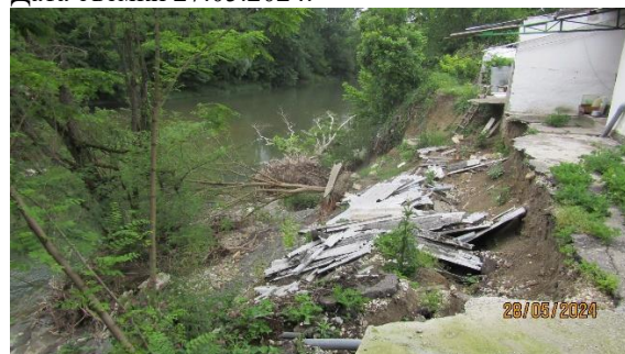
Фото 23.11.00167. Разрушение территории домовладения №20 по пер.Рыбному в г.Хадыженске Фото ЮРЦ ГМСН «Гидроспецгеология» Дата съемки 28.05.2024.
