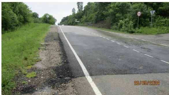
Фото 23.11.00225. Оползневые деформации дорожного покрытия на автодороге по ул.Ленина в п.Кутаис (дорога отремонтирована) Фото ЮРЦ ГМСН «Гидроспецгеология» Дата съемки 28.05.2024.
