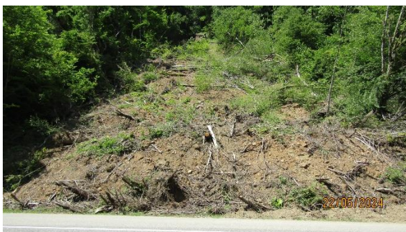
Фото 23-11-00599. Вид на оползень в верховом откосе дороги А-149. МО город-курорт Сочи, Адлерский район, 39-й км автодороги А-149. Юго-западная часть пос. Красная поляна, ул. Водопадная. Фото ФГБУ «Гидроспецгеология». Дата съемки 22.05.2024
