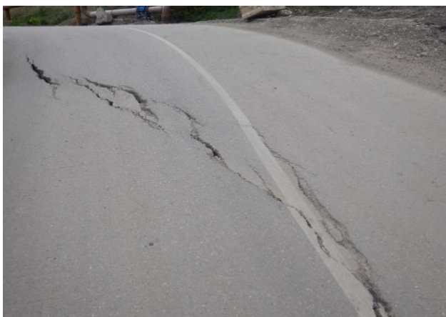
Фото 91-11-02801 Деформация асфальтового покрытия автодороги в районе правого борта оползневой ступени Фасбурлинской ветви.
