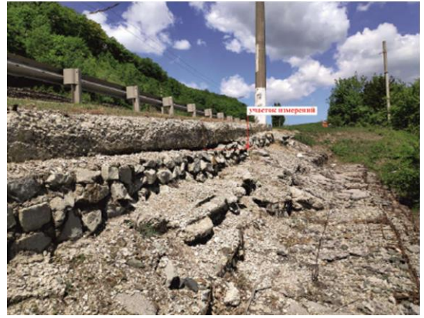
Фото 91-11-04803 Оползень № 877, головная часть, у автодороги 35 ОП РЗ 35А-002. Деформации сооружений габионного типа
