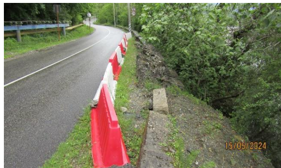
Фото 23-11-00611. Активизация оползневой процесса в низовом откосе дороги. МО город-курорт Сочи, Лазаревский район, автодорога 03К-446 между мкр. Головинка и а. Большой Кичмай. Фото ФГБУ «Гидроспецгеология».
