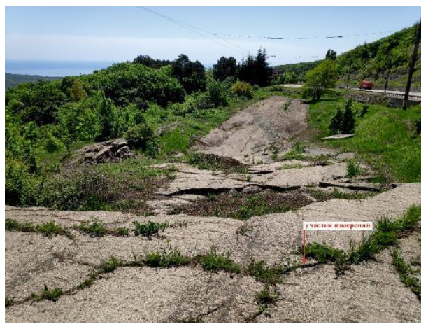
Фото 91-11-04701. Оползень № 247, головная часть, левый борт. Трещины на старом неэксплуатируемом участке а/д
