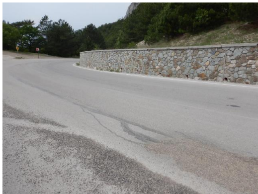
Фото 91-11-01401 Деформации асфальтового покрытия в районе правого борта оползня № 16 Черный бугор
