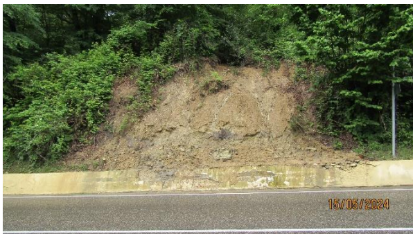
Фото 23-11-00590. Активизация оползневой процесса в верхнем откосе дороги А-147. МО город-курорт Сочи, Лазаревский район, 138-й км трассы А-147, между мкр. Головинка и мкр. Якорная Щель. Фото ФГБУ «Гидроспецгеология».
