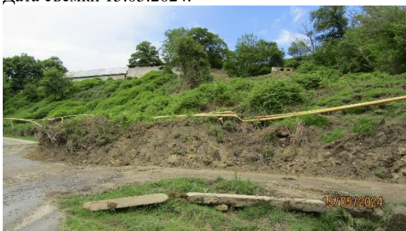
Фото 23-11-00370. Активизация оползневой процесса по ул. Бюроканская. МО город-курорт Сочи, Лазаревский район, с. Детляжка, ул. Бюроканская в районе дома №54. Фото ФГБУ «Гидроспецгеология».
