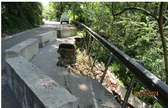
Фото 23-11-00482. Разрушение дороги оползневым процессом. МО город-курорт Сочи, Хостинский район, мкр. Малый Ахун, ул. Дорога на Большой Ахун. Фото ФГБУ «Гидроспецгеология». Дата съемки 20.05.2024.
