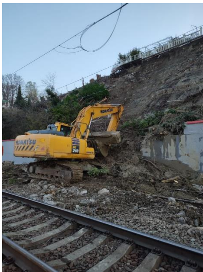
Фото 23-11-00610. Активизация оползневой процесса на участке железной дороги Дагомыс-Мамайка. МО город-курорт Сочи, Центральный район, мкрн. Мамайка. Фото из открытых источников СМИ.
