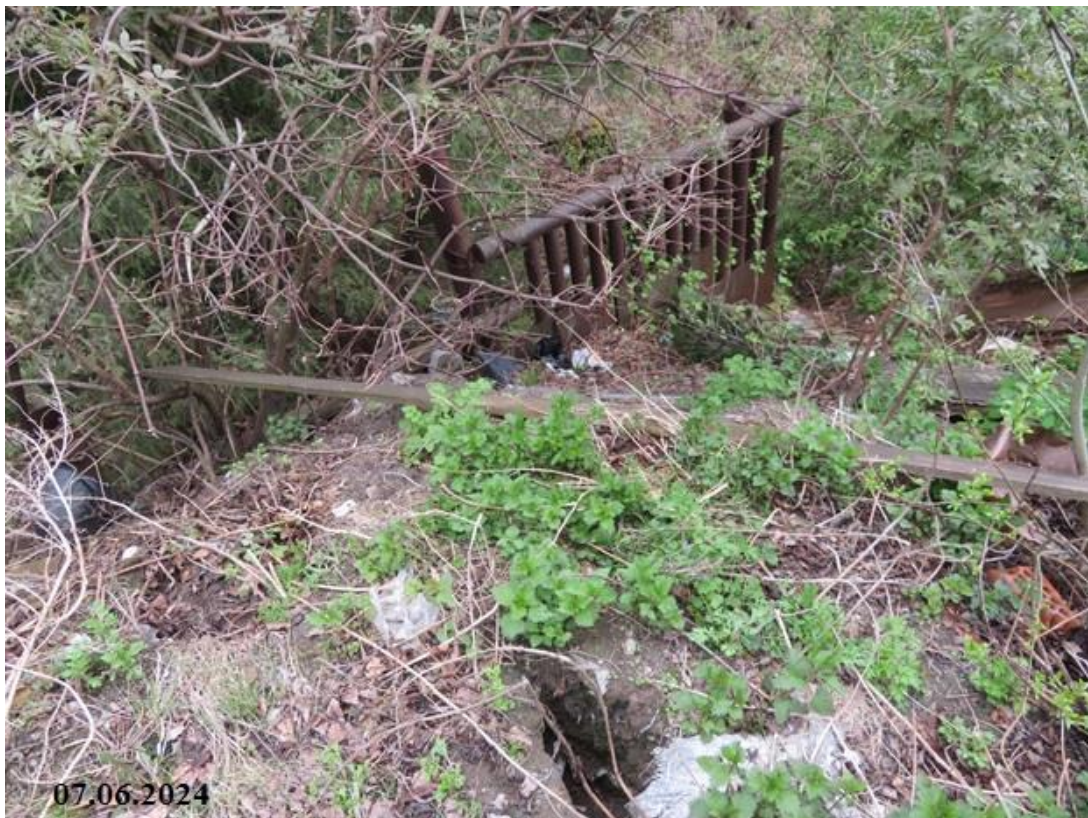
Фото 86-1210-0001. Проявление оползневых процессов, Ханты-Мансийск, Садовая 1. Оползневой обрыв на борту оврага. Деформированная подпорная стенка жилого дома с торца здания. ХМАО-Югра
