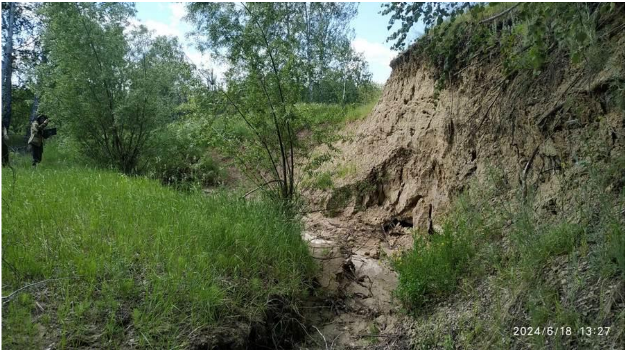
Фото 72-22-00332. Участок развития процесса овражной эрозии. Марковский участок, Тюменская область
