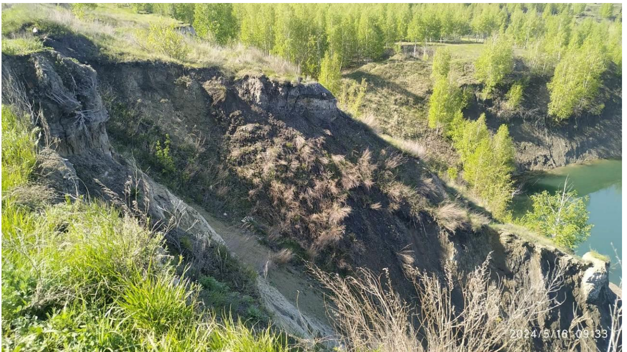
Фото 74-11-00226. Обрушение борта в ТН 21б. Участок Копейский, Челябинская область
