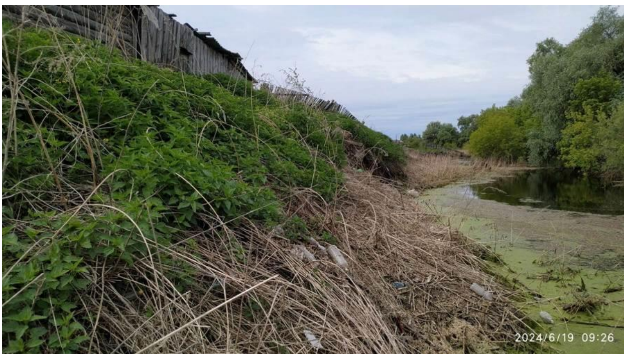
Фото 72-2024-01-001-3. Оползневой процесс ул. Советская д 23. Участок д. Черная, Тюменская область
