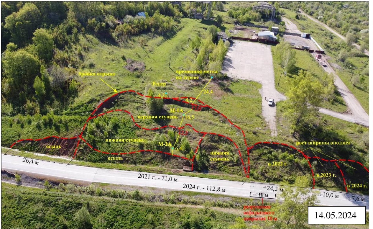
Фото 74-11-00048. Техногенный оползень по автодороге на горнолыжный комплекс Аджигардак. Участок Ашинский, г. Аша, Челябинская область
