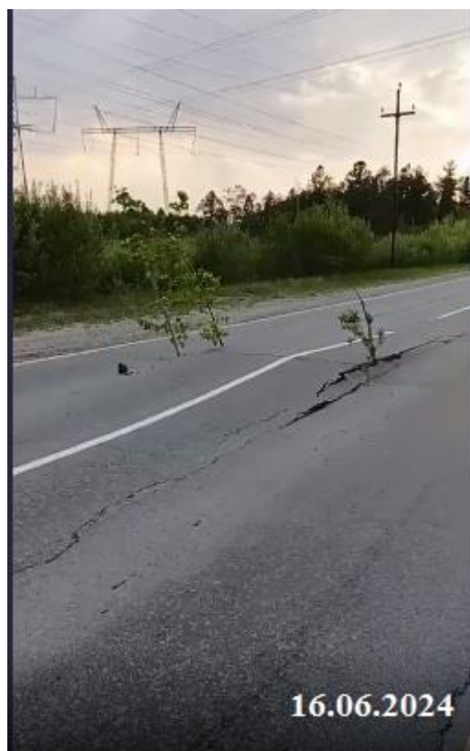
Фото 1. Сургутский район, деформация автодороги Сургут-пос. Сайгатино 16.06.24 г. (Скрин видео с интернет СМИ «Muksun»). ХМАО-Югра
