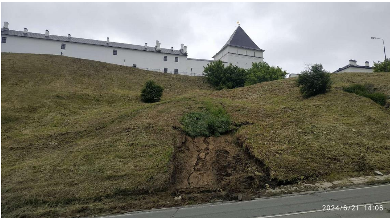
Фото 72-1210-0001-14. Оползание склона Тобольского кремля. Тюменская область
