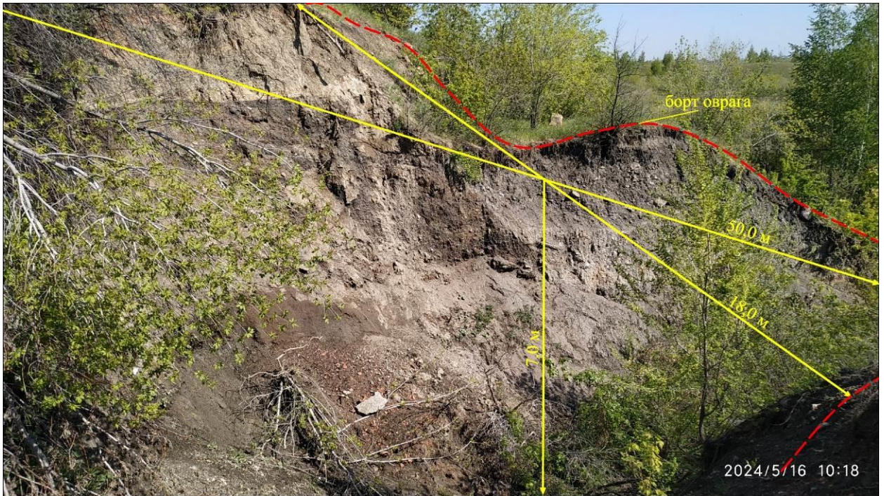
Фото 74-22-00043. Техногенный овраг на борту Копейского карьера. Участок Копейский, Челябинская область
