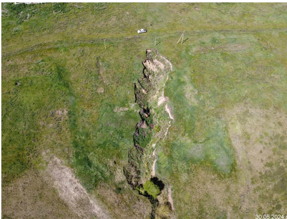
Фото 45-22-00012. Активный овраг ~330 м северо-восточнее автодороги на въезде в с. Ярославское. Раскатихинский участок, Притобольный район, Курганская область
