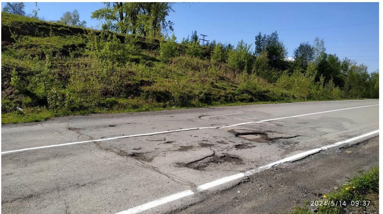
Фото 74-11-00048. Разрушение оползневым процессом асфальтового покрытия автодороги на горнолыжный комплекс Аджигардак. Участок Ашинский, г. Аша, Челябинская область
