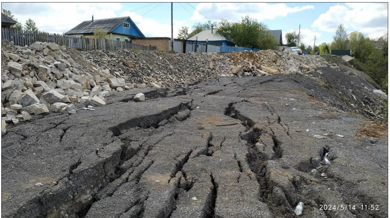
Фото 74-11-00052. Трещины в оползающем грунте по ул. Набережная, в г. Аша. Участок Ашинский, Челябинская область
