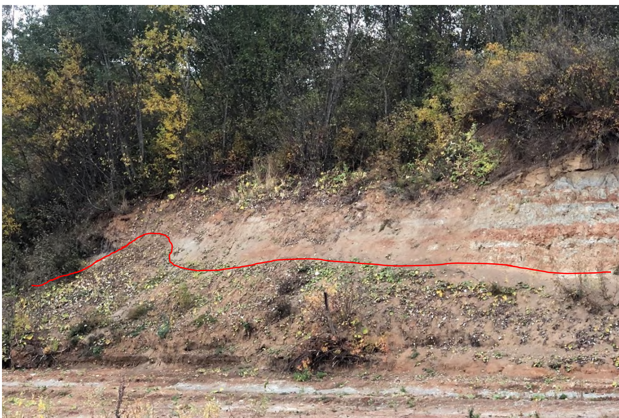
Фото 41, 42. Оползневые массы у подножия склона д. Заовражье, ТН 5, по состоянию на 2023 г. (вверху) и 2024 г. (внизу)
