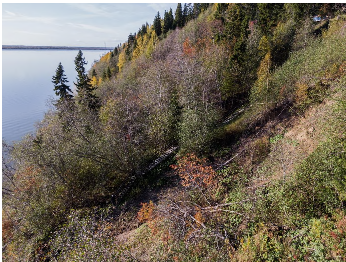
Фото 62, 63. Воздействие процесса на деревянную лестницу в посёлке Боброво на территории Базы отдыха Мостострой, ТН 4.
