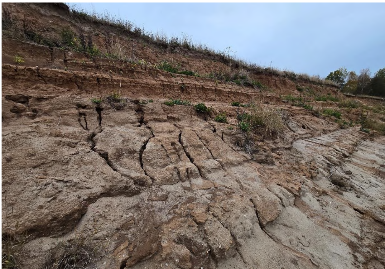
Фото 5. Надоползневой уступ и оползневые массы вблизи д. Новинки, ТН 1.3.
