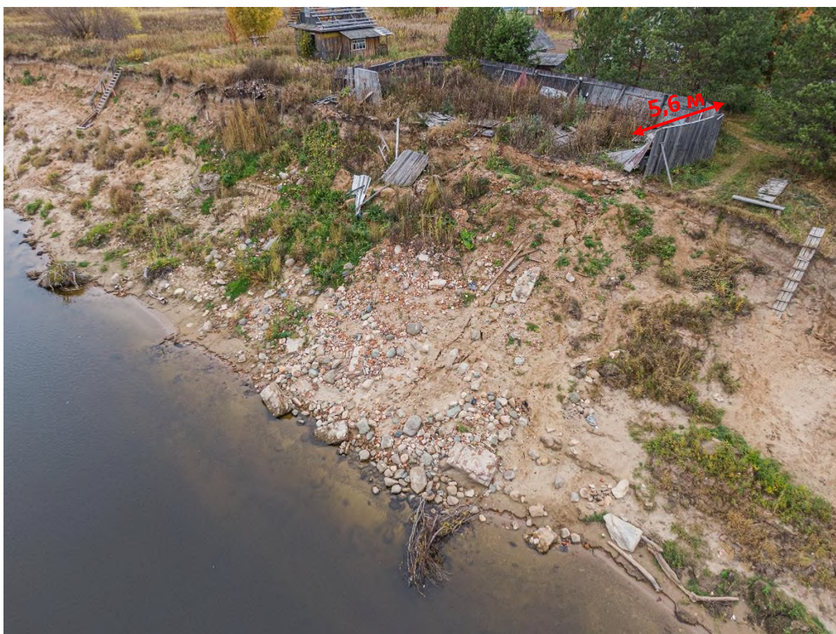
Фото 15, 16. Полное разрушение старого пустующего дома в результате активизации оползневого процесса в д. Пускино, ТН 2.3. вверху – 2022 г, внизу – 2024 г.
