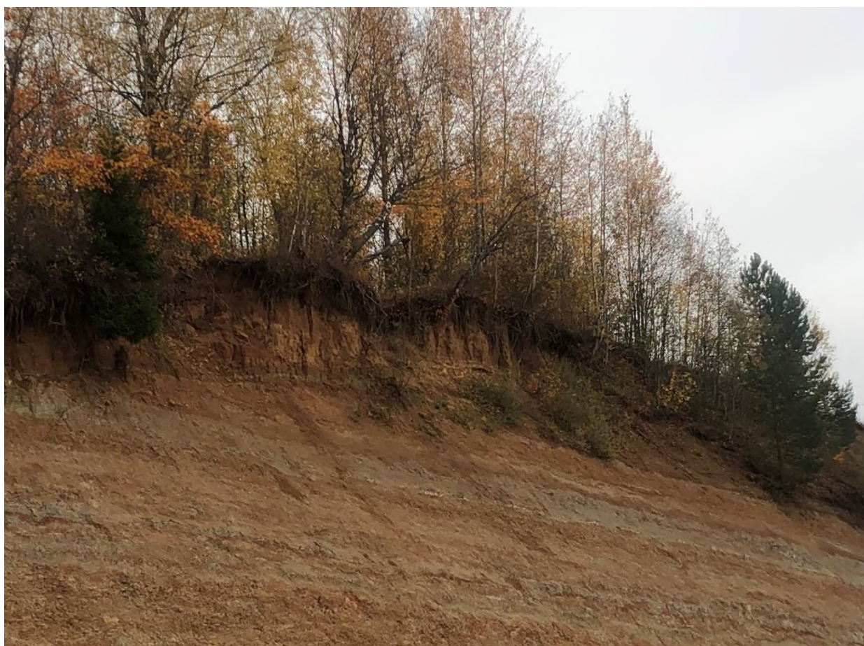
Фото 43, 44. Сползание растительности в верхней части склона и оголение корневищ, д. Заовражье, ТН 5, по состоянию на 2023 г. (вверху) и 2024 г. (внизу)
