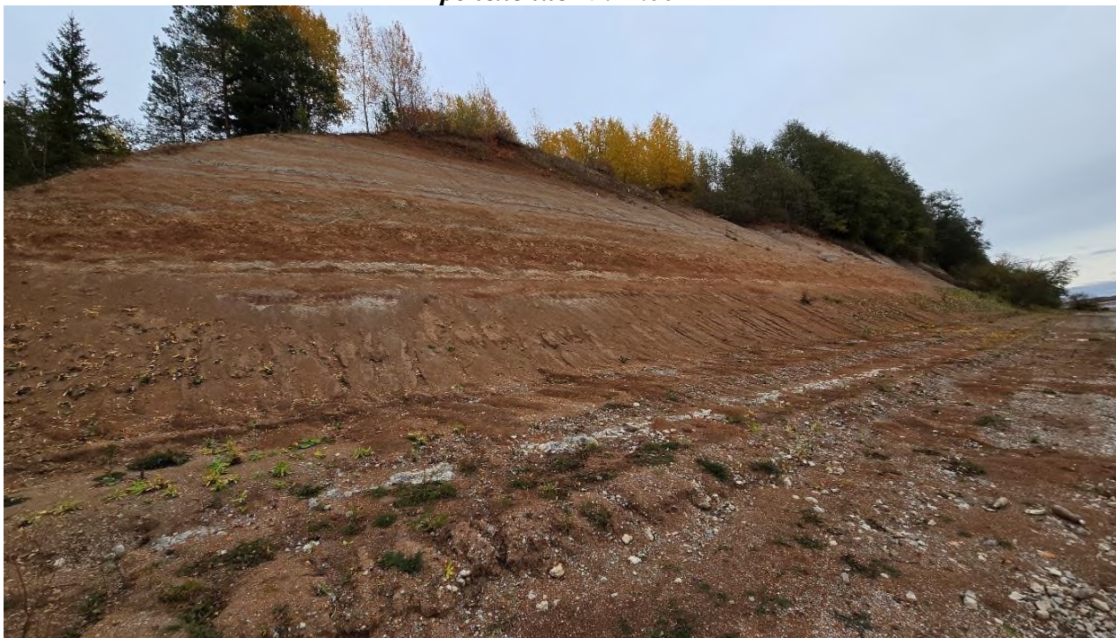
Фото 30. Вид на оползневой склон в деревне южнее ДОКа, д/ж ст. Заовражье, ТН 4.
