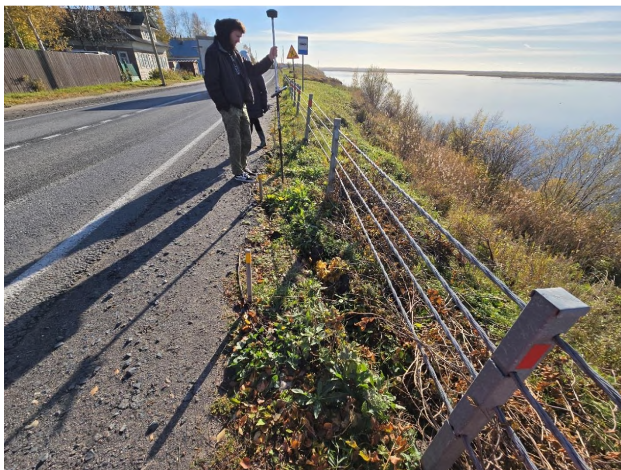
Фото 55, 56. Общий вид на обочину дороги, подверженную оползневому процессу в д. Ершовка, ТН 2.2, ТН 2.3.
