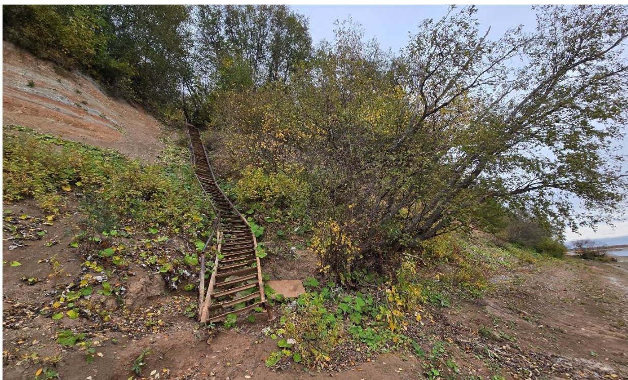
Фото 33, 34. Воздействие оползневого процесса на спусковую лестницу в ТН 4, вблизи д/ж ст. Заовражье по состоянию на 2023 г. и 2024 г. соответственно.
