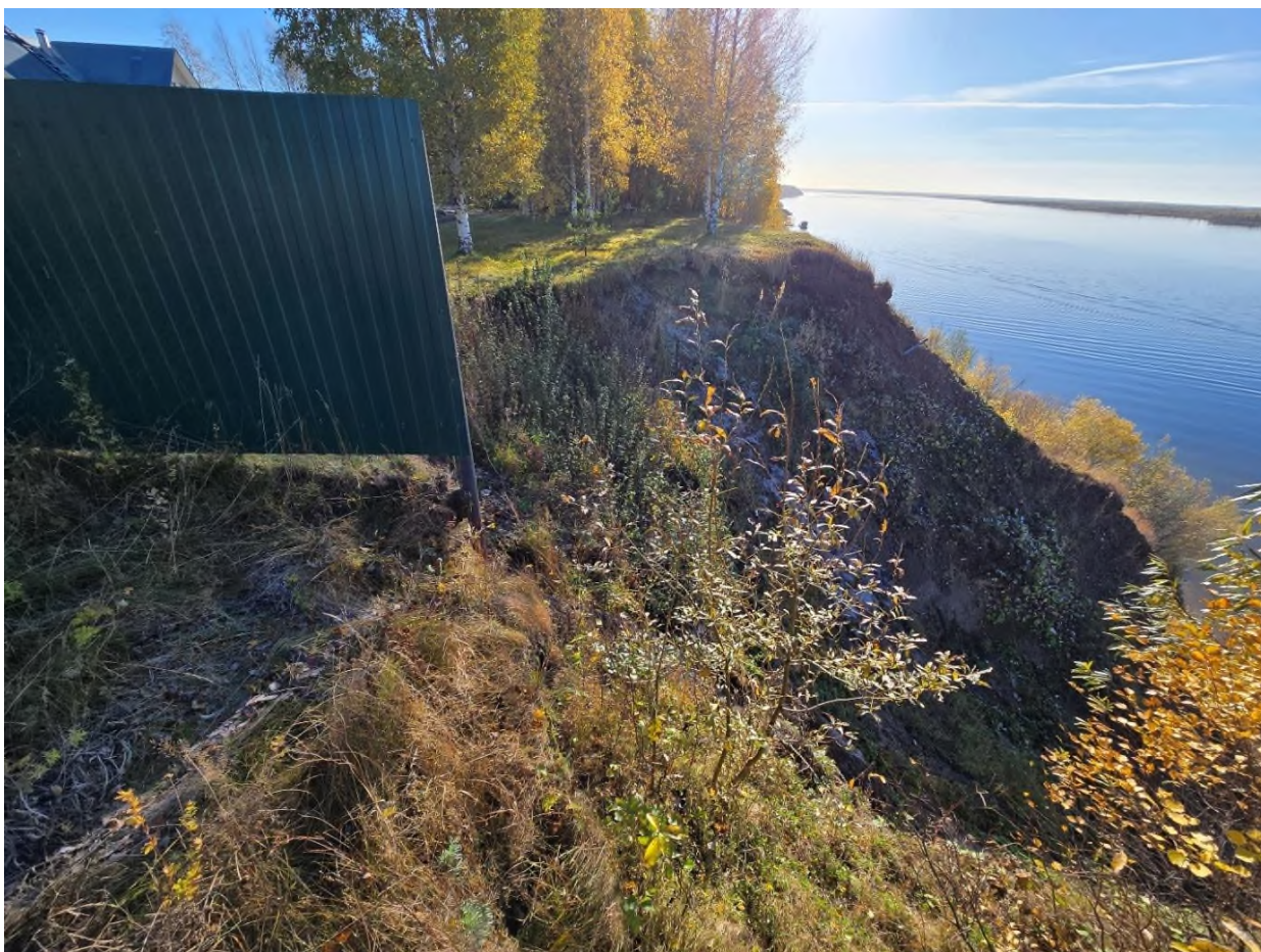
Фото 53. Воздействие оползневого процесса на ограду частной территории, ТН 1.3. д. Псарёво
