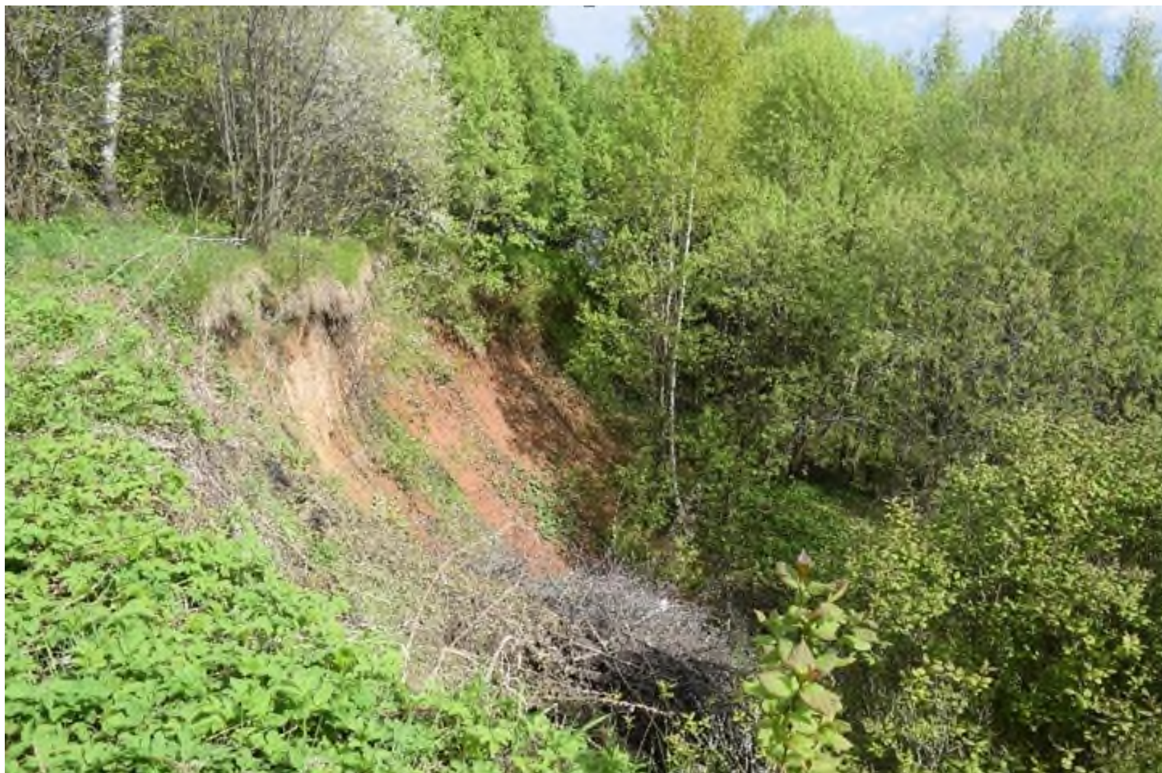
Фото 37.11.00010. Оползень в д. Бакланиха Пучежский района, д.№11, правобережный склон р. Волга (Горьковское вдхр.), Ивановская область
