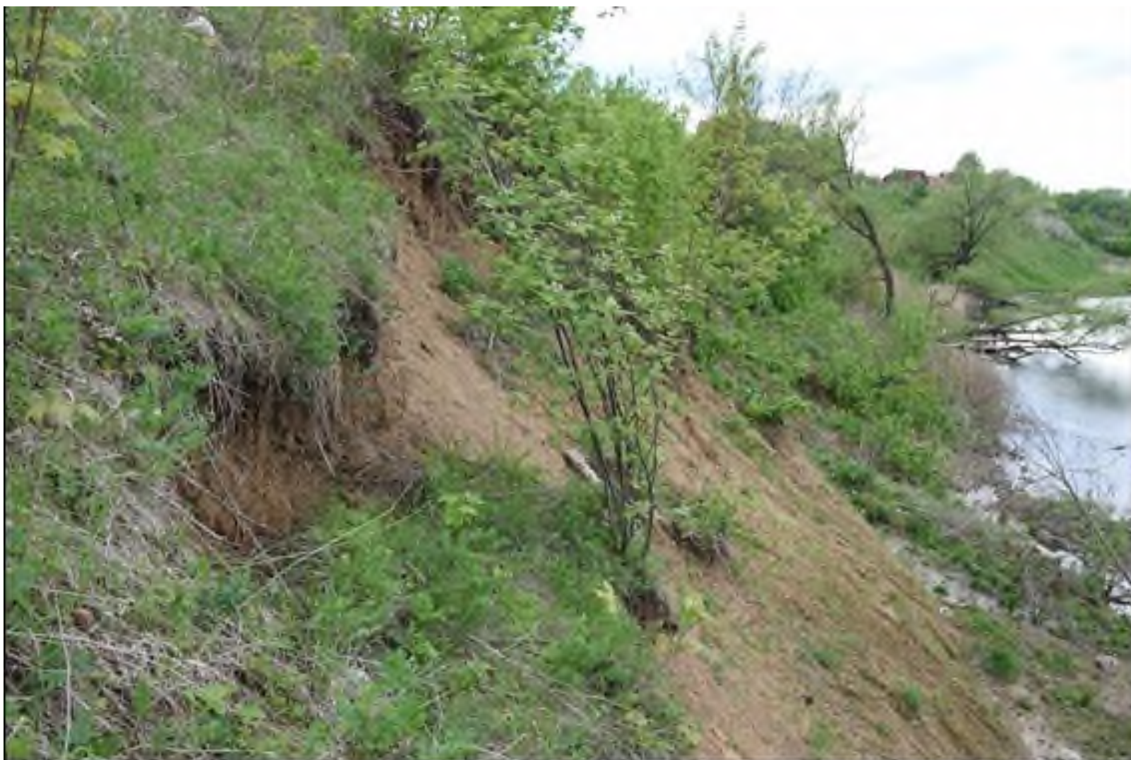
Фото 33.11.00152. Оползень на правом склоне р. Каменка, Суздальский район, с. Сельцо, в пределах улиц Красноармейская з/у №15 и 2-ая Красноармейская д.№22
