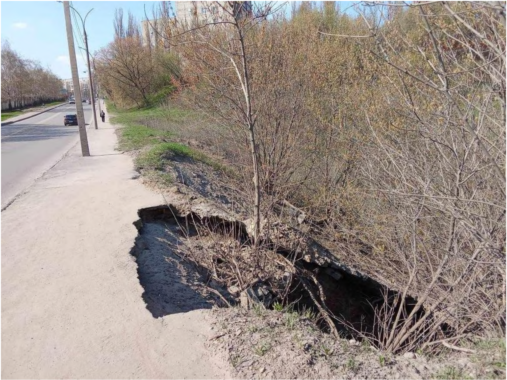
Фото 48-22-00002 Активный овраг ул. Доватора, ул. Крылова, Каменный Лог г. Липецк Липецкая область
