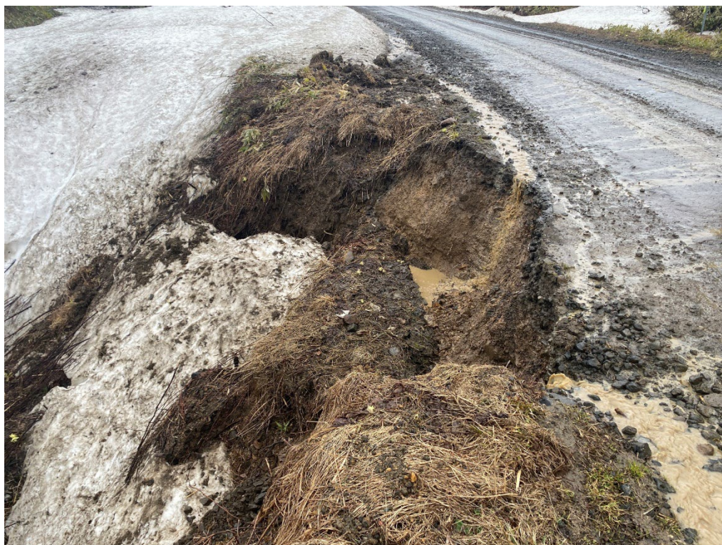
Фото 65-11-0001. № проявления 65-11-0001. Оползневое тело в сновании насыпи автомобильной дороги. 91 км автомобильной дороги Невельск - Томари - аэропорт Шахтерск. Дата съемки: 14.04.2025г. Фото: Ващенко Д.А.
