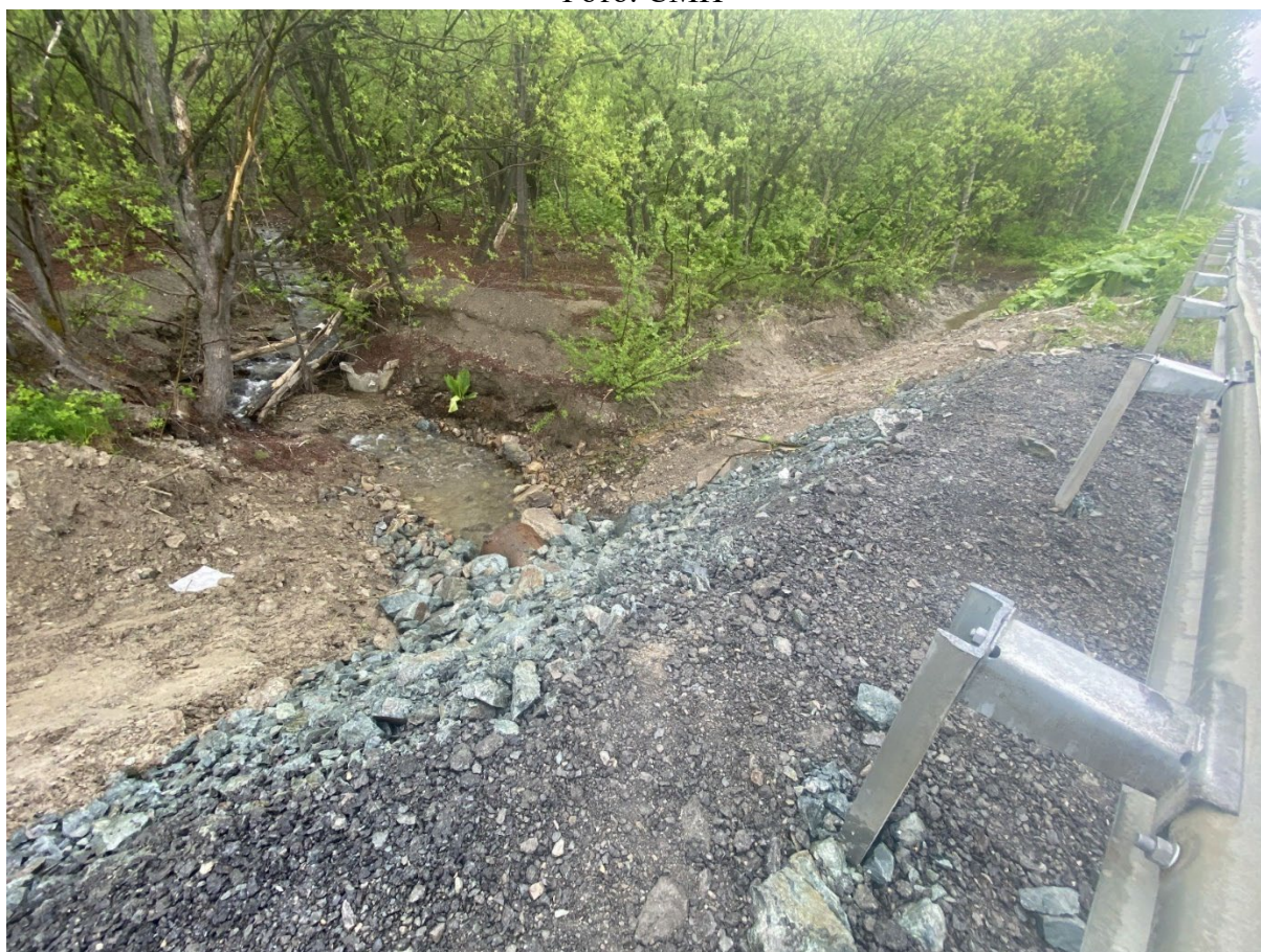
Фото 65-11-0004. № проявления 65-11-0004. Основание насыпи автомобильной дороги. Отсыпано после активизации оползневого процесса. Южно-Сахалинск. 4 км. автомобильной дороги по ул. Лесная. Дата съемки: 26.05.2025г. Фото: Ващенко Д.А.
