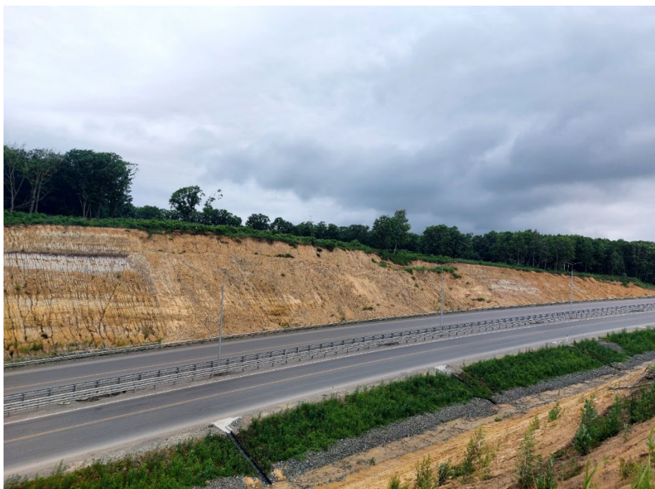
Фото 25-2025-0008. Активизация оползневого процесса на участке 696,9 км автодороги А-370 «Уссури» по состоянию на 25.06.2025 г.
