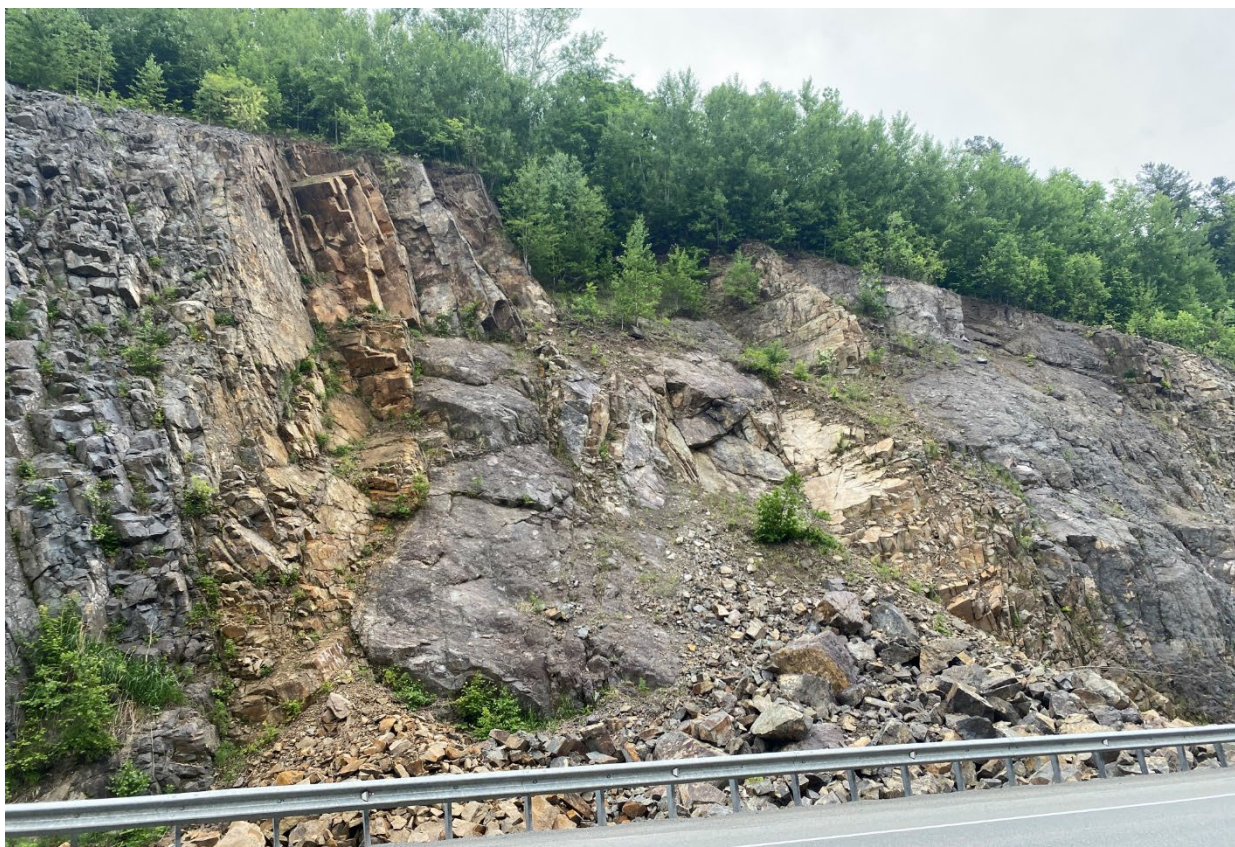
Фото 27-10-00001. Обвально-осыпные конусы на участке 146 км автодороги А-370, Вяземский район Хабаровского края на 10.06.2025 г.
