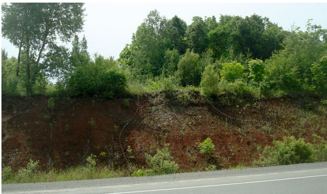
Фото 27-11-00001. Образование выпирающего бугра у подножия склона в результате постепенного оползания грунта на проявлении на 10.06.2025г.
