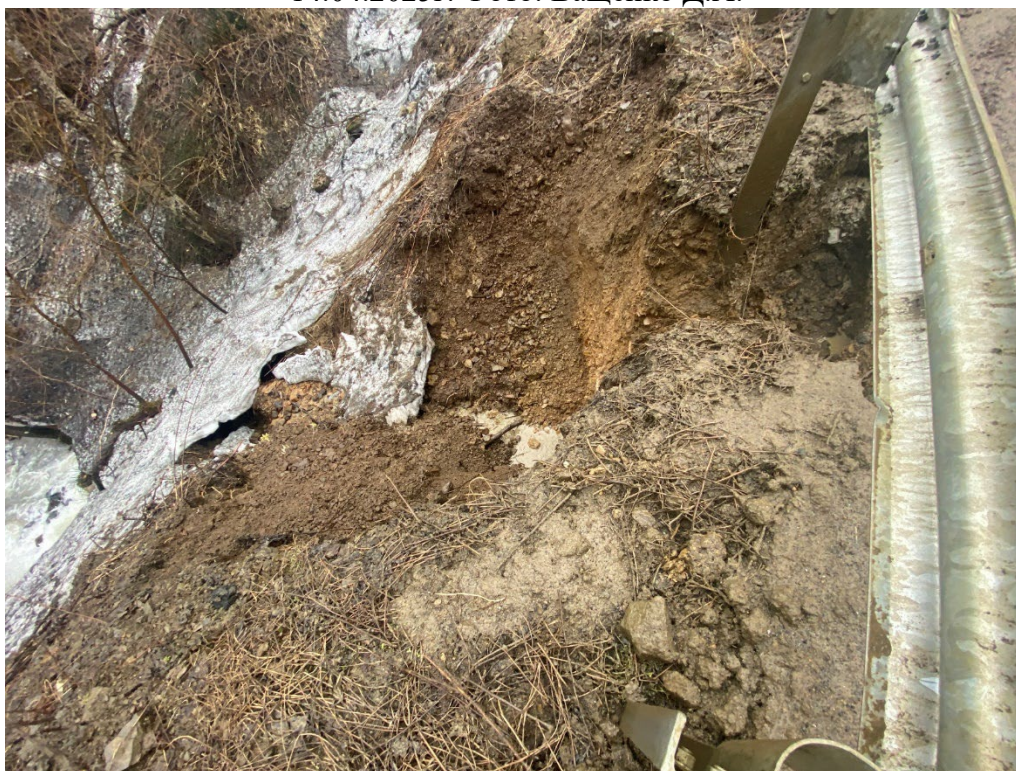
Фото 65-11-0003. № проявления 65-11-0003. Оползневое тело в сновании насыпи автомобильной дороги. 100 км автомобильной дороги Невельск - Томари - аэропорт Шахтерск. Дата съемки: 14.04.2025г. Фото: Ващенко Д.А.
