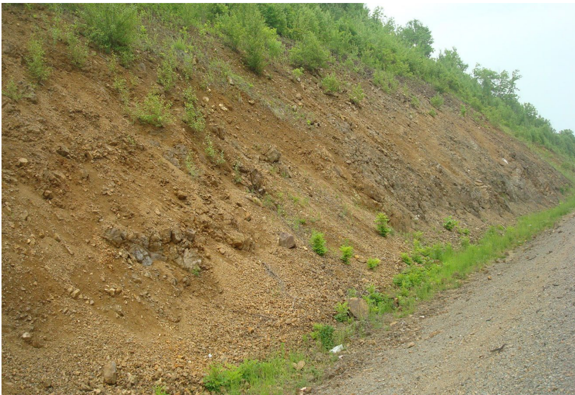
Фото 27-12-00001. Осыпной участок правого склона на участке 217 км автодороги А-370, Бикинский район Хабаровского края на 11.06.2025г.
