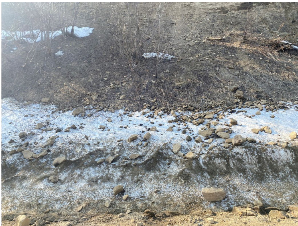
Фото 65-10-0002. № проявления 65-10-0002. Обвально-осыпной склон. 40 км автомобильной дороги Огоньки – Невельск. Дата съемки: 11.04.2025г. Фото: Ващенко Д.А.
