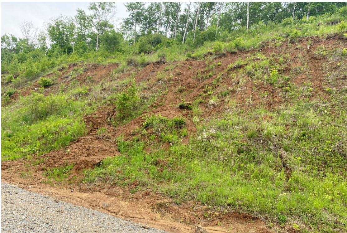
Фото 27-11-00009. Отрыв и оползание грунта вместе с растительностью, скопление грязевых масс у подножия на участке 217 км автодороги А-370, Бикинский район Хабаровского края на 11.06.2025г.
