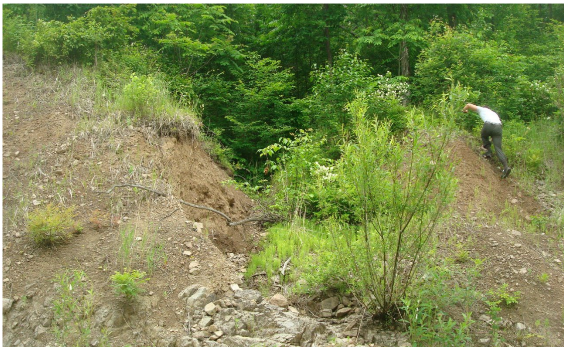
. Фото 27-22-0004. Устье оврага на участке 146км автодороги А-370, Вяземский район Хабаровского края 10.06.2025г.
