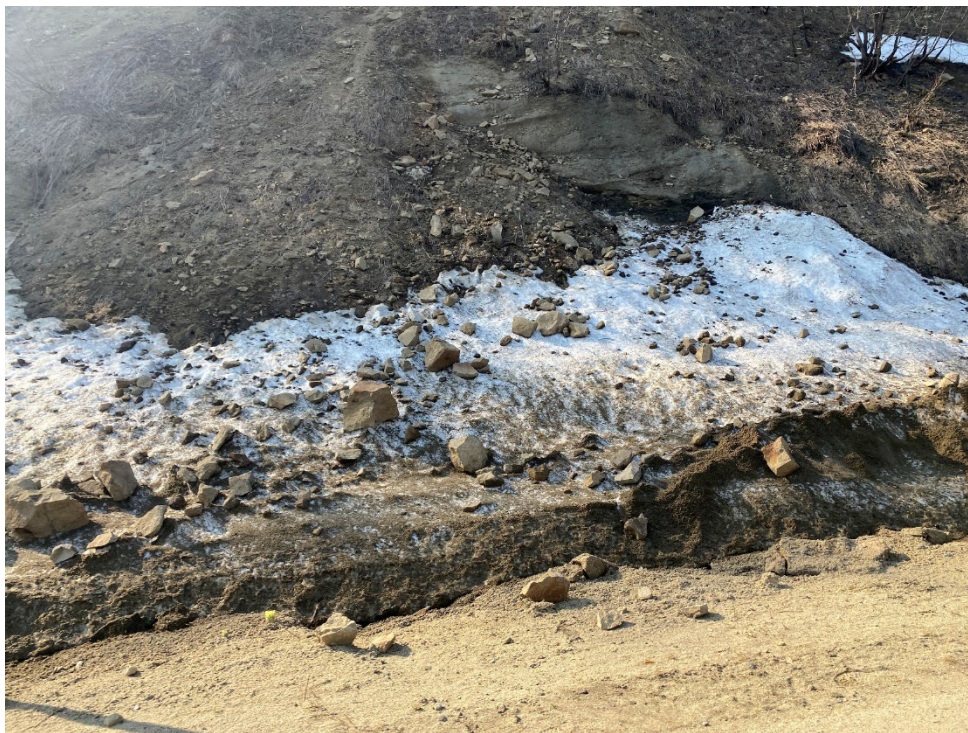
Фото 65-10-0001. № проявления 65-10-0001 Обвально-осыпной склон. 40 км автомобильной дороги Огоньки – Невельск. Дата съемки: 11.04.2025. Фото: Ващенко Д.А.
