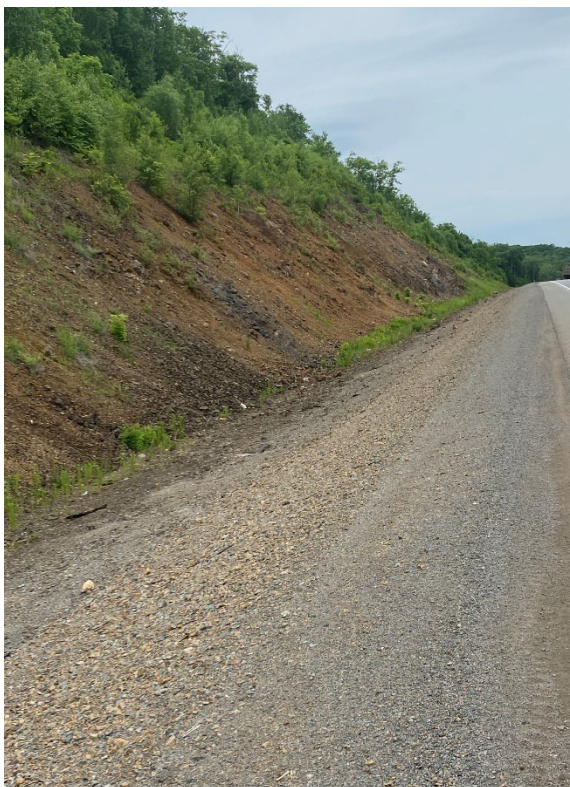
Фото 27-12-00024. Осыпной участок левого склона на участке 217 км автодороги А-370, Бикинский район Хабаровского края на 11.06.2025г.
