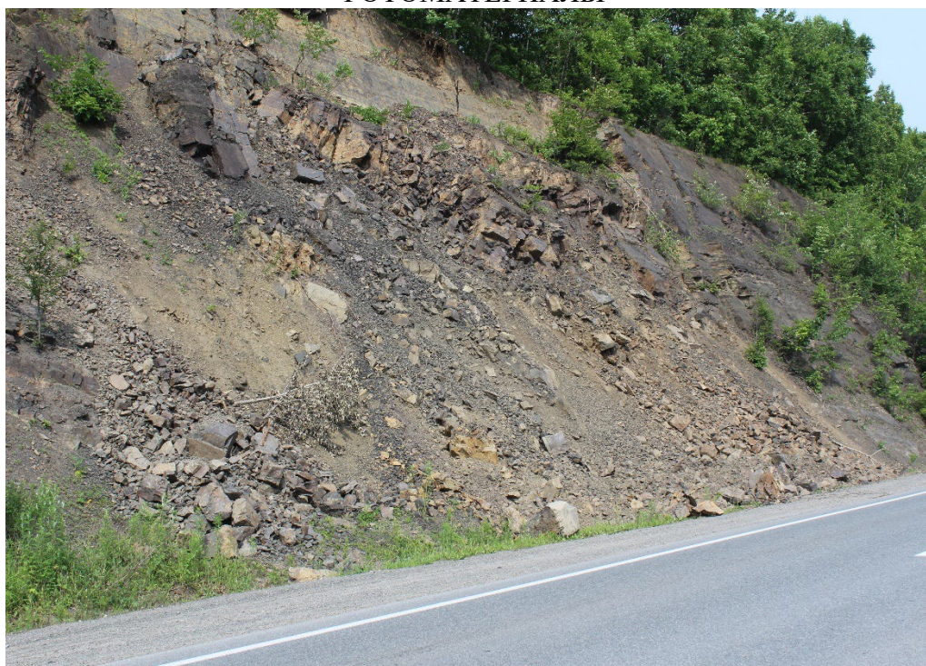
Фото 25-2025-0006. Активизация осыпного процесса на участке 717,992 км автодороги А-370 «Уссури» по состоянию на 25.06.2025 г.
