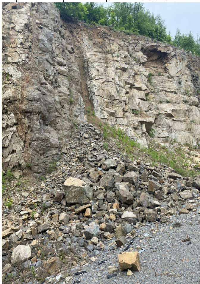
Фото 27-10-00002. Обвально-осыпной конус на участке 146км автодороги А-370, Вяземский район Хабаровского края на 10.06.2025г.
