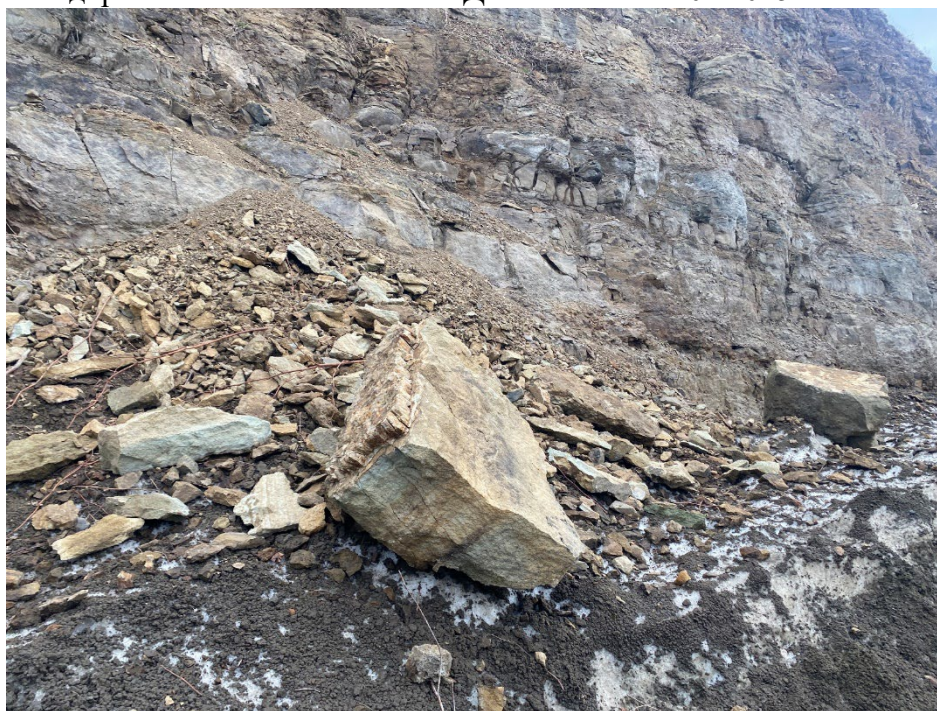
Фото 65-10-0004. № проявления 65-10-0004. Обвально-осыпной склон. 85 км автомобильной дороги Южно-Сахалинск – Холмск. Дата съемки: 11.04.2025г. Фото: Ващенко Д.А.
