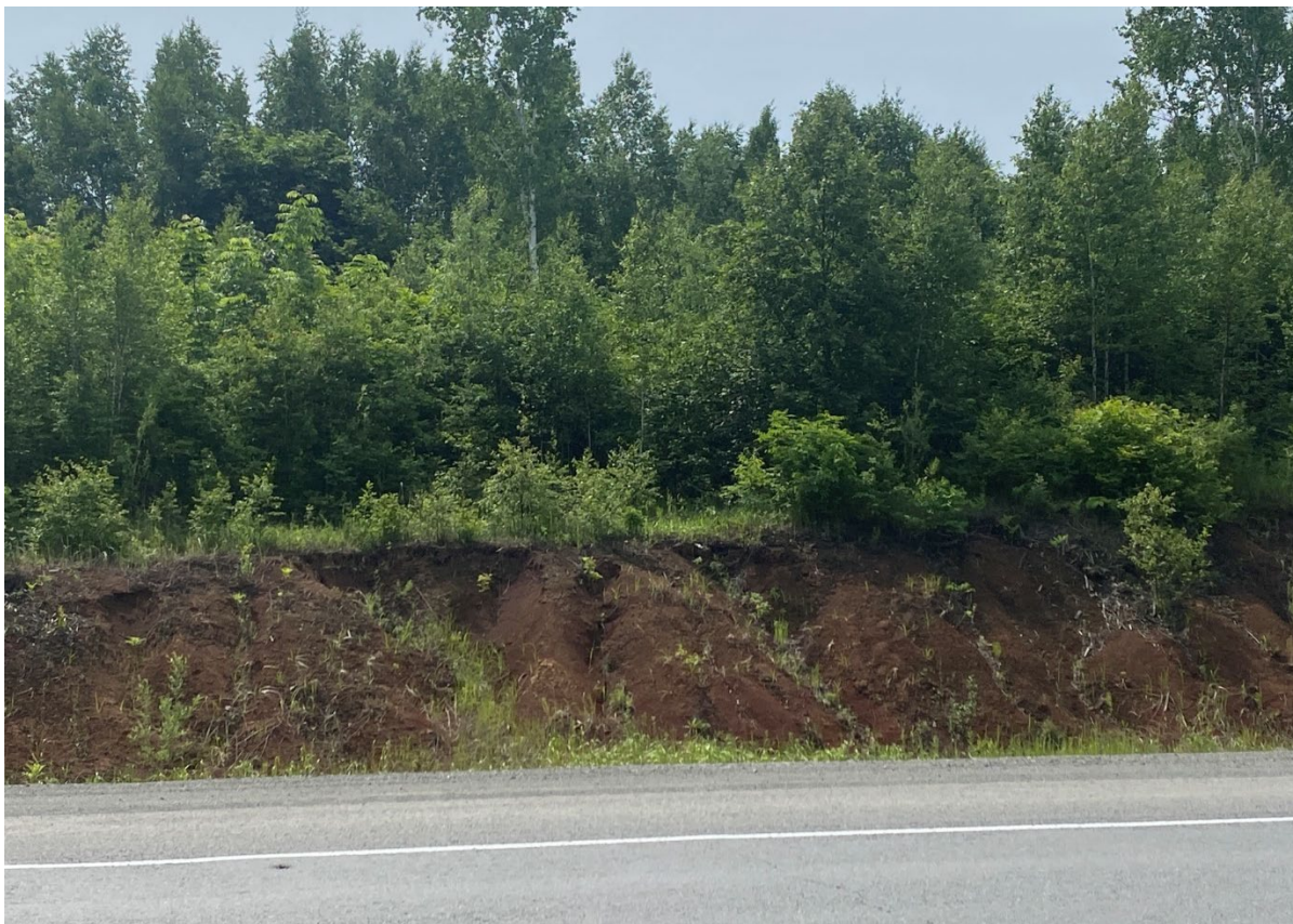
Фото 27-11-00002. Оползание грунта с образованием глубоких рытвин на проявлении на участке 117 км автодороги А-370, Вяземский район Хабаровского края 10.06.2025г.
