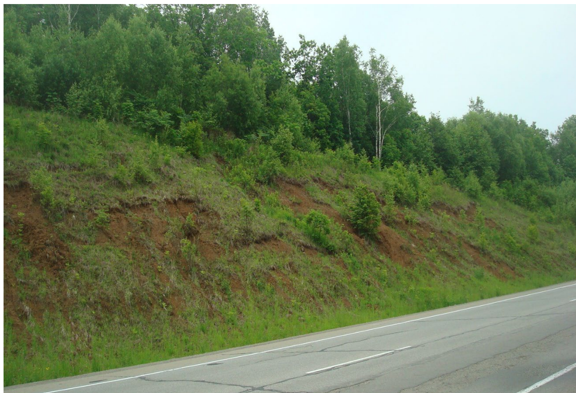
Фото 27-11-00002. Образование новых оголенных участков на левом склоне в результате оползания почвенных масс на участке 217 км автодороги А-370, Бикинский район Хабаровского края на 11.06.2025г.
