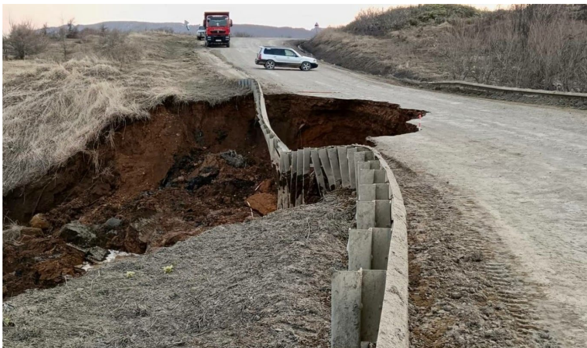
Фото 65-11-0002. № проявления 65-11-0002. Активизация оползневого процесса. 128 км автомобильной дороги Невельск - Томари - аэропорт Шахтерск. Дата съемки: 14.04.2025г. Фото: СМИ
