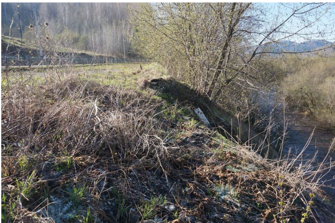
Фото 04-11-00010. Оползень на откосах а/дороги Горно-Алтайск – Кызыл-Озек, 0,125 км, Майминский район, Республика Алтай, 22.04.2025
