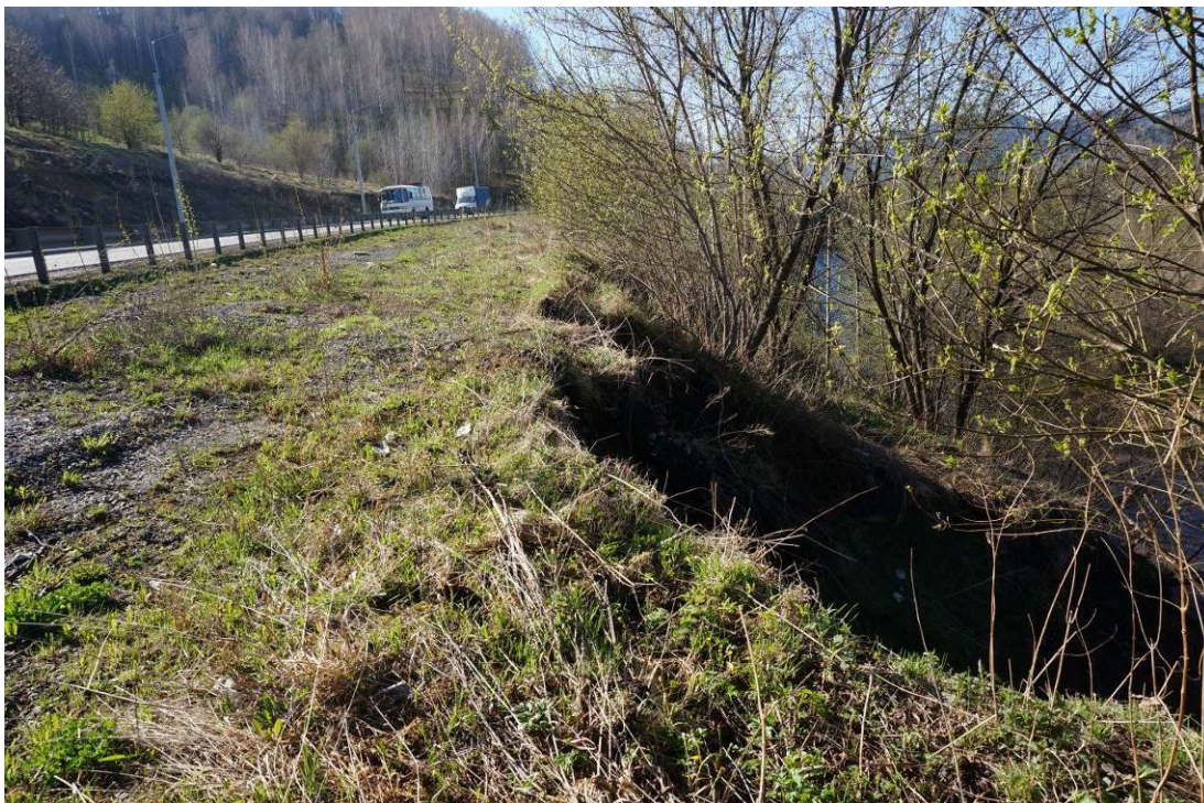
Фото 04-11-00066. Надоползневый уступ оползня, сформированного в апреле 2024 г., уч. а/дороги Горно-Алтайск – Кызыл-Озек, 0,11 км, Майминский район, Республика Алтай, 22.04.2025
