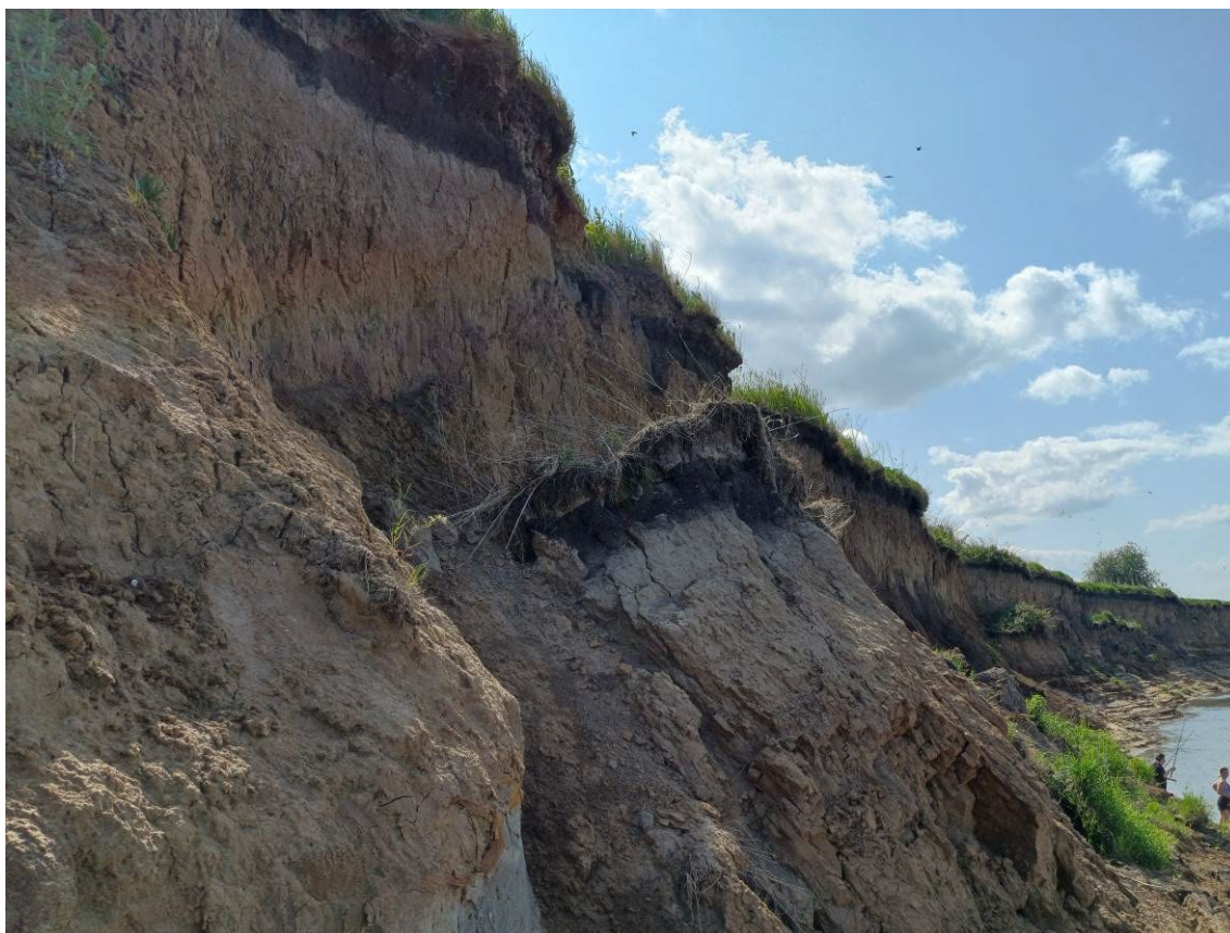
Фото 70-10-00014. Сползание крупных блоков на склоне в районе ул. Школьная с. Красноярка, Зырянский район, Томская область, 17.06.2025
