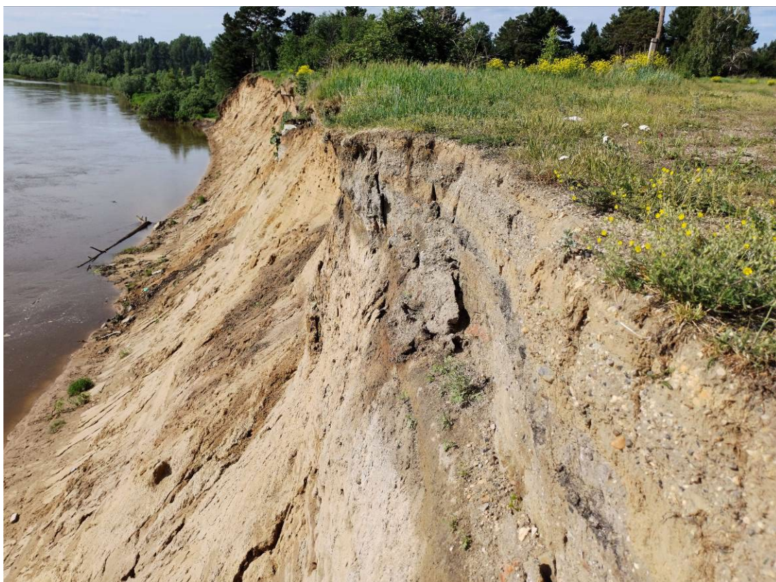
Фото 70-10-00008. Разрушение склона в районе бывшей весовой, с. Чердаты, Зырянский район, Томская область, 17.06.2025
