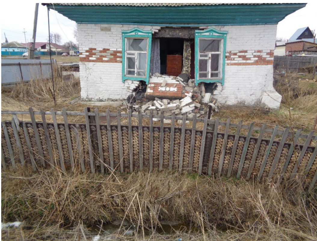
Фото 54-13-00005.а. Разрушение дома на подтопленном участке по ул. Водосточная, 53. г. Бердск, Новосибирская область, 16.04.2025
