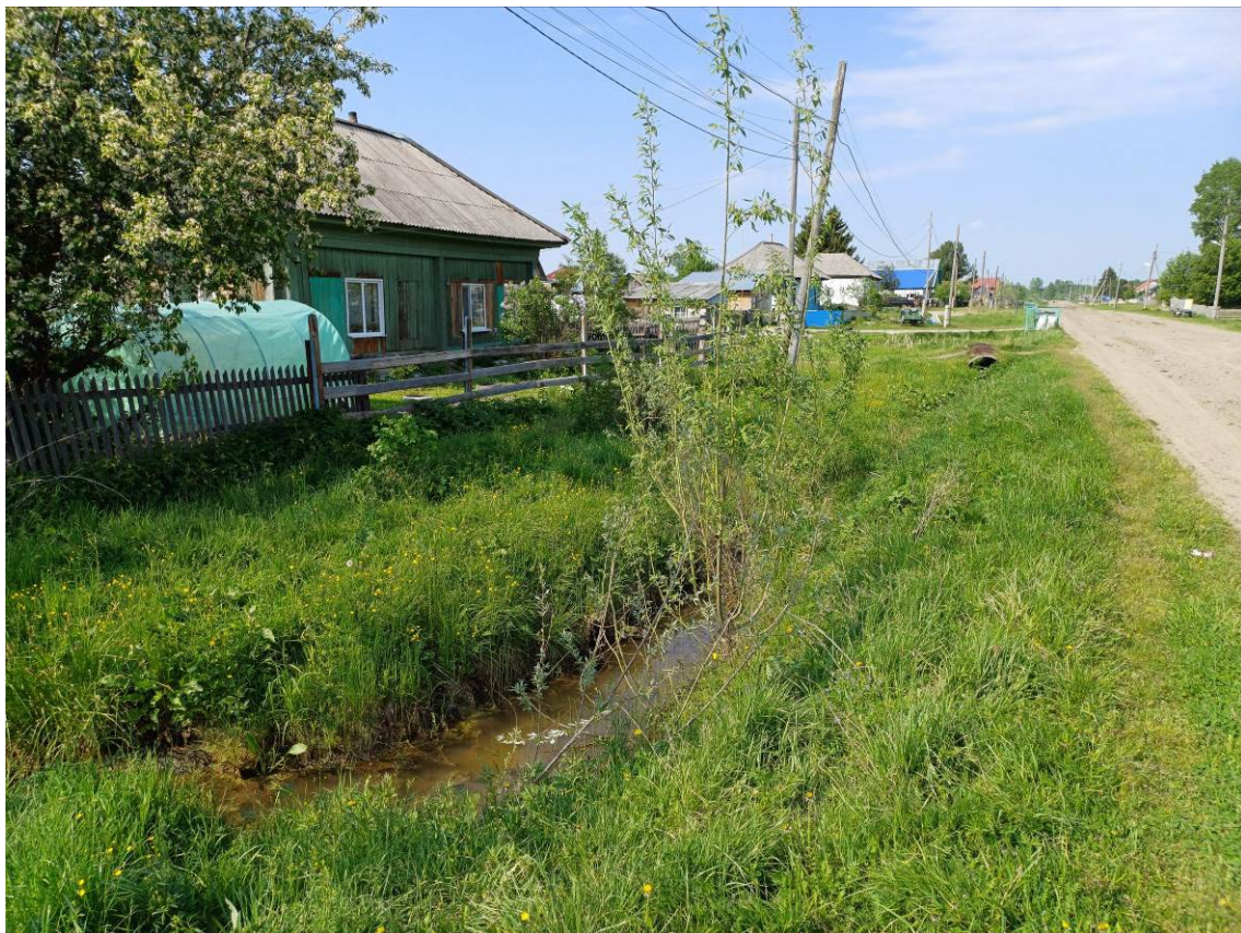
Фото 70-13-00003. Дренажная канава в районе участка по ул. Веселая, 3, с. Чажемто, Колпашевский район, Томская область, 05.06.2025
