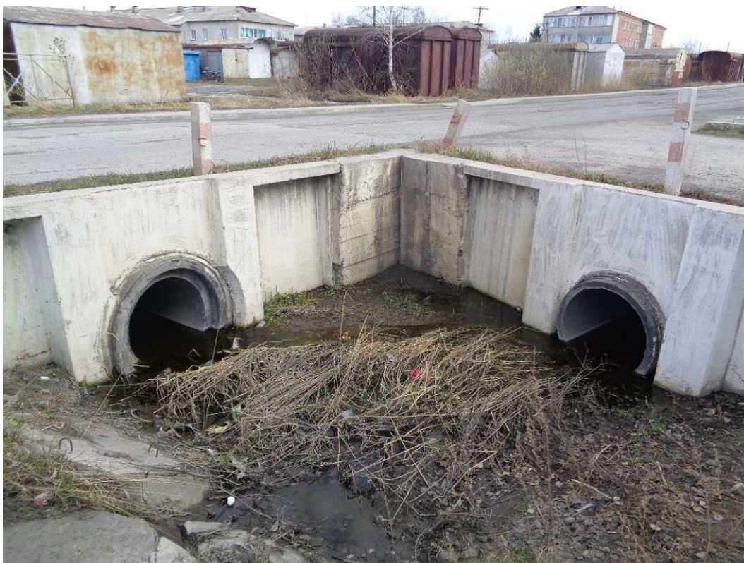
Фото 54-13-00001. Магистральный канал по ул. Островского - дренажная труба через улицу постоянно выше отметки уровня воды в канале. г. Барабинск, Барабинский район, Новосибирская область, 25.04.2025
