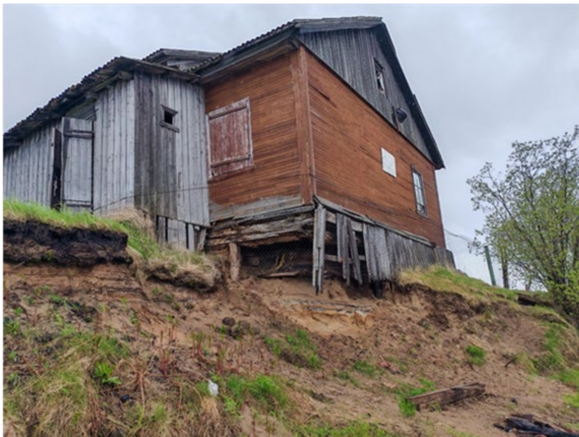
Фото 120. Обрушение берега под жилой постройкой, г. Нарьян-Мар, 16.06.2025
