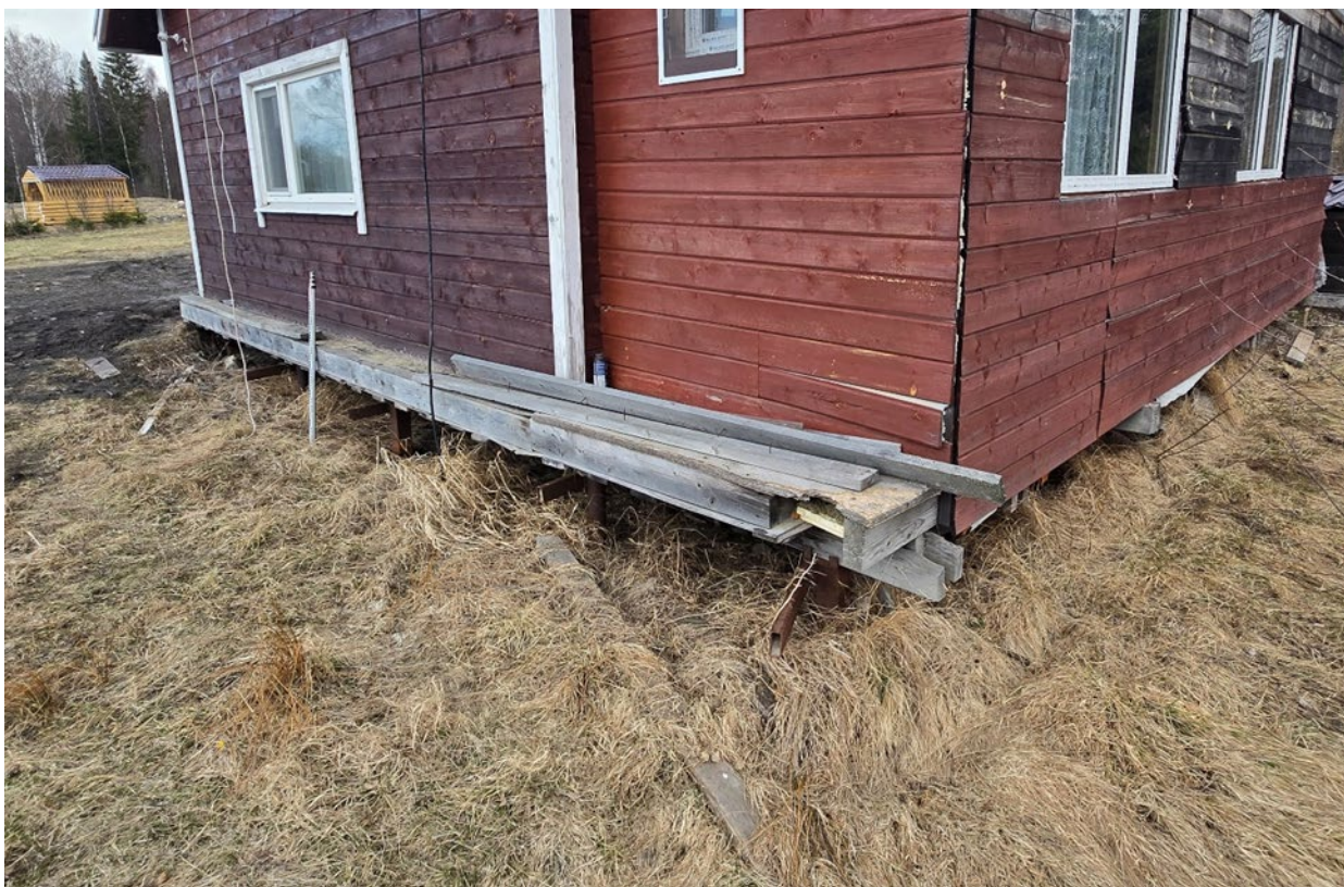
Фото 5. Деформация пола и стен коттеджа в результате просадки верхушки склона в п. Хийденсельга
