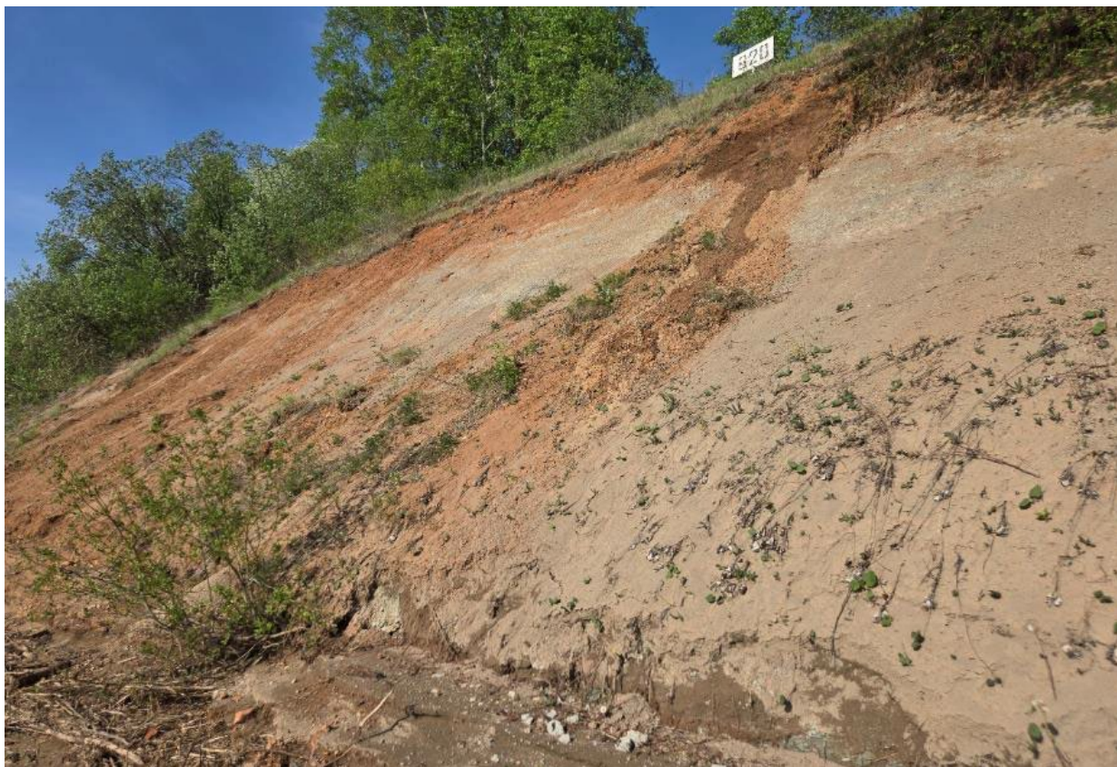
Фото 44. Общий вид оползневого склона, ж/д ст. Заовражье, ул. Мостозавод, 107
