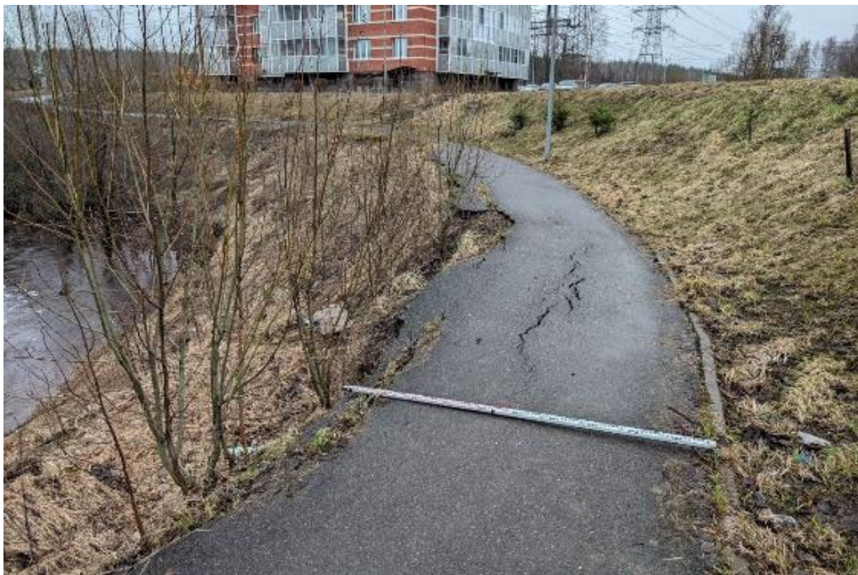
Фото 118. Проявление оползневого процесса вблизи д. 7 по 6-й Жерновской ул. Красногвардейского района г. Санкт-Петербурга в 2024 г. (со стороны входной калитки)
