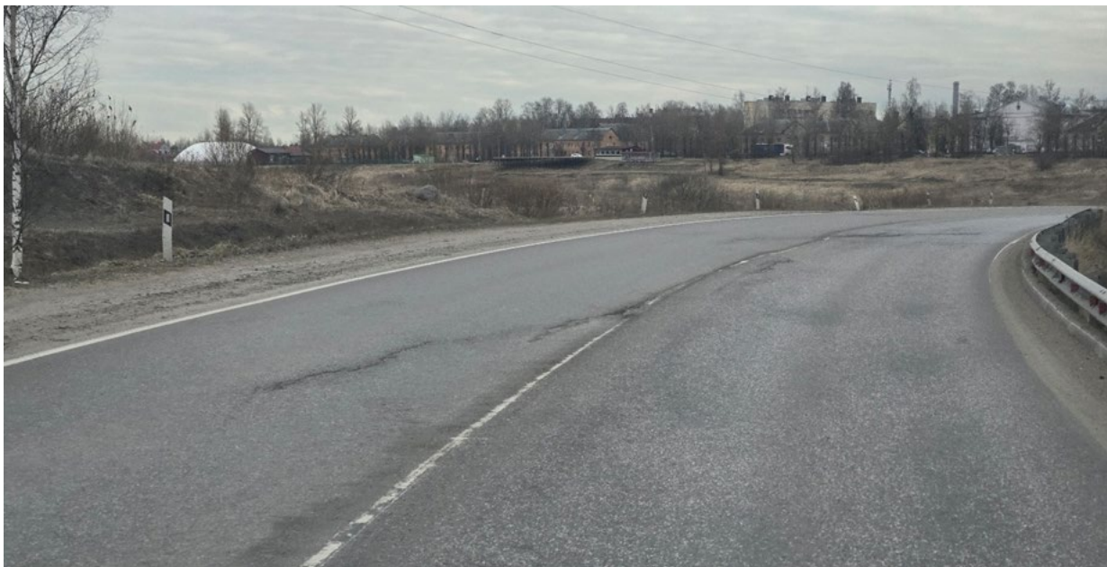
Фото 95. Трещины в асфальте дорожного полотна на участке региональной автодороги Ям-Ижора – Никольское в г. Никольское Тосненского района Ленинградской области
