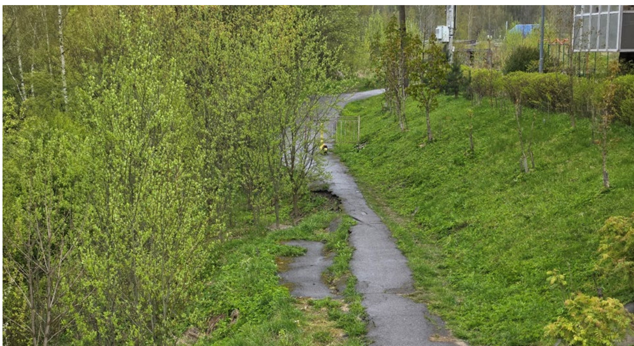
Фото 117. Проявление оползневого процесса вблизи д. 7 по 6-й Жерновской ул. (со стороны ЛЭП) Красногвардейского района г. Санкт-Петербурга
