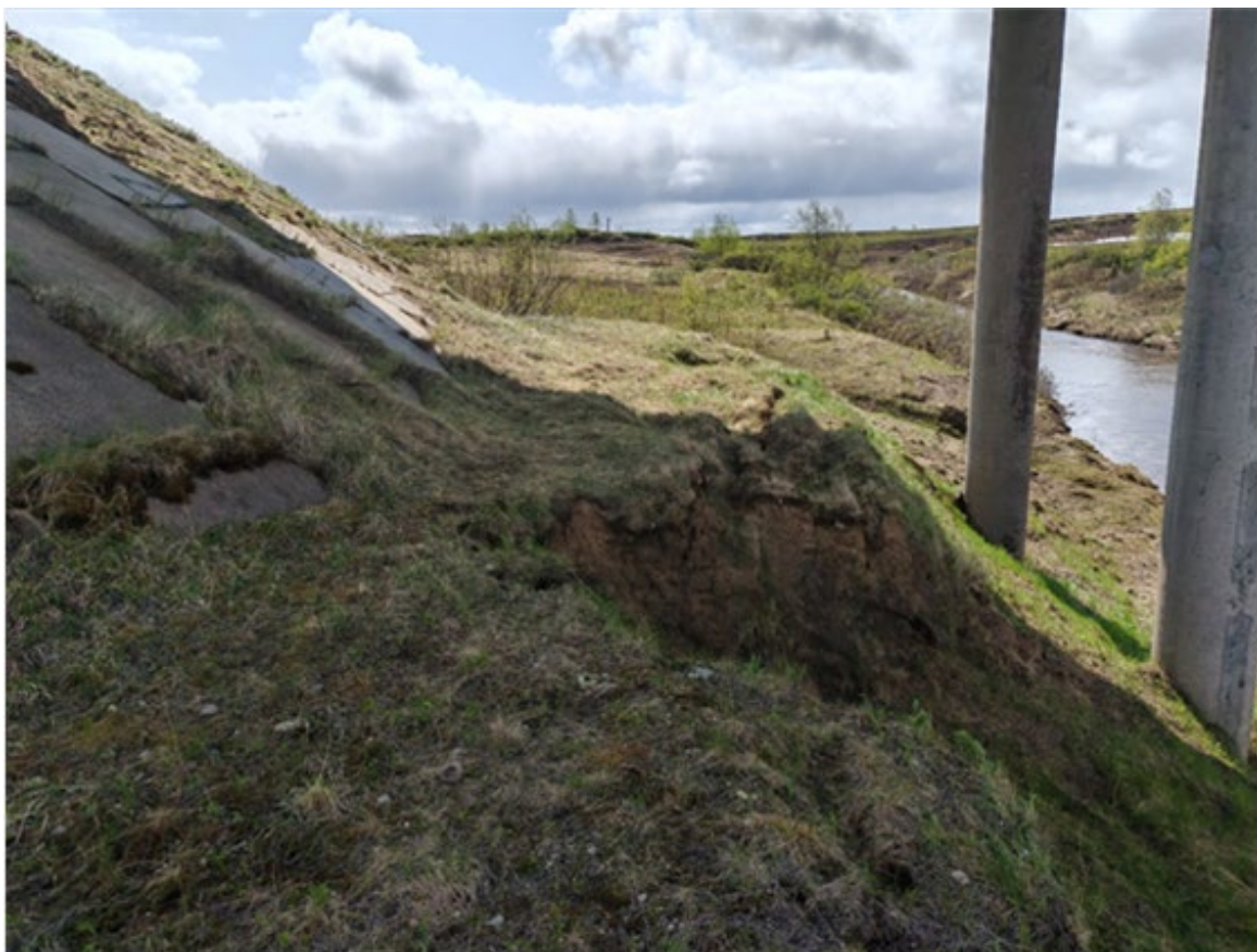
Фото 124, 125. Оползневой процесс под мостом через речку Северная на автодороге Нарьян-Мар- Усинск, 17.06.2025 г.
