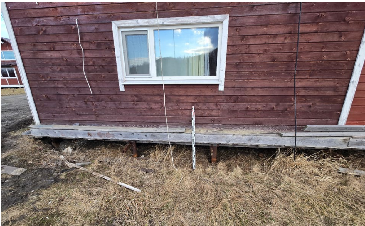
Фото 4. Просадка склона у бровки под коттеджем в п. Хийденсельга
