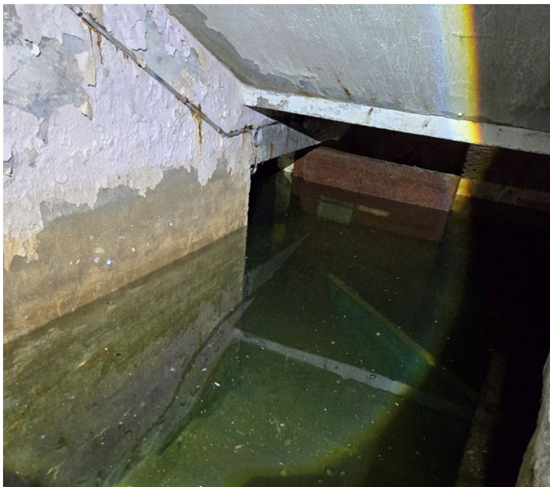
Фото 83. Полностью затопленный подвал Сланцевской швейной фабрики, г. Сланцы, ул. Баранова, д. 20
