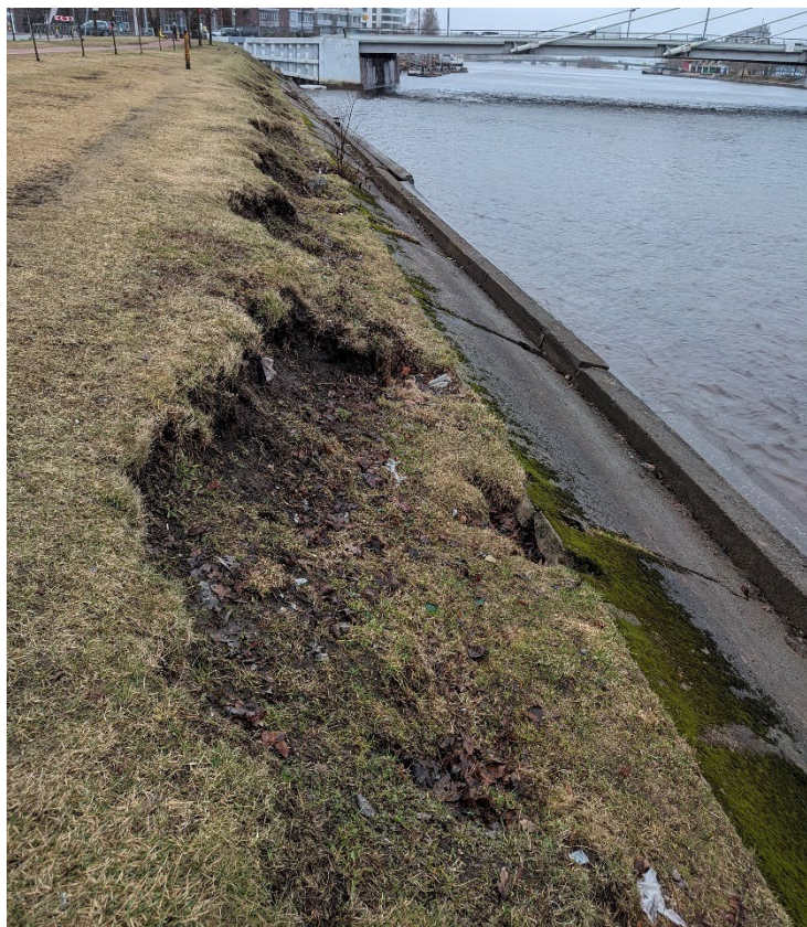
Фото 115. Общий вид на береговой уступ, поражённый суффозионным процессом у д. 24 по набережной Адмирала Лазарева Петроградского района г. Санкт-Петербурга
