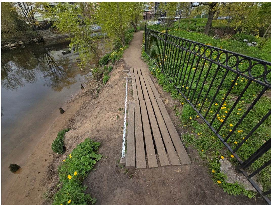
Фото 110. Развитие оползневого процесса на правом берегу р. Смоленка возле кладбища Остров Декабристов в Василеостровском районе г. Санкт-Петербурга.
