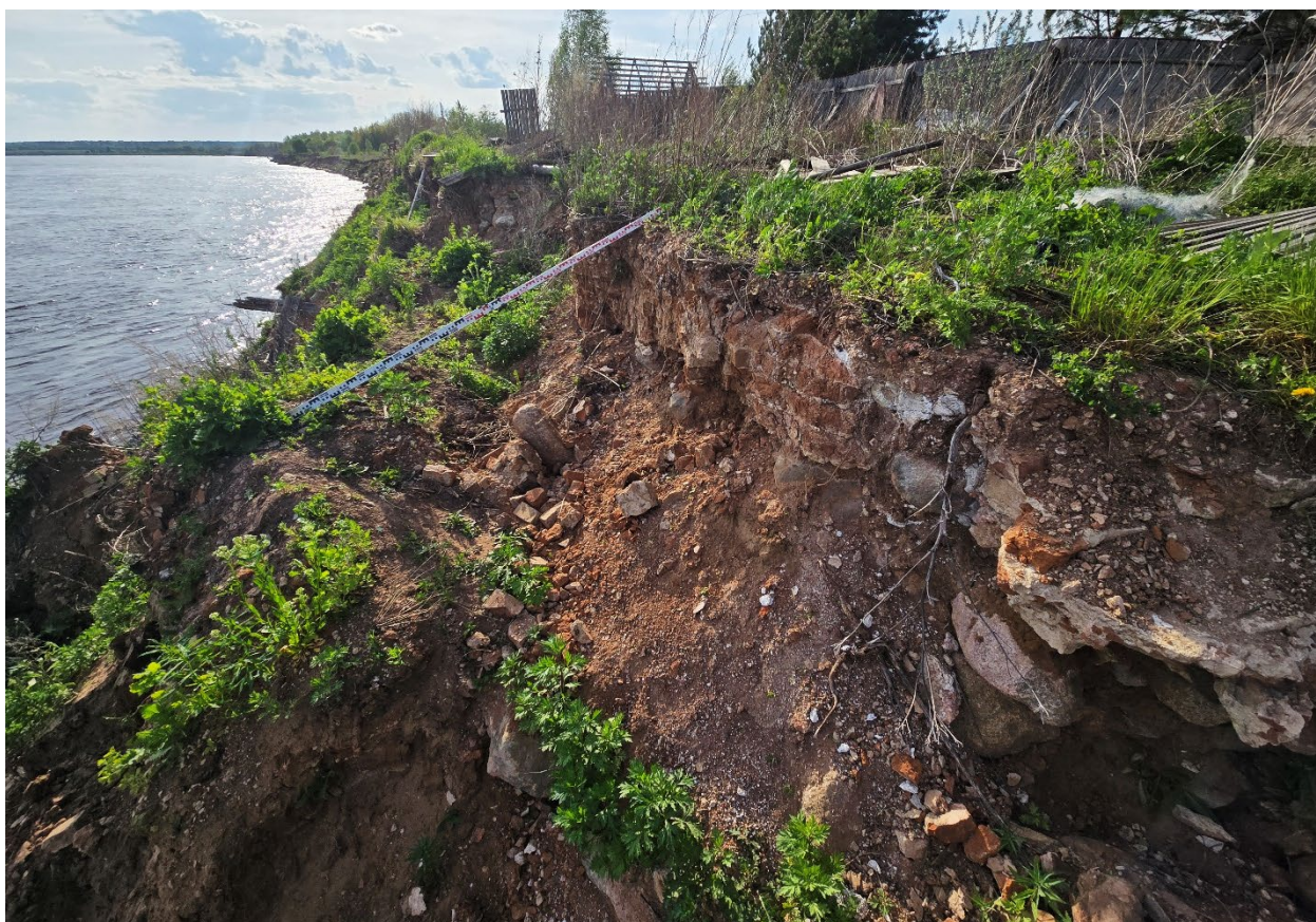
Фото 42, 43. Обваливающийся фундамент и свежие оползневые массы на береговом склоне в д. Пускино.
