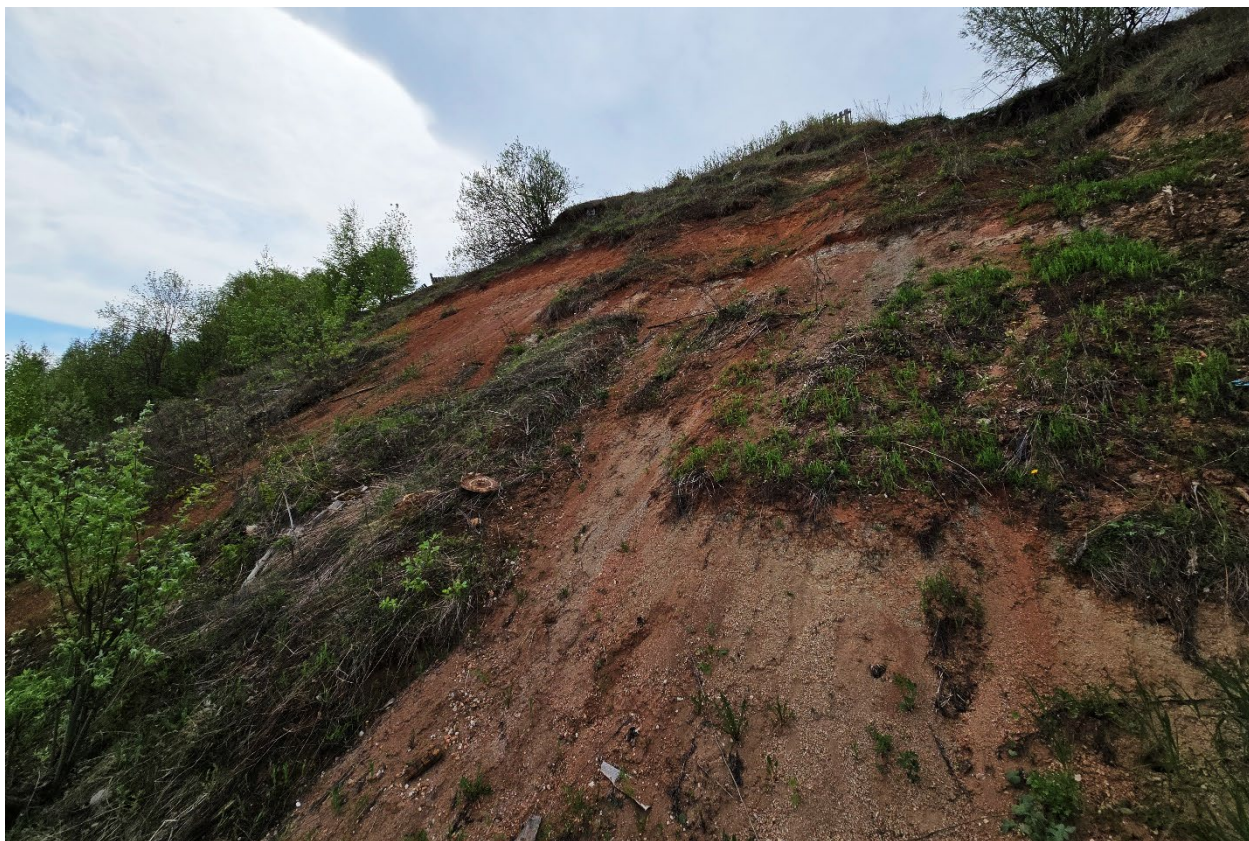
Фото 59. Оползневой склон в д. Марковская с воздействием на ограждение частной территории
