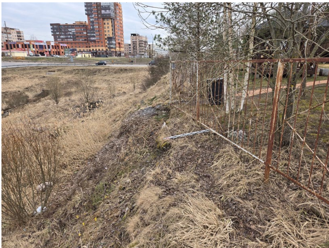
Фото 93. Ограждение территории церкви Царя Николая по ул. Зелёная 7А в г. Никольское Тосненского района Ленинградской области на бровке оползневого склона
