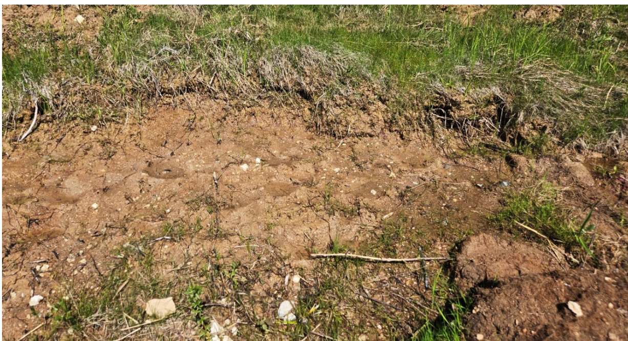
Фото 66. Высачивание подземных вод в нижней части (высотой до 3 м) склона и переувлажнение горных пород подножья склона.
