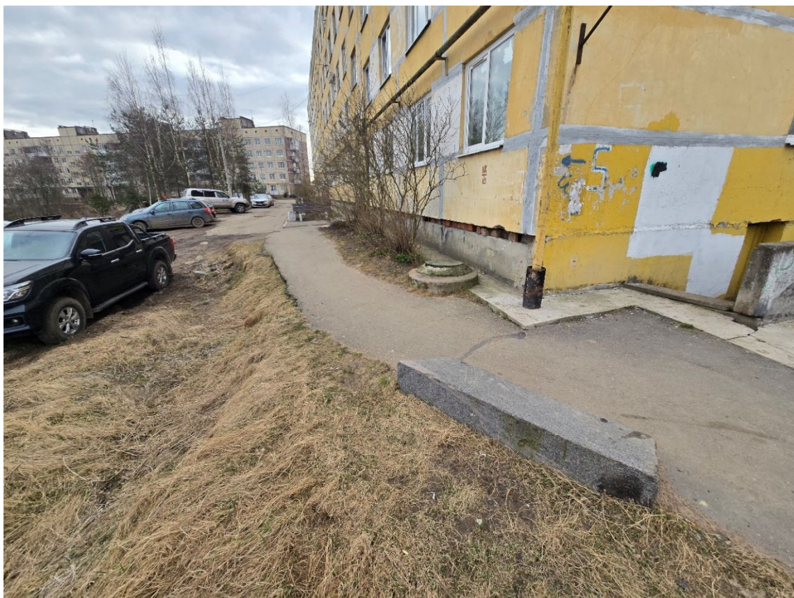
Фото 85. Оползневой уступ в пределах проявления перед д. № 5 в пгт. Войсковое Тосненского района Ленинградской области
