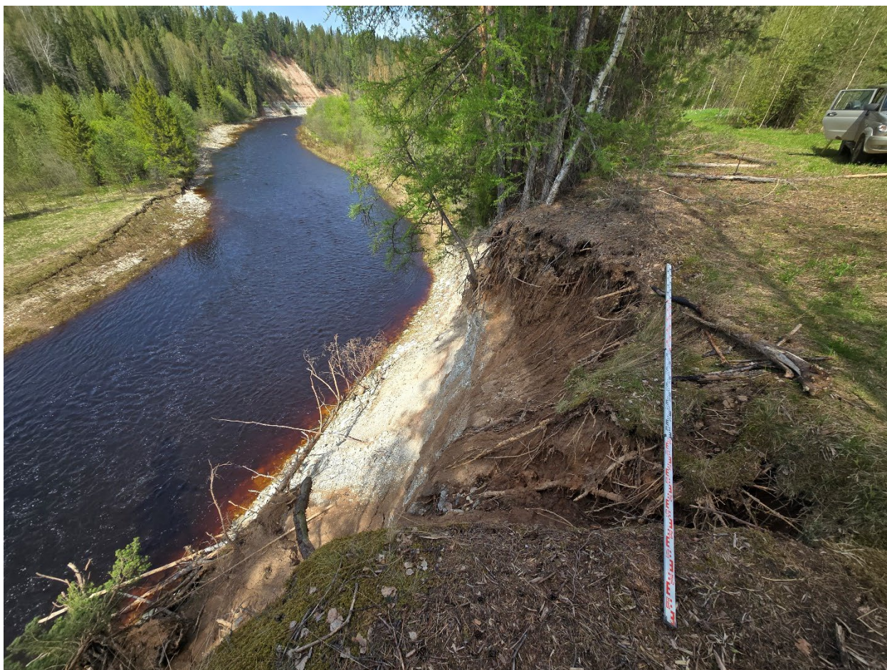
Фото 73, 74. Общий вид проявления на береговом склоне р. Стрельна, д. Студёное. Поваленные деревья, коллювиальные отложения у подножья склона, свежий обвал верхней бровки склона (3 х 2 м).
