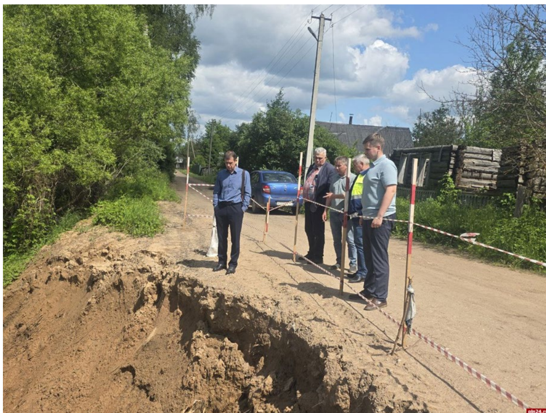
Фото 106, 107. Свежий оползень в д. Барсуки Локнянского округа Псковской области (информация из СМИ)
