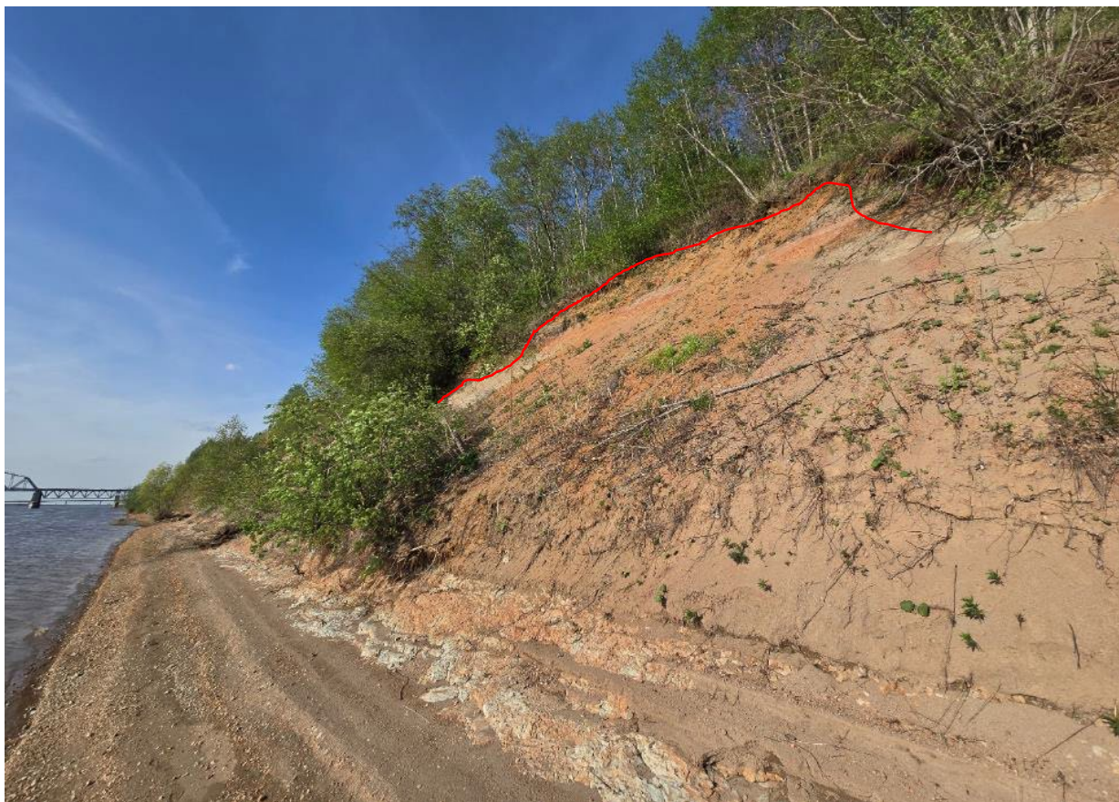
Фото 48. Проявление оползневого процесса на склоне вблизи ж/д ст. Заовражье
