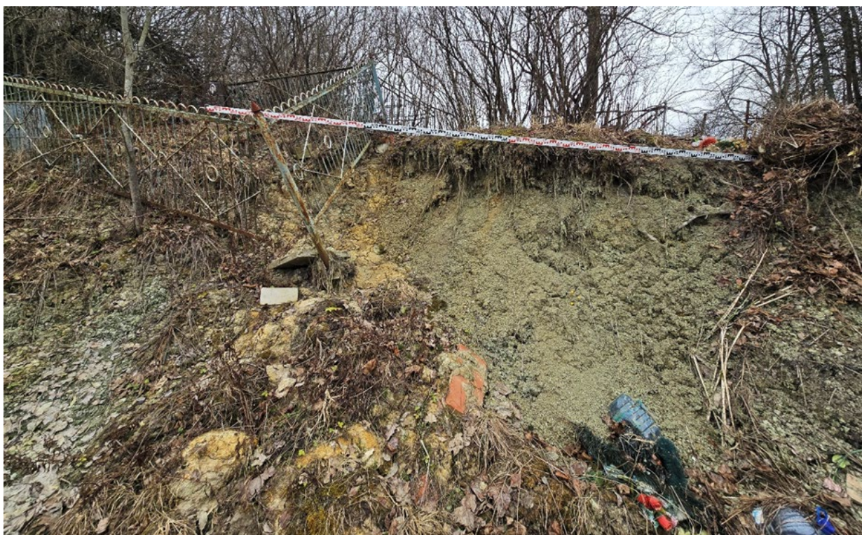
Фото 98. Воздействие оползневого процесса на объекты, расположенные на склоне в пределах Никольского кладбища в г. Никольское Тосненского района Ленинградской области
