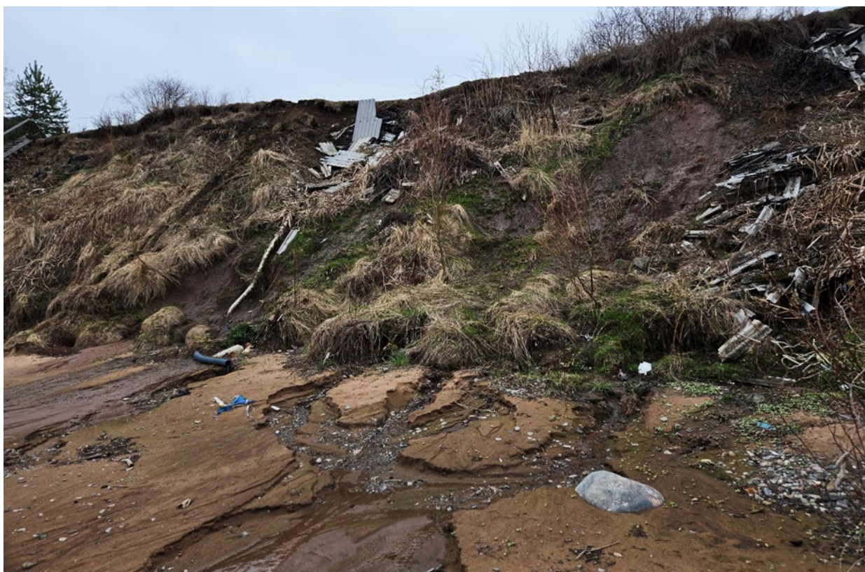
Фото 16. Пригрузка оползневого склона и водоотвод, предпринятые местными жителями, свежие оползневые массы, промоины у подножья склона.
