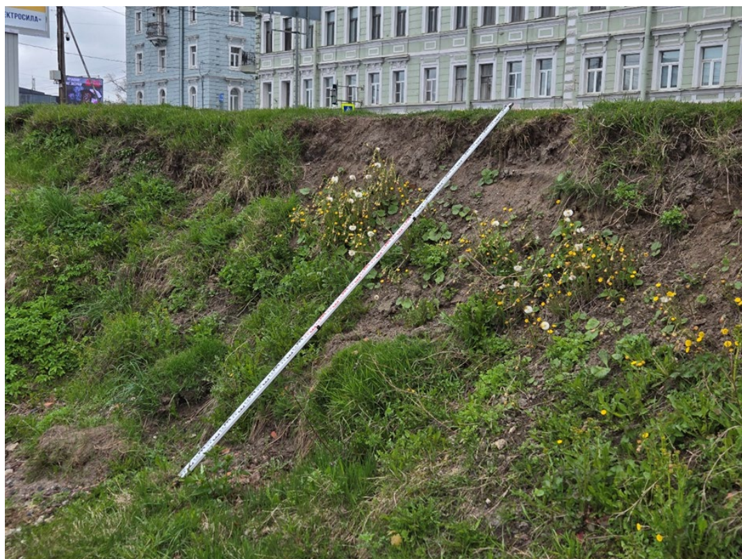
Фото 113. Развитие суффозии над берегоукрепительными сооружениями на набережной Адмирала Лазарева у пересечения с ул. Резной д. 19/8 Петроградского района г. Санкт- Петербурга
