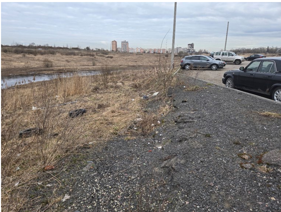
Фото 91. Сползание по склону поребрика и асфальтной крошки у парковочной территории ЖК Прибрежный у д. 16 по ул. Октябрьской в г. Никольское Тосненского района Ленинградской области
