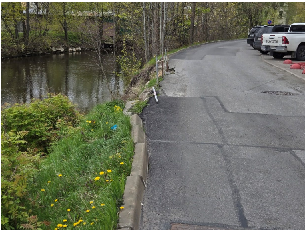
Фото 112. Деформированная часть асфальтового покрытия, воздействие оползневой процесса на поребрик и парковочную зону на оползневом склоне набережной реки Смоленки, д. 33
