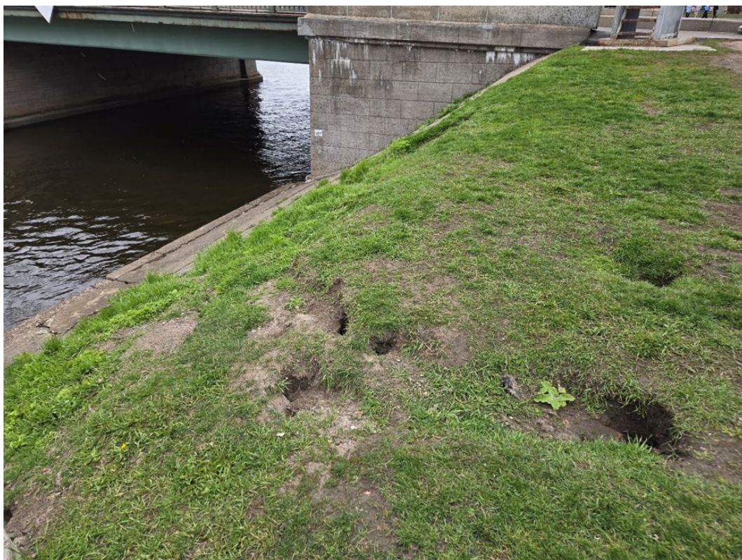
Фото 114. Формирование суффозионных провалов с поверхности в пределах развития проявления на набережной Адмирала Лазарева Петроградского района г. Санкт-Петербурга
