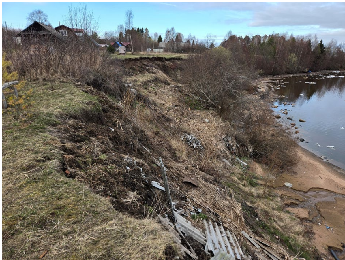
Фото 13, 14. Общий вид проявления на береговом склоне в п. Каскесручей.
