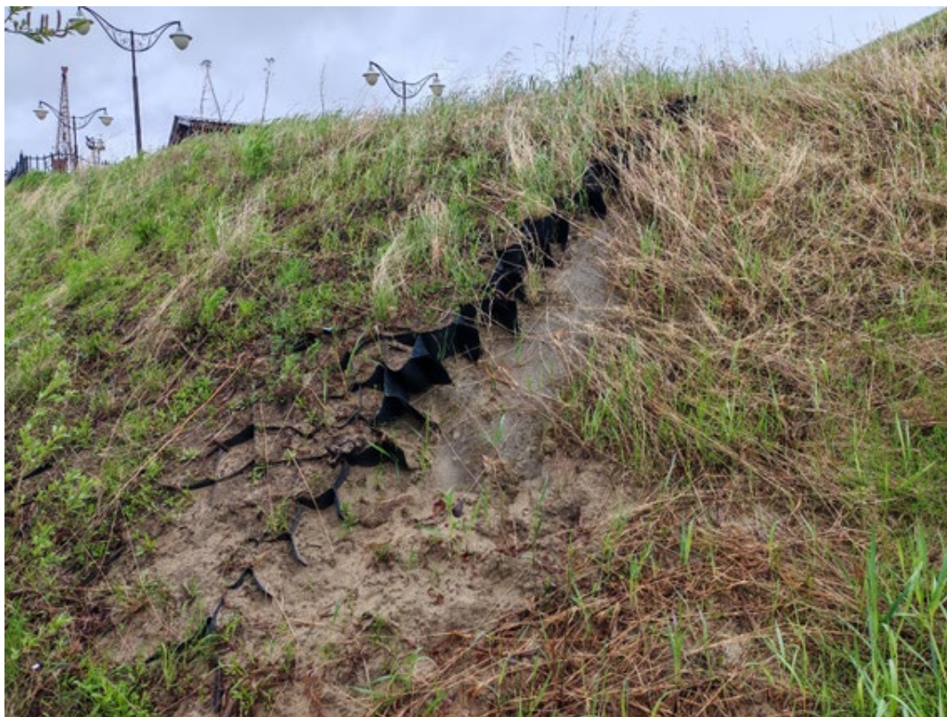
Фото 122. Оползание заново отсыпанных в 2022 г берегоукрепительных конструкций, 16.06.2025 г.
