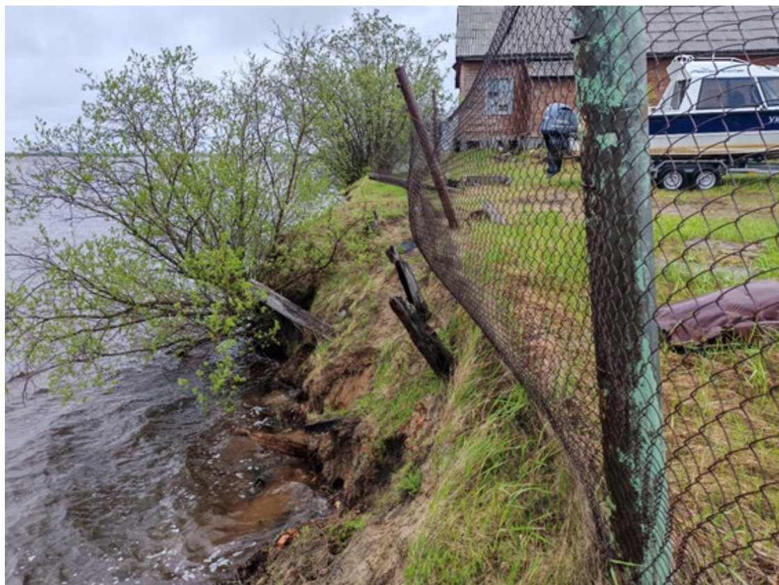
Фото 121. Воздействие оползневого процесса на забор частной территории, 16.06.2025г.
