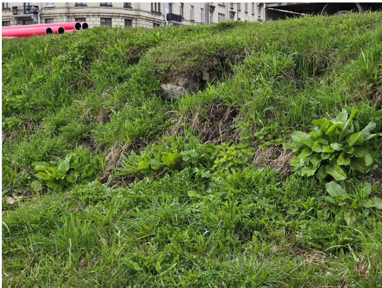
Фото 116. Воздействие суффозионного процесса на зону парковки вблизи бровки склона вдоль набережной Адмирала Лазарева у д. 24 Петроградского района г. Санкт-Петербурга
