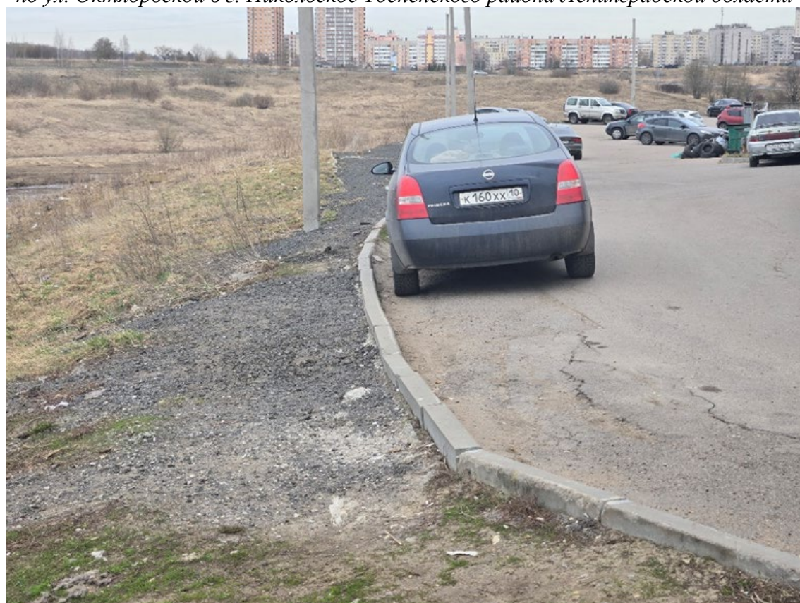
Фото 90. Деформация парковочной территории ЖК Прибрежный у д. 16 по ул. Октябрьской в г. Никольское Тосненского района Ленинградской области
