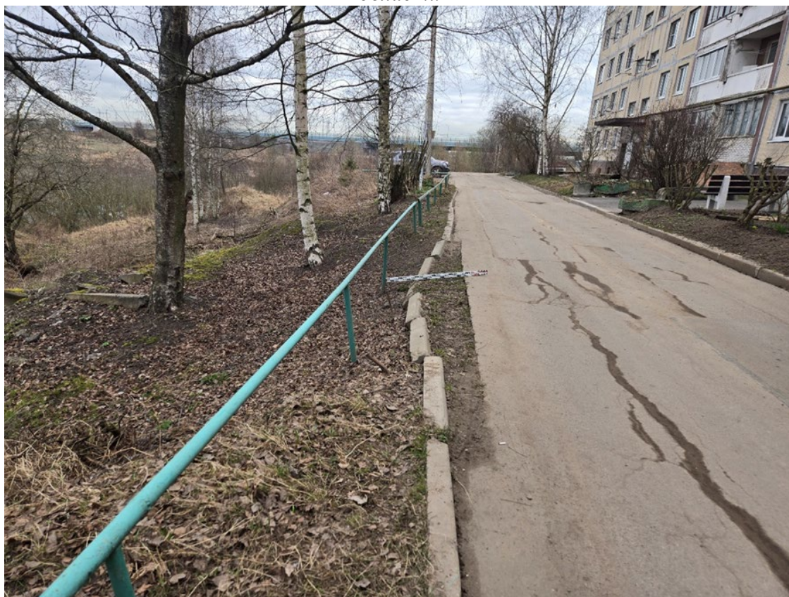
Фото 88. Сползание бетонного поребрика в сторону склона перед д. 6 в пгт. Войскорово Тосненского района Ленинградской области
