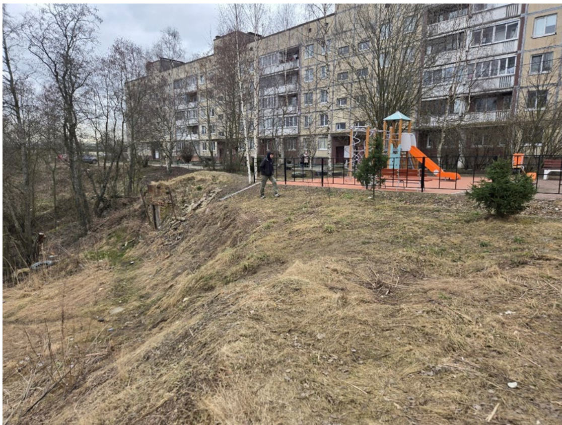
Фото 87. Вид на оползневой склон перед д. № 6 и расположение бровки отрыва склона вблизи новой детской площадки в пгт. Войскорово Тосненского района Ленинградской области
