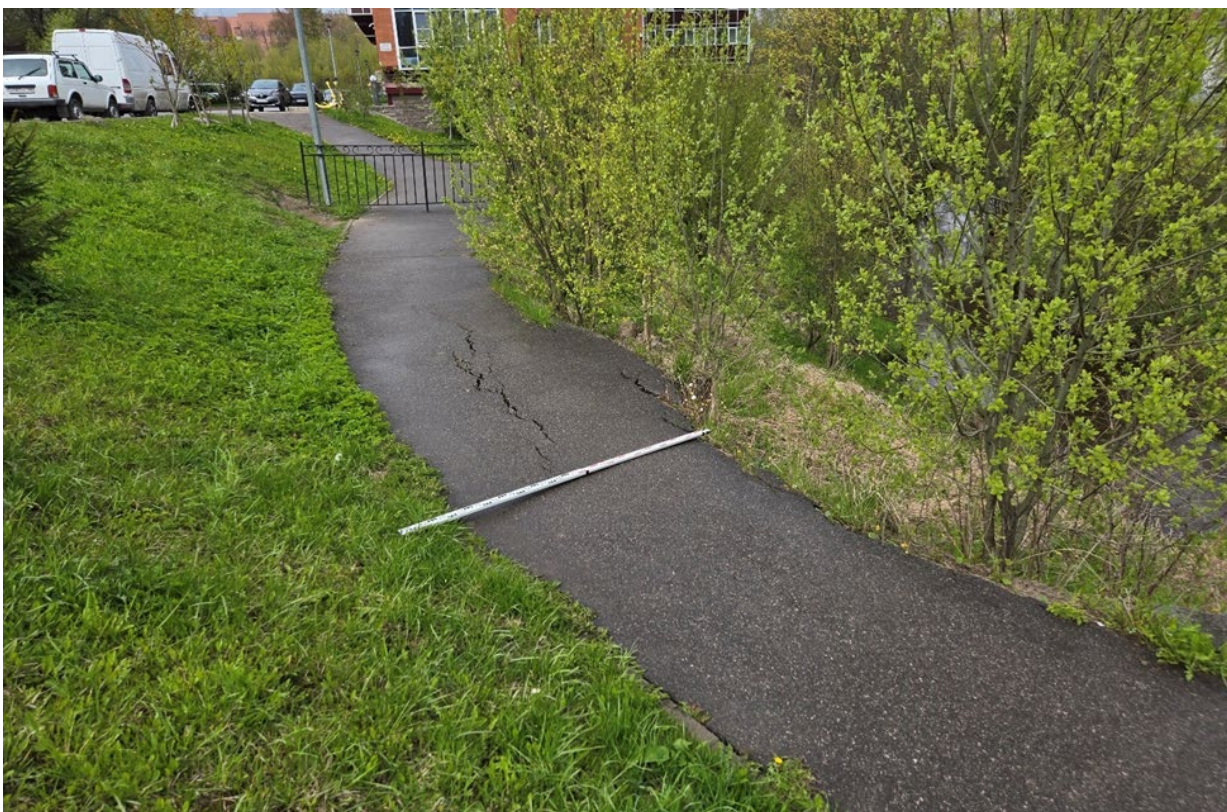
Фото 119. Разрушение асфальтированной пешеходной дорожки в пределах проявления со стороны входа на прогулочную придомовую дорожку вблизи д. 7 по 6-й Жерновской ул. Красногвардейского района г. Санкт-Петербурга в 2025 г.
