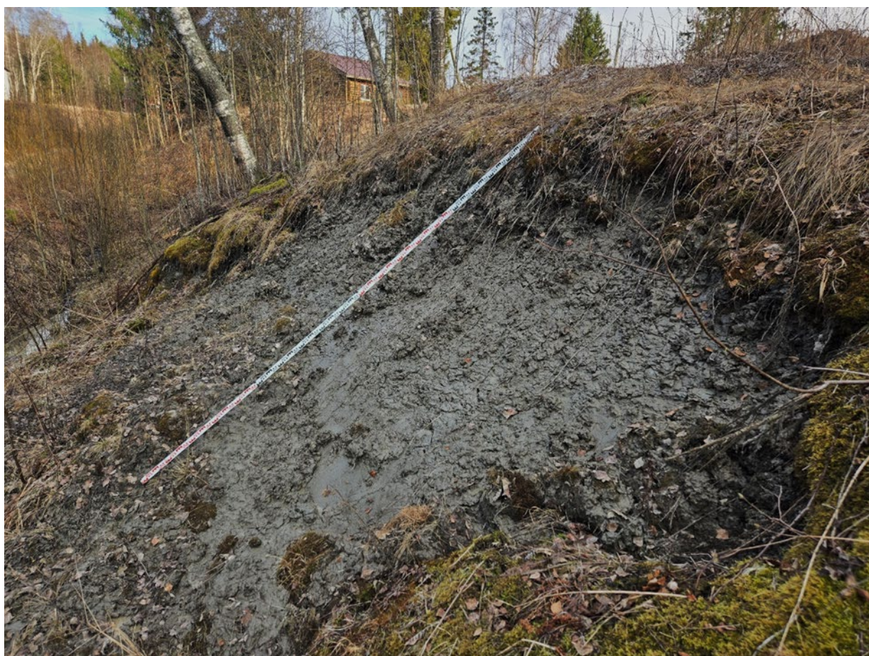
Фото 7, 8. Свежий оползень на склоне дороги, ведущей к реке, вблизи турбазы.
