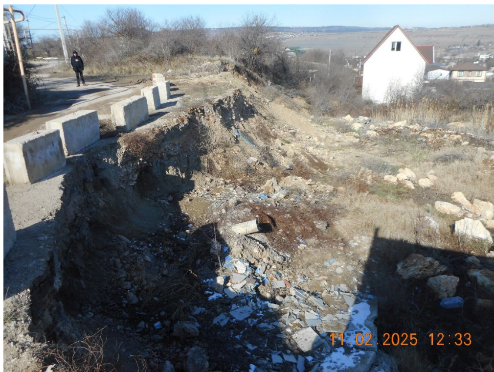
Фото № 92.11.00003. Блоки бетонного ограждения по ул. Б. Хмельницкого в 1 квартале 2025 г. (11.02.2025 г.) (Фото ГБУ Севастополя «Экоцентр»)
