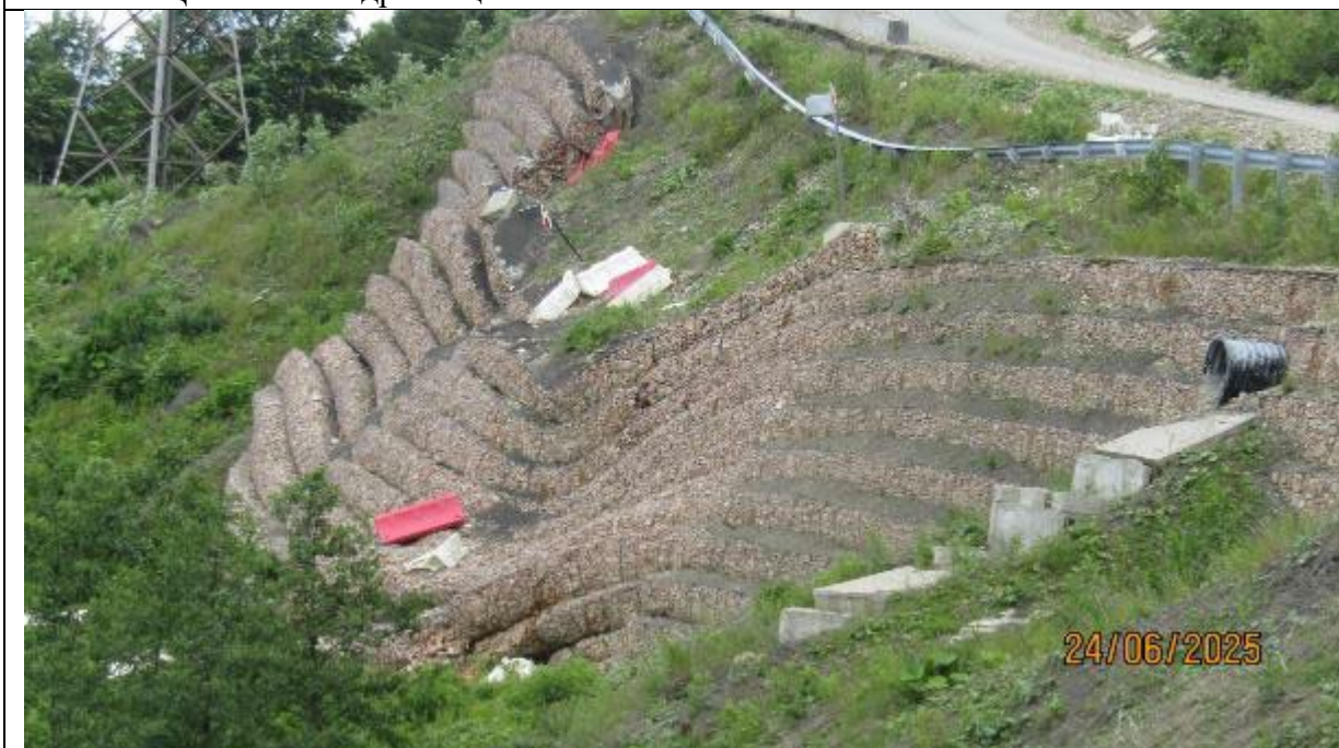
Фото 01-11-00033. Активный оползневой процесс в верховьях р. Бзыха в низовом откосе строящейся автодороги Гузерипль – Лаго-Наки Фото ЮРЦ ГМСН «Гидроспецгеология»
