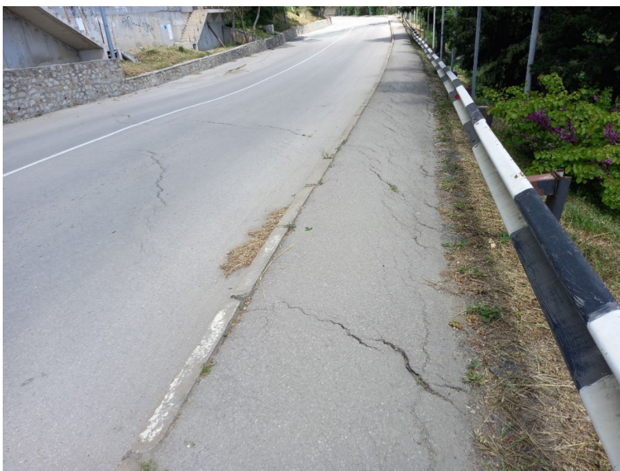
Фото 8. Проявление 91-11-04401. Левый борт оползня № 69/263. Трещины и деформации на дорожном полотне
