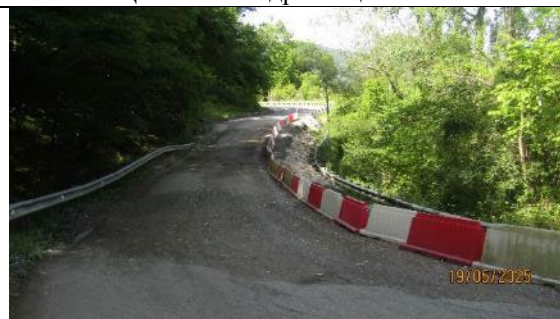
Фото 23-11-00652. Разрушение дорожного покрытия на отрезке автодороги 03К-452, в 0,45 км от с. Хлебороб Фото ЮРЦ ГМСН «Гидроспецгеология»
