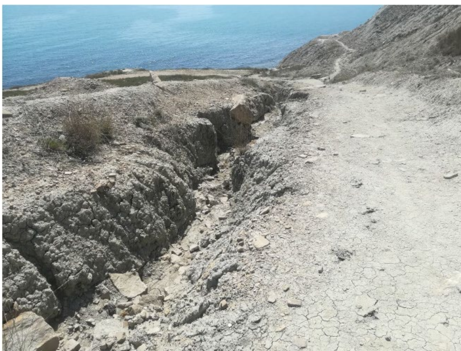
Фото 14. Проявление 91-11-06403. Эрозионный размыв стенки срыва, вымывание осыпного материала
