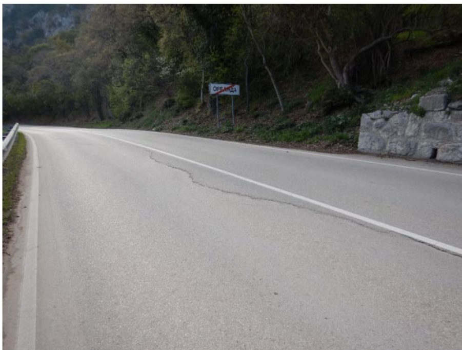
Фото 7. Проявление 91-11-03401. Увеличение деформации на асфальтовом покрытии Севастопольского шоссе, приуроченные к головной части оползня
