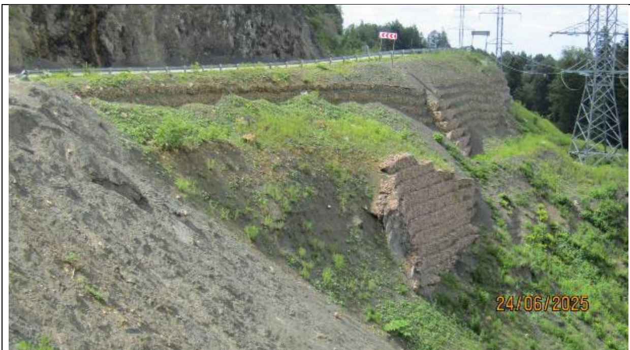
Фото 01-10-00032. Активный оползневой процесс в верховьях р. Бзыха в низовом откосе строящейся автодороги Гузерипль – Лаго-Наки Фото ЮРЦ ГМСН «Гидроспецгеология»
