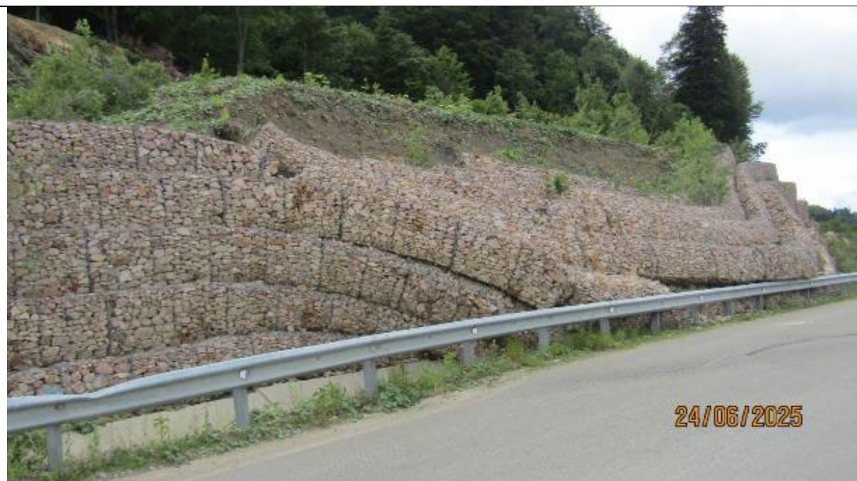
Фото 01-11-00036. Разрушение защитной стенки в верхнем откосе строящейся автодороги Гузерипль – Лаго-Наки. Фото ЮРЦ ГМСН «Гидроспецгеология»
