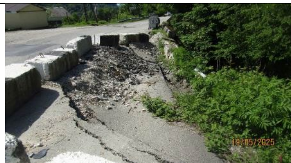
Фото 23-11-00494. Разрушение дорожного на южной окраине с. Хлебороб по ул. Центральной Фото ЮРЦ ГМСН «Гидроспецгеология»
