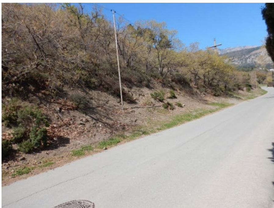
Фото 6. Проявление 91-11-02303. Верховой склон и деформации асфальтового покрытия в районе левого борта оползня №1719
