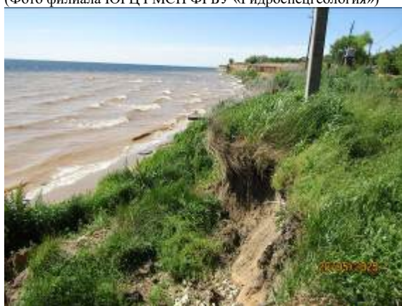
Фото 34-10-00020. Обвальное проявление вдоль берегового уступа напротив с. Пичуга Дубовского района. В центральной части проявления наблюдаются обвалившиеся массы берега, под угрозой воздействия находится линия электропередач.
