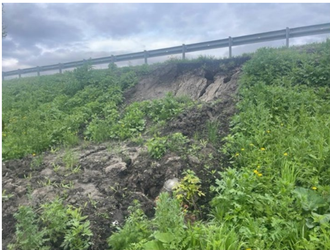
Фото 45-11-00041. Оползень на участке автодороги в г. Кургане (шоссе Тюнина)
