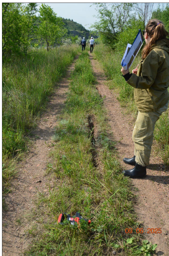
Фото 74-11-00067. Трещины бортового отпора в ТН 12. Копейский участок оперативного обследования, г. Копейск, Челябинская область
