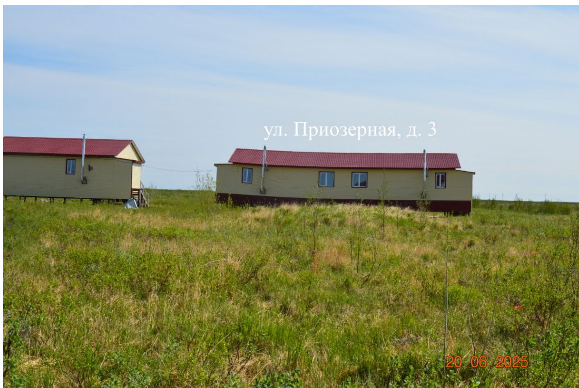
Фото 89-2025-01-001-5. Растепление фундамента на Ныдинском участке по ул. Приозерная, д. 3. Ныдинский участок ЯНАО
