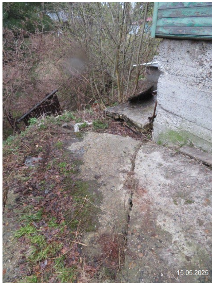
Фото 86-22-00016. Оползневой обрыв на борту оврага. Деформированная подпорная стенка жилого дома с торца здания, г. Ханты-Мансийск, ул. Садовая 1. Ханты-Мансийский участок, ХМАО-Югра
