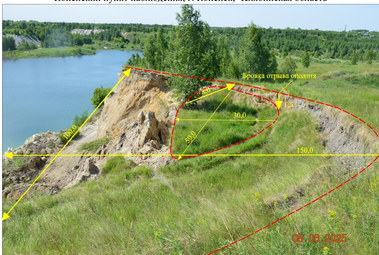
Фото 74-11-00268. Новый оползень на борту карьера в ТН 25а. Копейский пункт наблюдения, г. Копейск, Челябинская область
