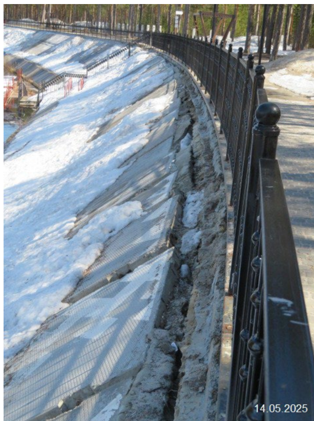
Фото 86-11-00144. Набережная р. Ингу-Ягун, в октябре 2023 г. зафиксирована деформация плит набережной с частичным сползанием в реку. После ремонта в 2024 г. при обследовании 14.05.2025 г. выявлены свежие трещины. Когалымский участок, ХМАО-Югра
