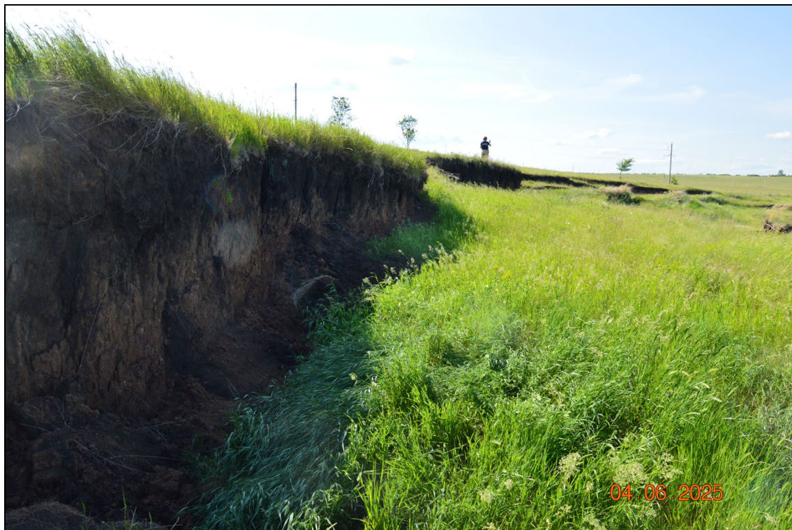
Фото 74-11-00267. Активизация оползневого процесса на правом борту Верхнеуральского водохранилища. Бровка отрыва оползня. Челябинская область
