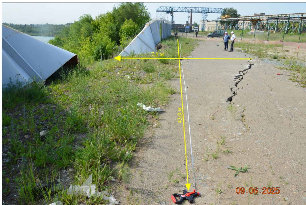
Фото 74-11-237. Новый блок оползания на территории предприятия в ТН 15а на территории АО «Копемаш». Копейский участок оперативного обследования, г. Копейск, Челябинская область
