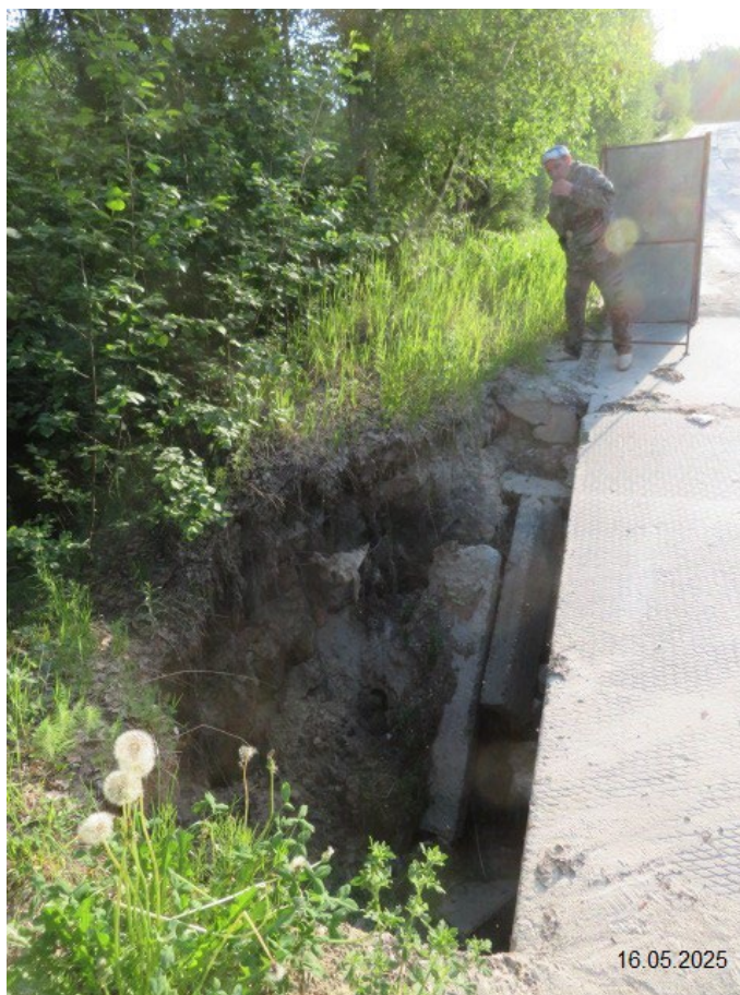
Фото 86-17-00153. 16.06.2025 г. Активизация суффозии на ул. Дорожной, п. Горноправдинск, Ханты-Мансийский район, ХМАО-Югра
