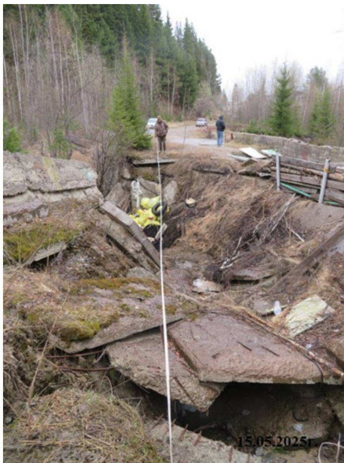
Фото 86-22-00038. Проявление овражной эрозии, разрушенный мост через овраг. Бывшая база РЭБ флота. Участок ул. Сутормина, Ханты-Мансийский участок, ХМАО-Югра
