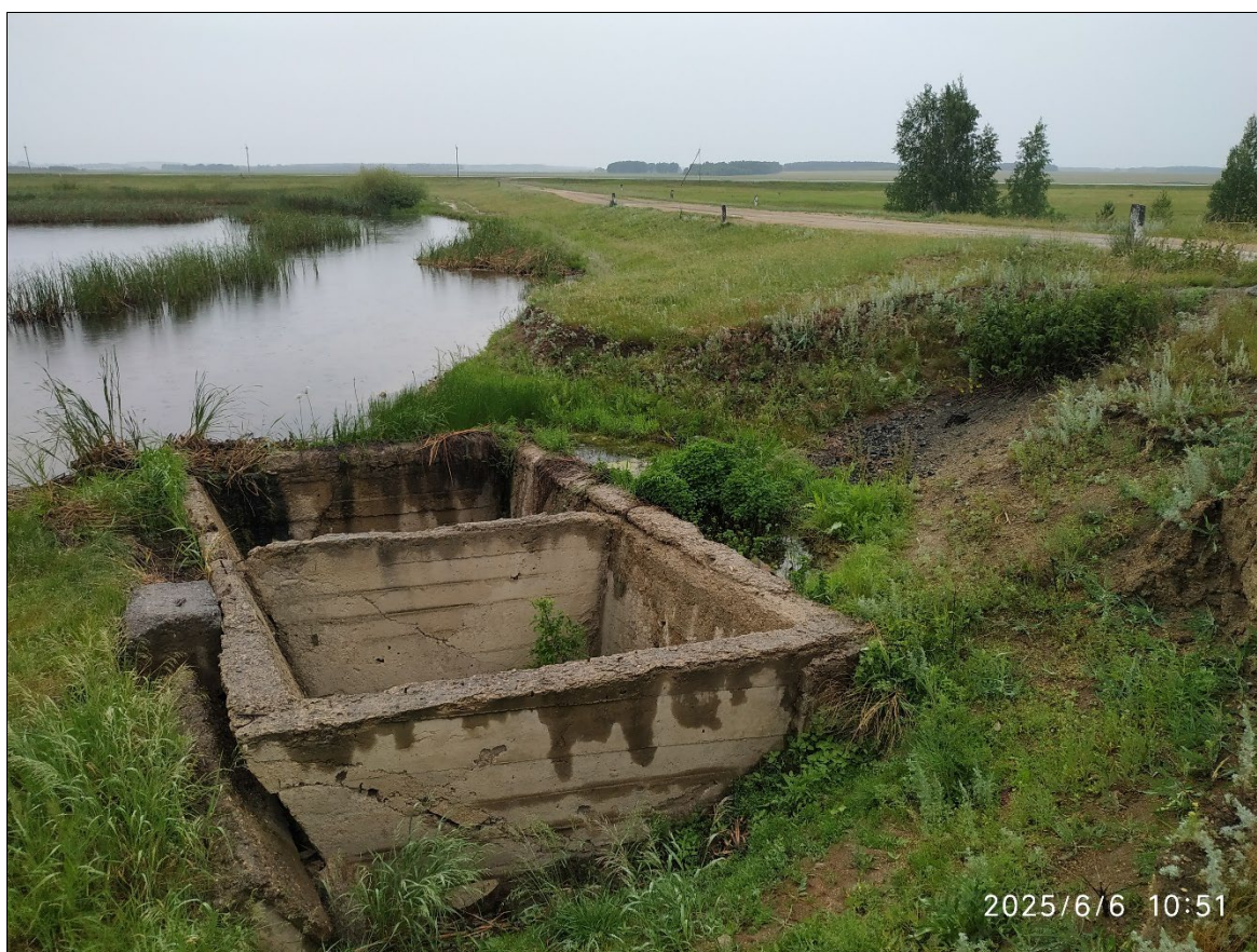
Фото 74-2025-01-001-2. Эрозионный процесс в районе водоприемника на участке дамбы. в ТН 2. Чесменский плановый участок, Челябинская область
