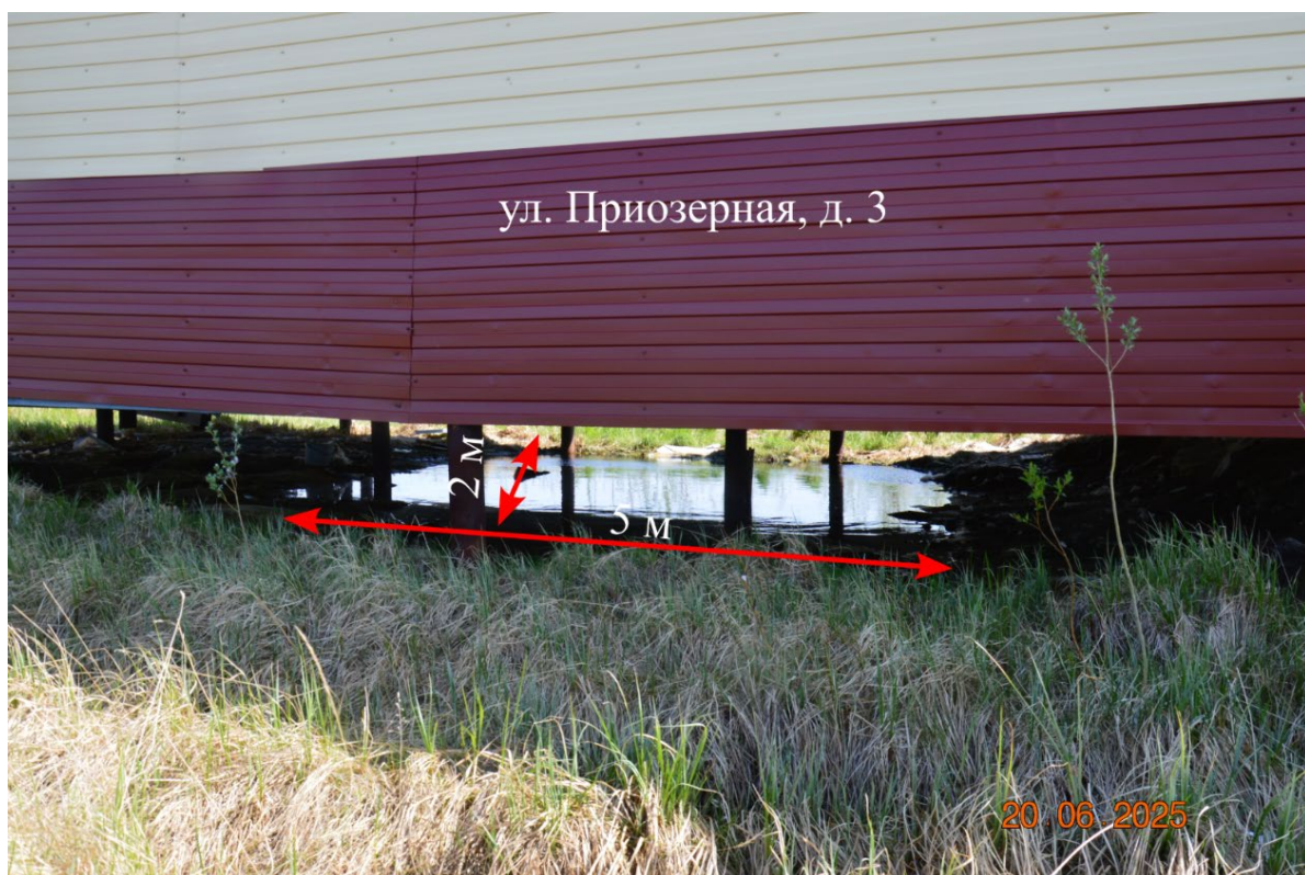
Фото 89-2025-01-001-5. Образование термокарстового процесса в результате растепления фундамента в с. Ныда по ул. Приозерная, д. 3. Ныдинский участок ЯНАО
