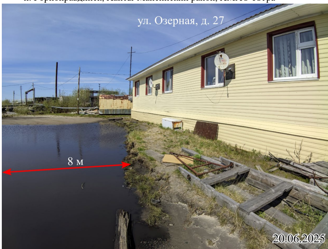
Фото 89-2025-01-001-1. Участок подтопления в с. Ныда по ул. Озерная, д. 27. Ныдинский участок ЯНАО
