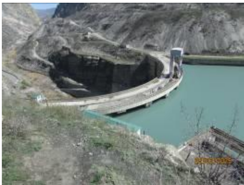
Фото 05-11-00001. Оползень в районе Миатлинской ГЭС Кизилюртовский район, Миатлинский участок Фото ООО «Даггеомониторинг»
