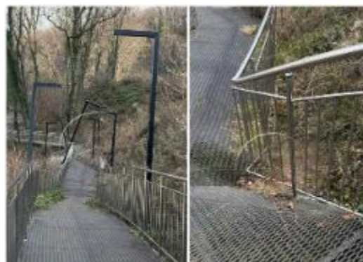
Фото 23.11.00648. Деформированная оползнем пешеходная дорожка в мкр.Бытха(город-курорт Сочи).
