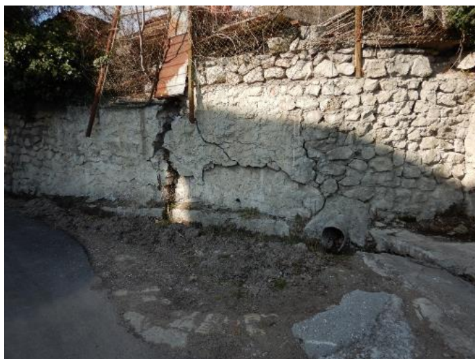
Фото 3. Проявление 91-11-01101 . Разрушение подпорной стены, приуроченные к левому борту головной части оползневого очага
