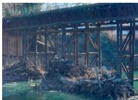
Фото 23.11.00291. Активизация оползневого процесса в с.Лермонтово Туапсинского района. Деформации моста.
