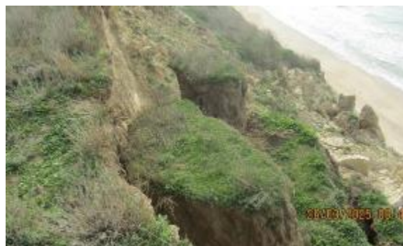
Фото 23-11-00034. Активизация оползневого процесса на восточной окраине коттеджного поселка Янтарный берег (участок побережья Черного моря в п. Веселовка).
