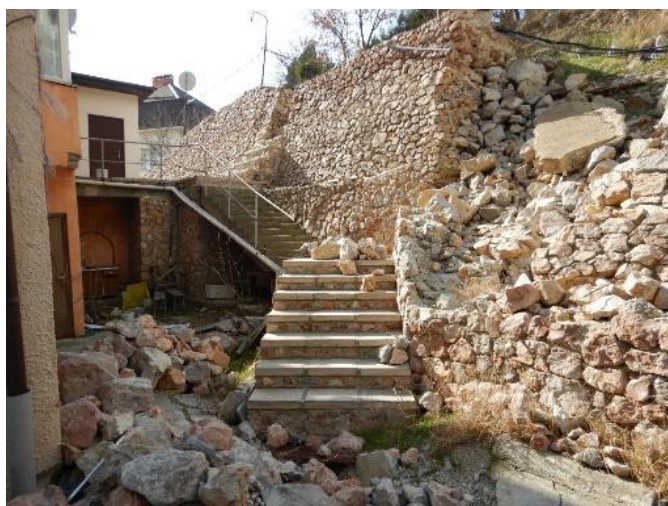
Фото 1. Проявление 91-11-01101 . Обрушение подпорной стены в районе правого борта оползневого очага
