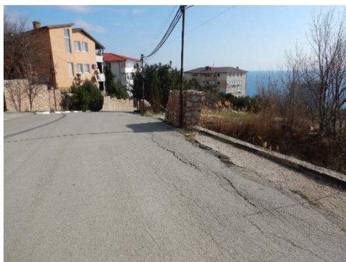
Фото 4. Проявление 91-11-01101 . Деформации автодороги по ул. Северная, приуроченные к головной части оползневого очага, ширина раскрытия 2 см
