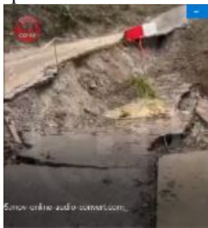
Фото 23.11.00649. Оползневое воздействие на автомобильную дорогу в с. Веселое Адлерского района города-курорта Сочи.
