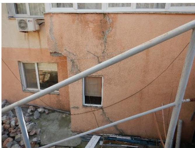
Фото 2. Проявление 91-11-01101 . Деформации на стене здания в районе правого борта оползневого очага
