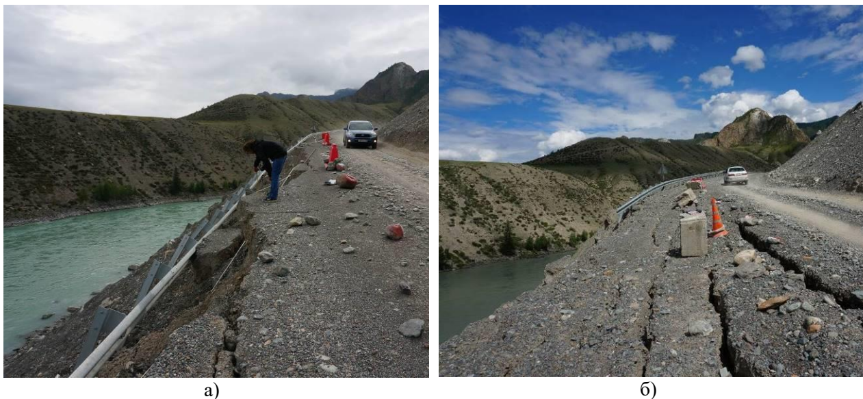
Рис. 2.32 Разрушаемый верхний участок дороги в с. Инегень в 2016 г. (а) и 2017 г. (б), Республика Алтай
