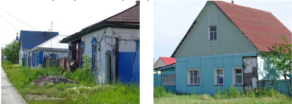
Рис. 2.37 Разрушение домов по ул. Садовая, К. Маркса, г. Барабинск, Новосибирская область
