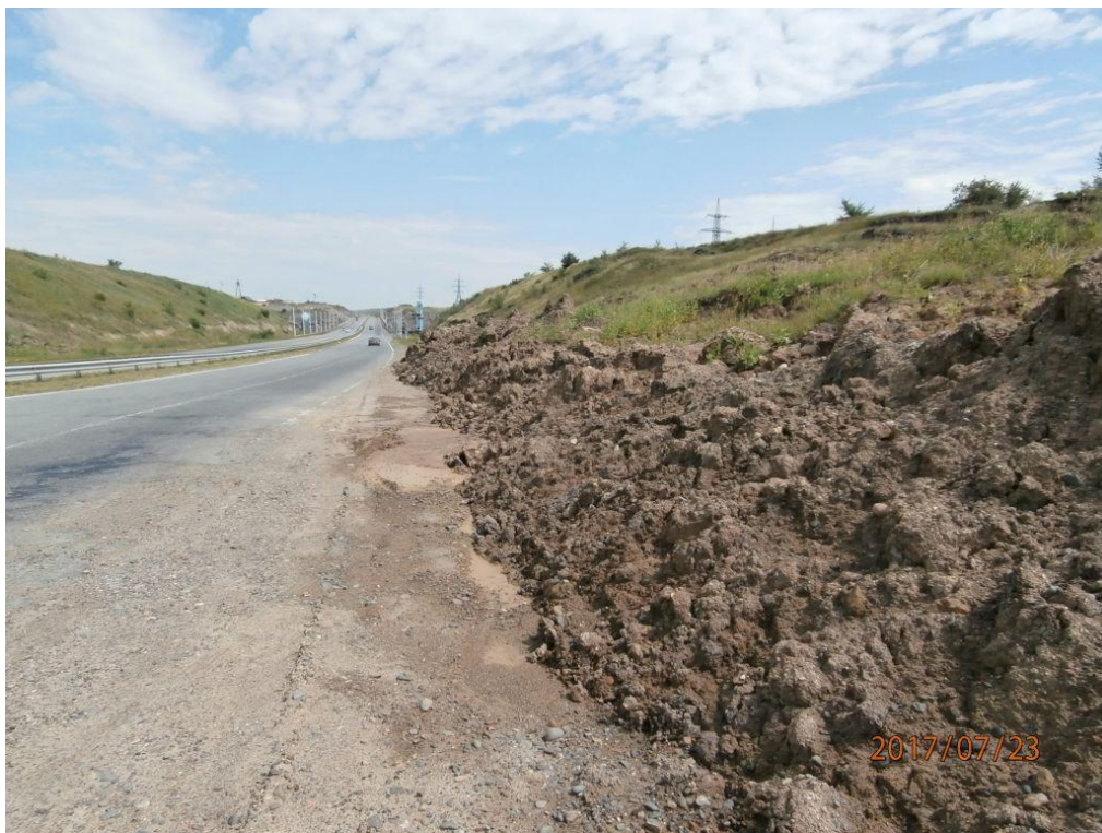
Рис. 2.25 Вывалы оползневых масс на трассу М-54 в районе Братского моста, Республика Хакасия
