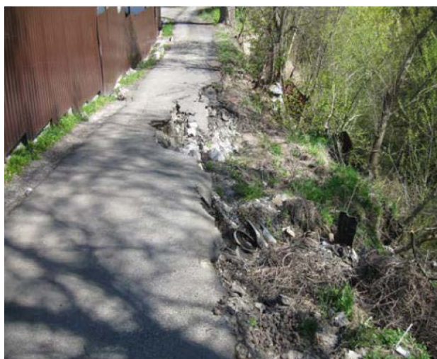
Рис. 2.6 Деформированное асфальтированное дорожное покрытие в результате оползнеобразования по ул. Фабричная, д. 45/1, г. Брянск
