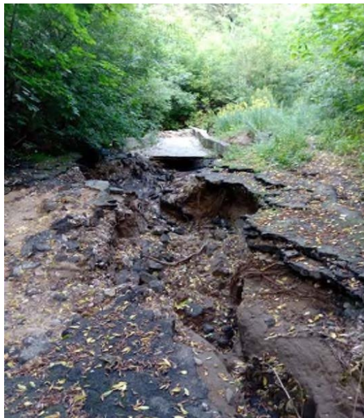
Рис. 2.7 Деформированное асфальтированное дорожное покрытие на территории памятника природного значения овраг «Верхний Судок» по ул. Топальской, Нижний Судок» по ул. Грибоедова, Советский район, г. Брянск
