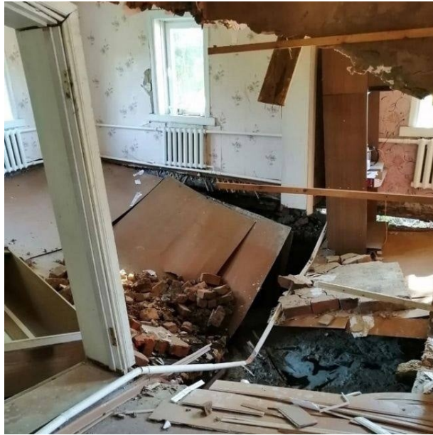
Рис. 2.10 Карстово-суффозионный провал, ул. Маяковского д. № 102, г. Новозыбков, Брянская область.
