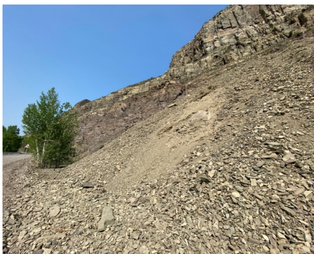
Рис. 2.2.141 Осыпи на участке автодороги Кызыл – Баян-Кол, 23 км, Кызылский район, Республика Тыва
