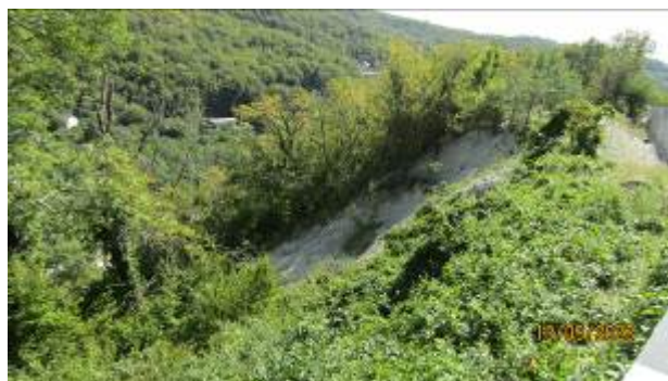
Рис. 2.2.56. Головная часть блоково-консистентного оползня в низовом откосе автодороги А147 в районе с Дедеркой, Туапсинский МО, Краснодарский край
