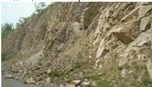
Рис. 2.2.167. Обвально-осыпной склон на 146 км автодороги А-370. Вяземский район, Хабаровский край
