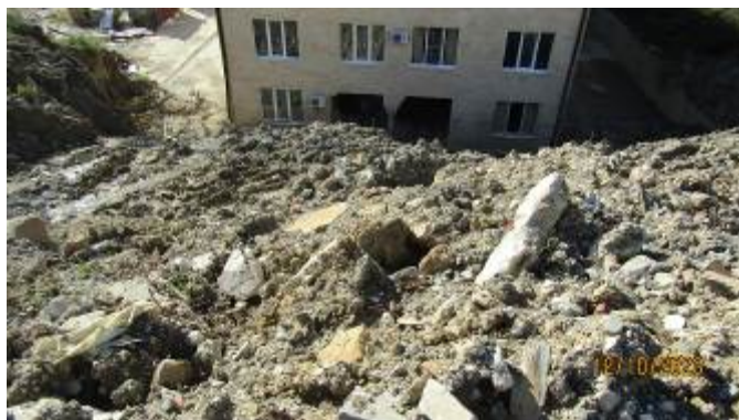
Рис. 2.2.58. Языковая часть оползня с включениями обломков строительных конструкций и мусора, ул. Яна Фабрициуса, 66/6, Хостинский район, Краснодарский край
