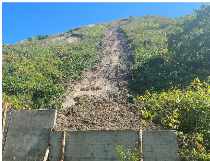
Рис. 2.2.170. Поврежденная подпорная стенка в результате активизации оползневой процесса по ул. Школьная. г. Невельск, Сахалинская область
