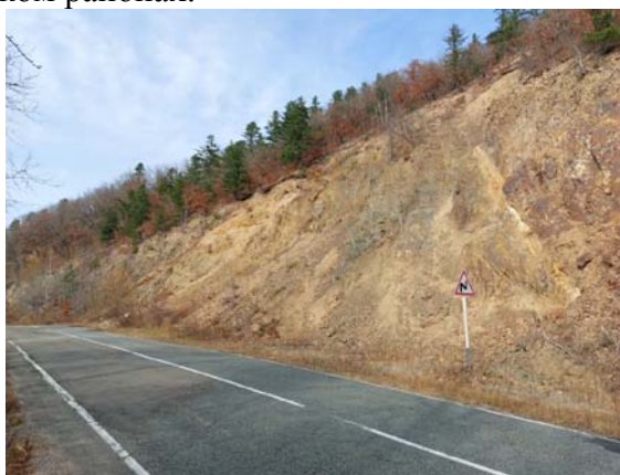
Рис. 2.2.166. Осыпной склон на участке автодороги автодороги Находка-Кавалерово, 309,5 км. Приморский край
