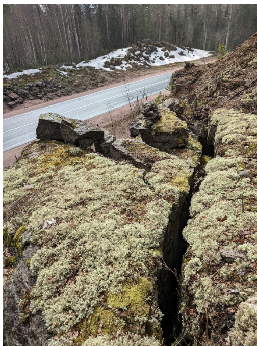
Рис. 2.2.7. Проявления обвального процесса вдоль трассы А-121 Сортавала на участке от д. Юргилица до д. Кясняселькя Пряжинского района, 370 км, Республики Карелия
