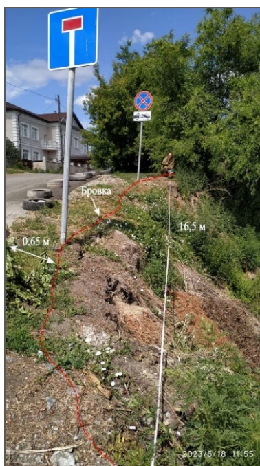
Рис. 2.2.116. Бровка оползневого склона на ул. Фридриха Энгельса. г. Тюмень, Тюменская область
