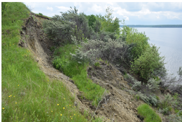
Рис. 2.2.38 Оползень, юго-западная окраина с. Столпино, левобережный склон р. Волга, Кадыйский район, Костромская область
