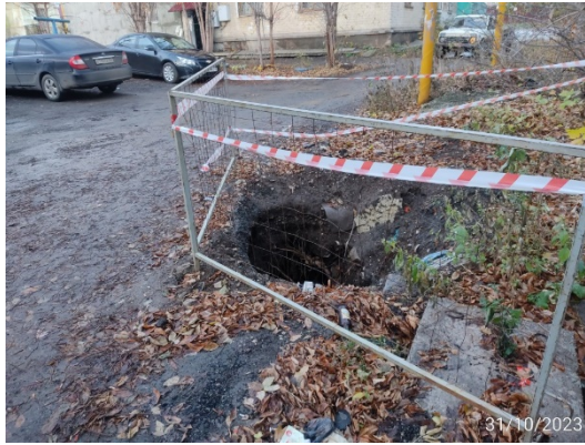
Рис. 2.2.102. Провал в 17 метрах западнее дома №2а по ул. Уфимской, г. Самара, Самарская область
