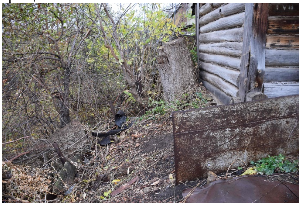
Рис. 2.2.88. Бровка оползня у дома по ул. Чапаева, 14, г. Чистополь, Республика Татарстан
