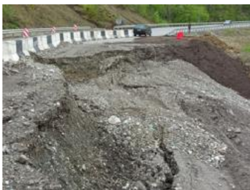
Рис. 2.2.74. Оползень на автодороге Зилга – Моздок, Моздокский район, Республика Северная Осетия – Алания
