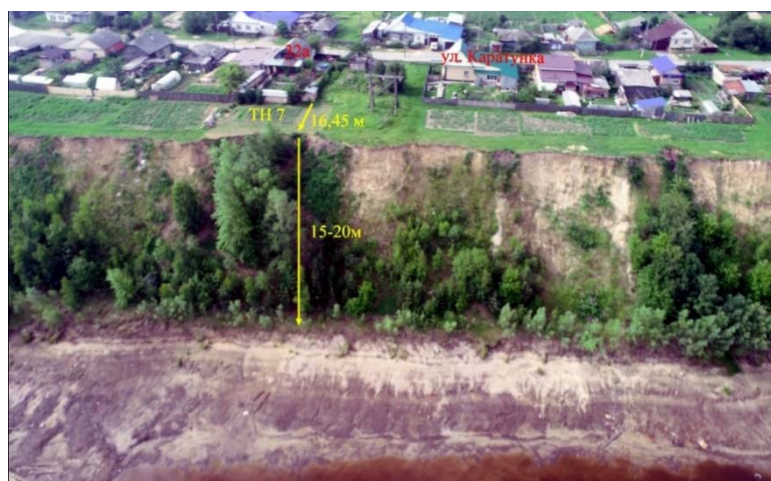
Рис. 2.2.111. Общий вид гравитационного склона в створе дома № 32а по ул. Каратунка, п. Заморозково. Свердловская область
