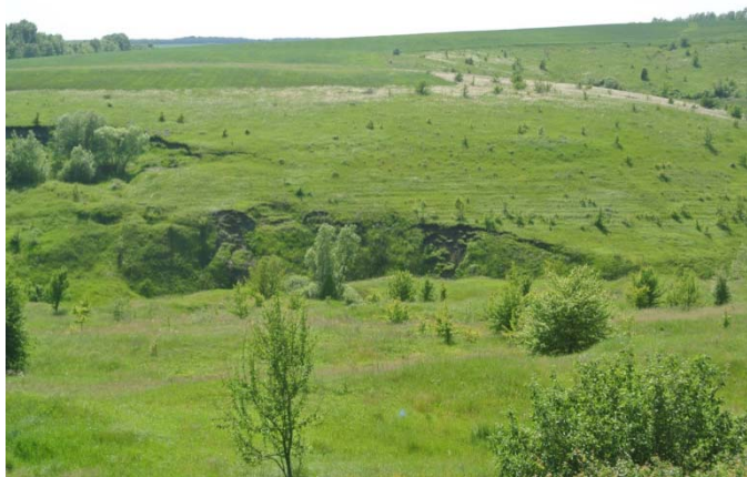
Рис. 2.2.34. Оползень в нижней части западного склона балки Калиново, северо-восточнее х. Яснев, Белгородская область
