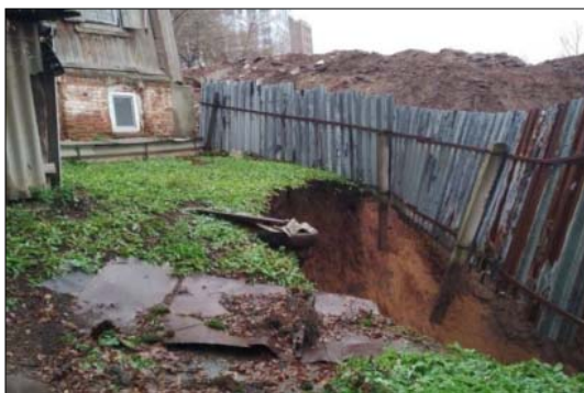
Рис. 2.2.85. Обрушение грунта во дворе частного дома по ул. Коллективная, д. 3, г.Уфа, Республика Башкортостан
