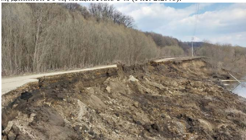
Рис. 2.2.46 Оползень, пос. Мичурина, МО Алексин, Тульская область
