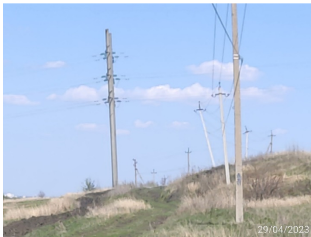
Рис. 2.2.101. Основание оползневого склона. Деформированная грунтовая автодорога и опоры ЛЭП. п. Кашпир, г.Сызрань, Самарская область
