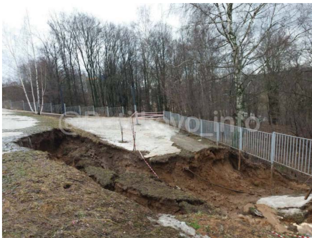
Рис. 2.2.43 Оползневой процесс в Московской области, Красногорском городском округе, д. Путилково, территория Православного Храма Архангела Михаила.
