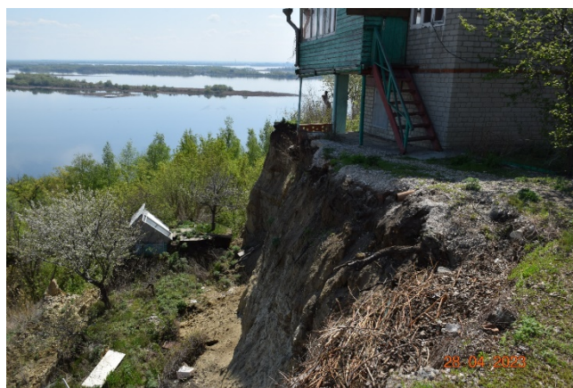
Рис. 2.2.104. Стенка срыва с вертикально смещенным блоком оползня в п. Зональный, г. Саратов, Саратовская область
