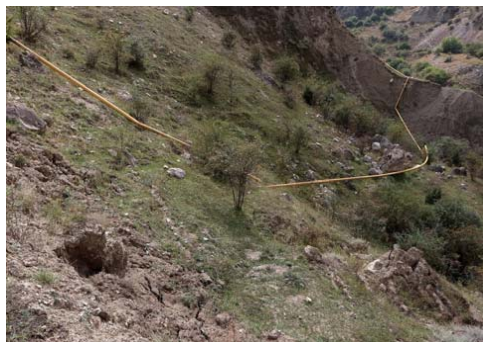
Рис. 2.2.71. Деформация трубы газопровода и его опор в районе с. Верхняя Балкария. Черекский район, Кабардино-Балкарская Республика
