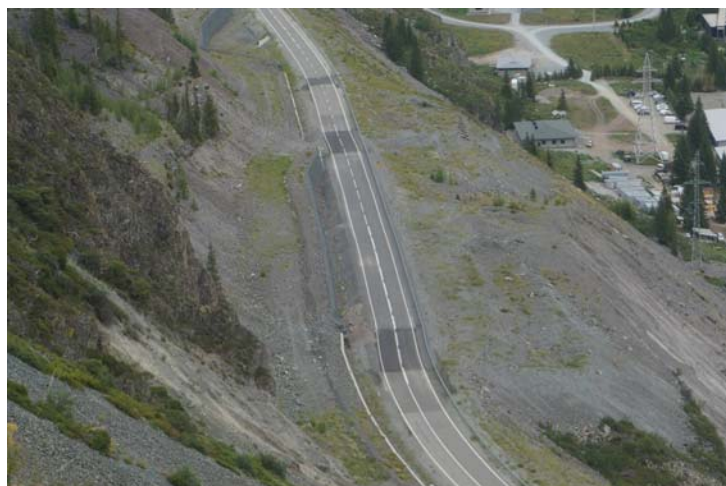
Рис. 2.2.136. Оползневой процесс на автодороге в Алтайское подворье, 20,05 км. Онгудайский район, Республика Алтай
