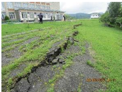
Рис. 2.2.73. Стенка срыва оползня у школы на северной окраине а. Эльтаркач, Усть-Джегутинский район, Карачаево-Черкесская Республика
