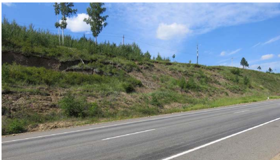
Рис. 2.2.171. Южная часть оползня на 70-м км автодороги А-167, Карымский район, Забайкальский край
