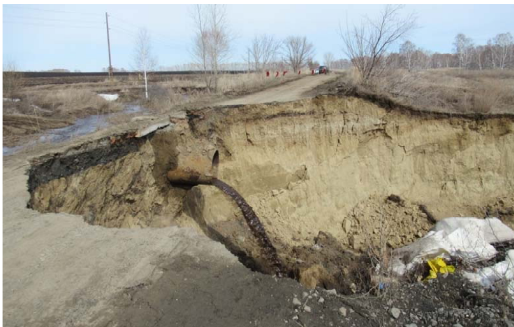
Рис. 2.2.145 Овражная эрозия на участке автодороги Логовское – Правда Первомайского района, Алтайский край
