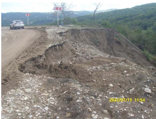
Рис. 2.2.79. Разрушение оползнем полотна автодорогис. Шуани - с. Саясан, 2,43 км, Чеченская Республика
