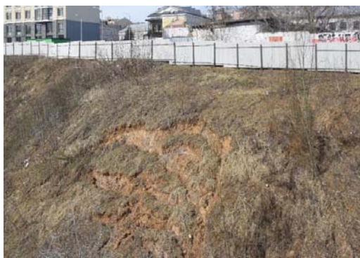
Рис. 2.2.95. Оползень на левом борту Почаинского оврага, г.Нижний Новгород, Нижегородская область
