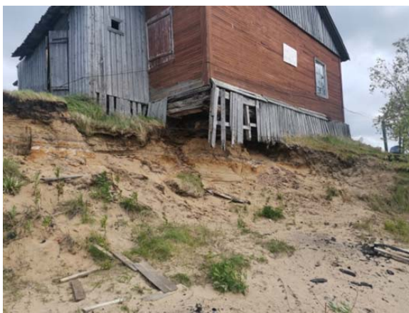
Рис. 2.2.30. Воздействие оползневого процесса на частный жилой дом. Район речного порта города Нарьян-Мар, Ненецкий АО
