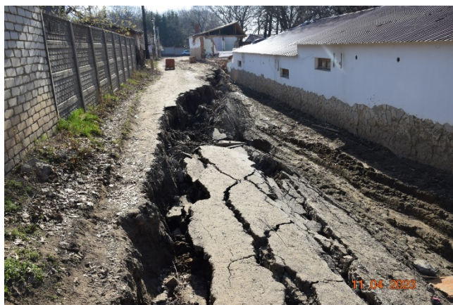
Рис. 2.2.103. Оползневая ступень. Деформация дорожного покрытия в «СНТ Журавушка», г. Саратов, Саратовская область
