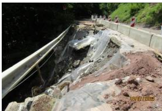
Рис. 2.2.51. Деформация дорожного полотна вследствие оползня. Майкопский район, участок автомобильной дороги А159 (79-й км), Республика Адыгея
