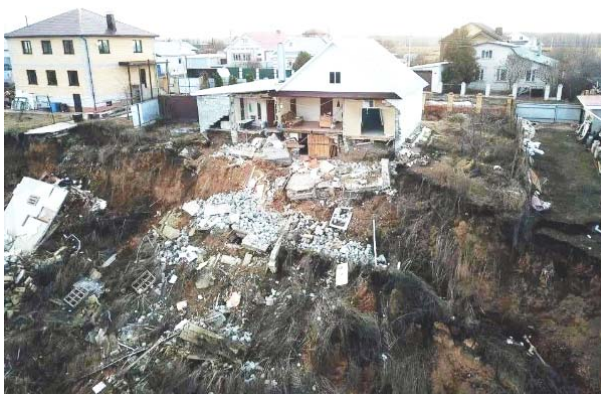
Рис. 2.2.96. Активизация оползневого процесса на борту оврага в д.Караулово, Кстовский район, Нижегородская область
