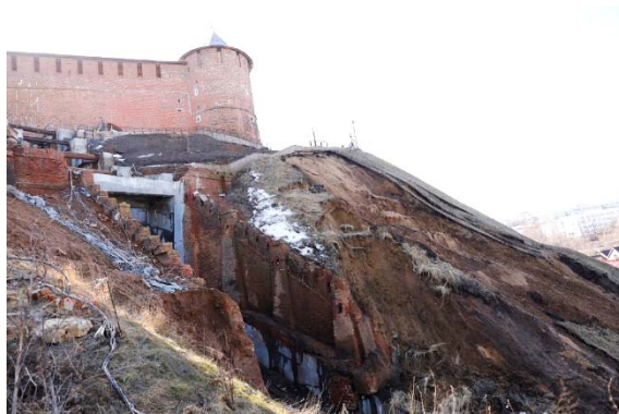
Рис. 2.2.93. Активизация оползня на борту Зеленского съезда, г. Нижний Новгород, Нижегородская область
