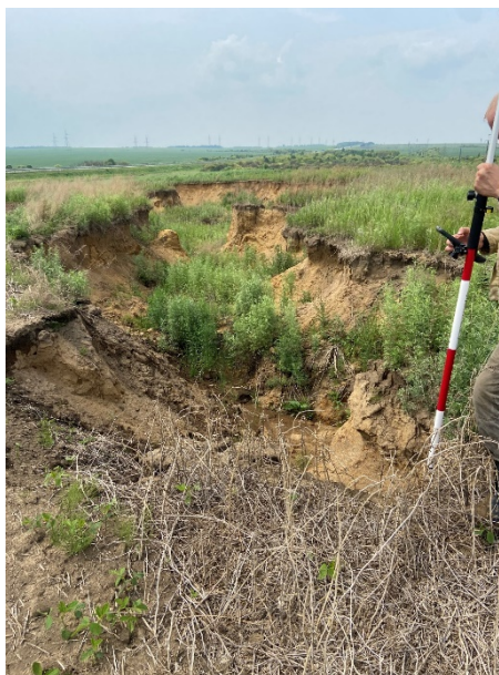
Рис. 2.2.176. Овраг на 1519 км автодороги Р-297, Октябрьский район, Забайкальский край
