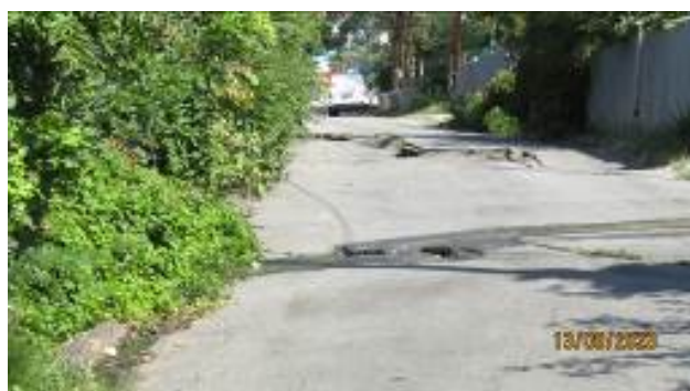
Рис. 2.2.55. Деформация дорожного покрытия на ул. Пархоменко в г. Туапсе под воздействием оползневого процесса, Краснодарский край
