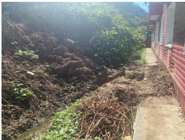
Рис. 2.43. Оползневое тело, повредившее фасад многоквартирного дома ПН Журавушка
