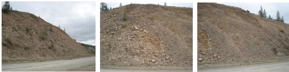
Рис. 2.41. Обвально-осыпной процесс на участке 1794,7 км автодороги Р504 «Колыма» по состоянию (п.н. «Талая»)
