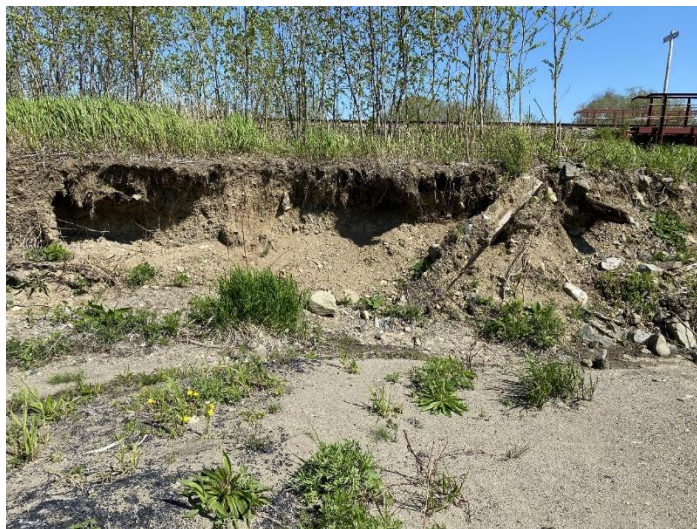
Рис. 2.44. Разрушение берегового откоса на участке Угледарский
