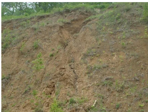
Рис. 2.24. Эрозионные процессы на 215 км А-370 В Бикинском районе
