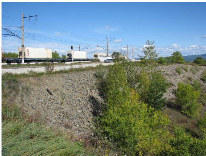
Рис. 2.57. Верхняя часть закрепленного оползневого склона Чита-Ингода, 24 км
