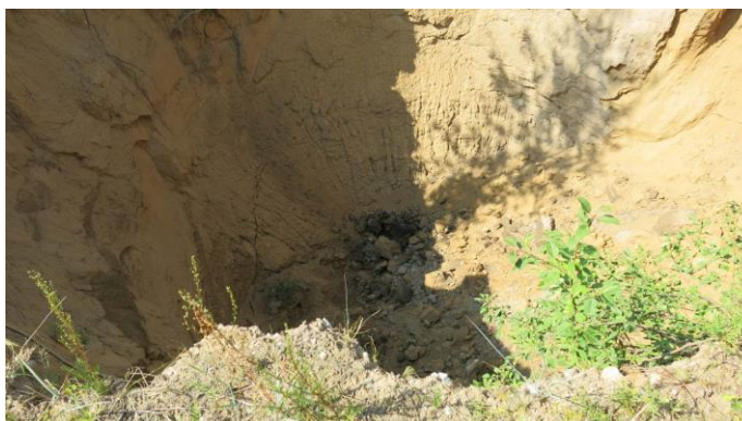
Рис. 2.50. Провал над старым шурфом
