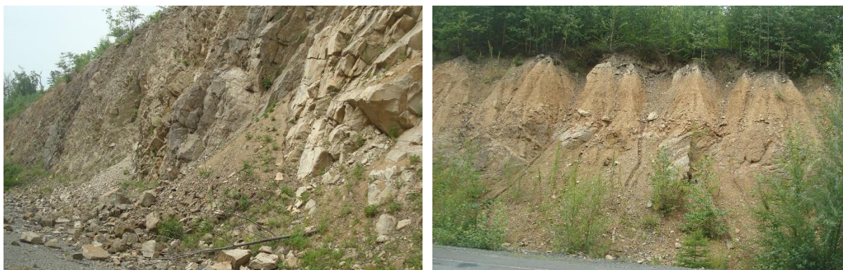
Рис. 2.26. Осыпные проявления на 146 км А 370 Вяземский район и 220 км А-376 Ванинский район
