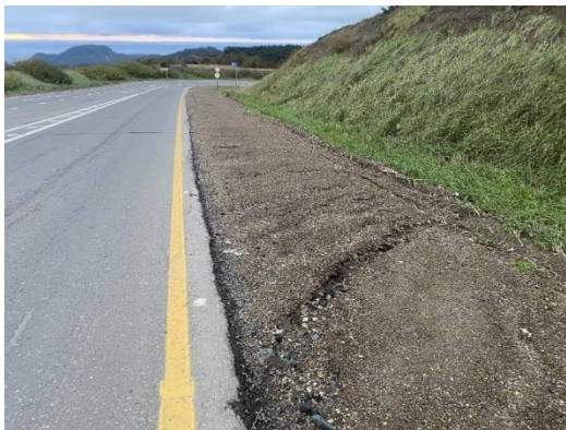
Рис. 2.47. Эрозионные борозды автодороги Южно-Сахалинск – Холмск
