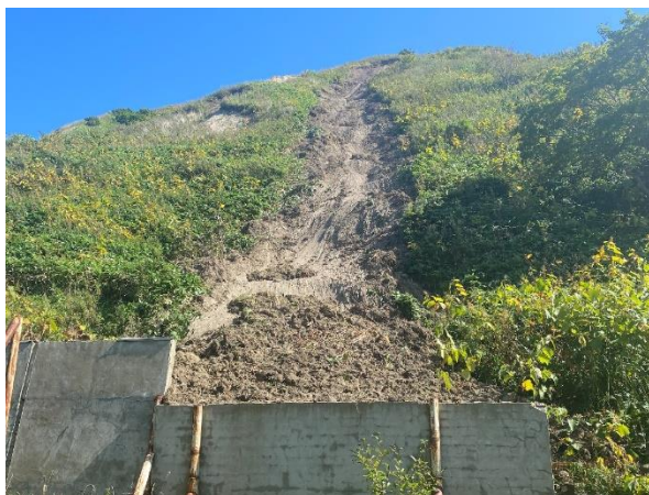
Рис. 2.42. Поврежденная подпорная стенка в результате активизации оползневой деятельности ПН Школьный.
