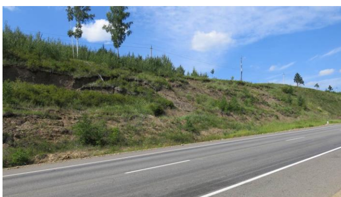
Рис. 2.51. Южная часть оползня на 70-ом км автодороги А-167
