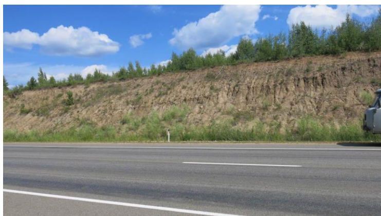
Рис. 2.52. Выположенный склон, на котором возобновилось развитие оползневого процесса
