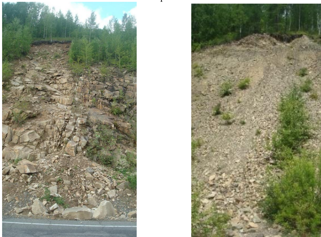
Рис. 2.28. Обвално-осыпные проявления на ПН 87 и 90 км А-376, Нанайский район
