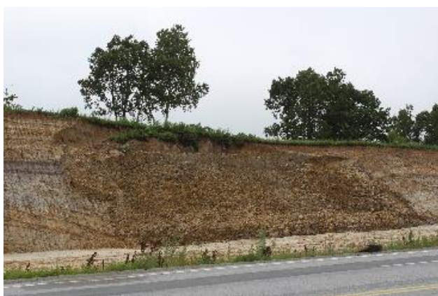
Рис. 2.17. Оползень на ПН Раздольненский 2, т. 1.
