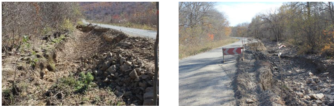
Рис. 2.23. Разрушение придорожных кюветов и дорожного полотна на участке 179,75 и 165,13 км автодороги Р-447 Находка-Ольга-Кавалерово.
