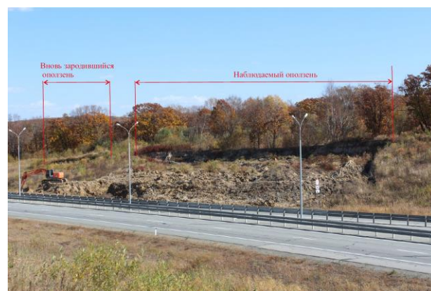
Рис. 2.18. Оползень 686,8 км автодороги А-370
