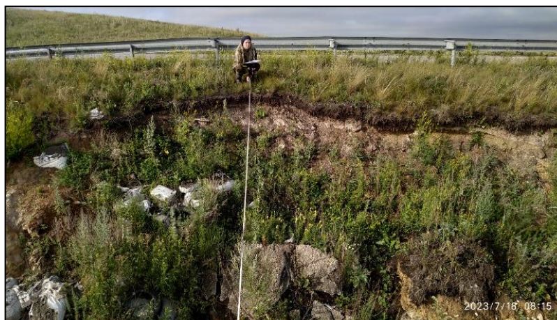
Рис. 2.52. Овраг вдоль кювета автодороги (ТН 4). Янгельский участок, Челябинская область
