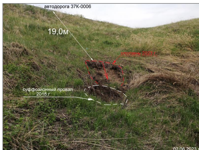
Рис. 2.12. Оползень на борту оврага в ТН № 45-22-00013. Участок Шадринский, Курганская область
