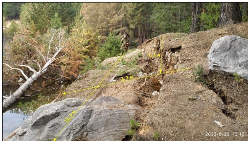
Рис. 2.50. Участок активизации оползневого процесса на борту Большого Никельского карьера в г. Верхний Уфалей, Челябинская область
