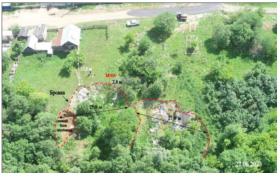
Рис. 2.43. Оползневой участок в районе дома № 30 по ул. Набережная (ТН 4). Участок Ашинский, Челябинская область
