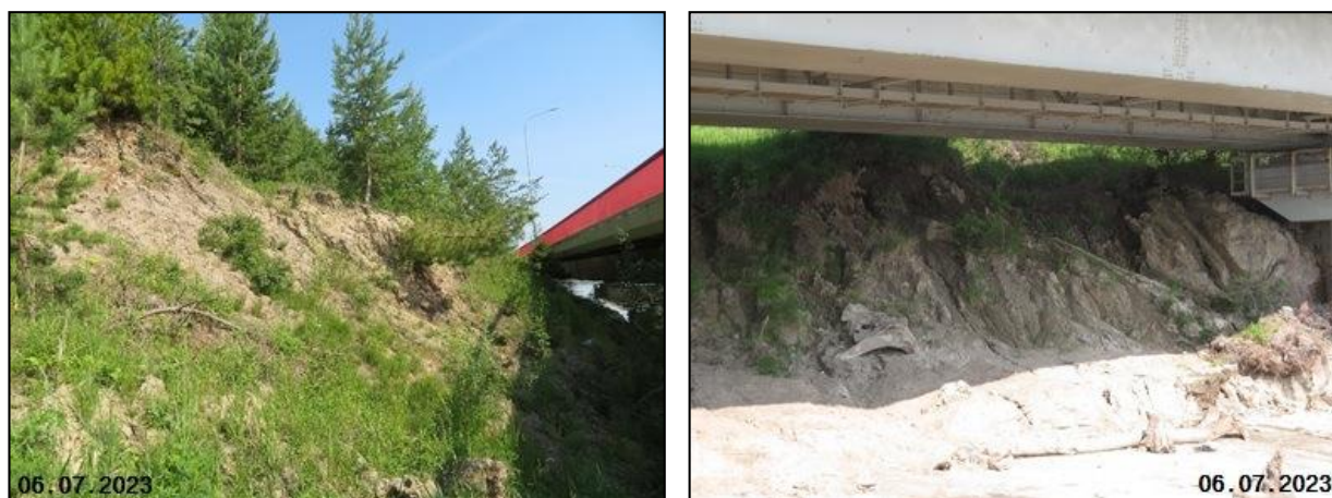
Рис. 2.53. Оползневой участок на Восточной объездной дороге (фото слева). Заполнение оползневыми массами пространства под эстакадой (фото справа). Ханты-Мансийский участок, ХМАО-Югра
