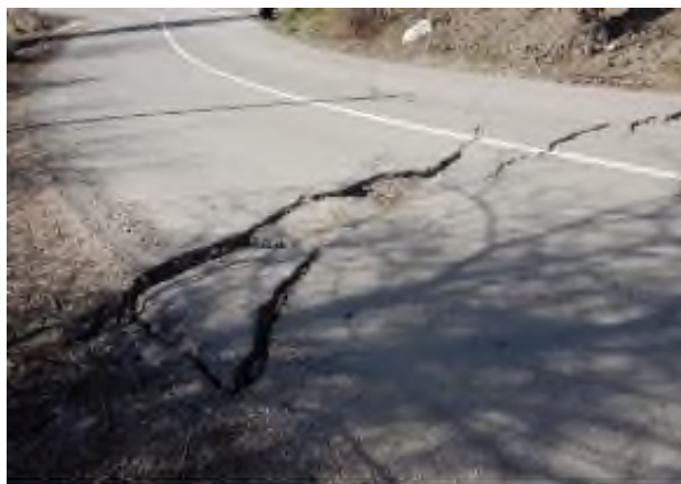
Рис. 2.2.50. Деформации асфальтового покрытия в результате активизации оползня, с. Оползневое, г.о. Ялта, Республика Крым
