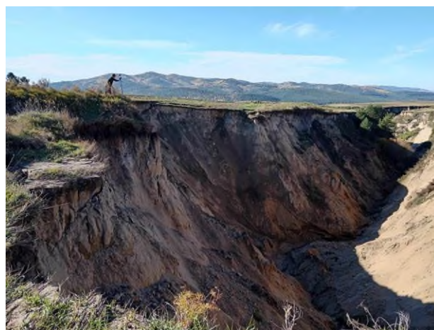
Овраг №2 Вид с вершины оврага. Оползание грунта
