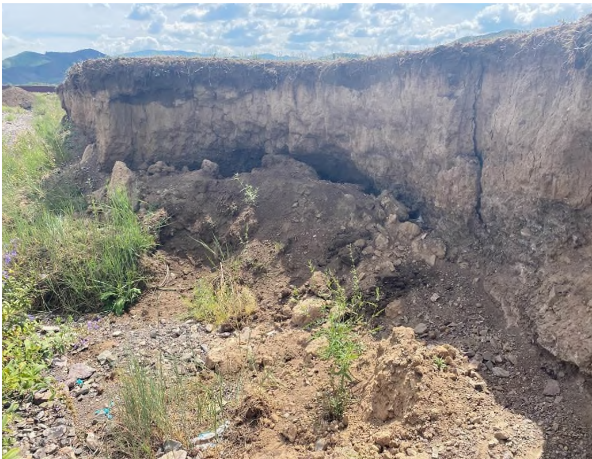
Рис. 2.2.167 Разрушение бортов оврага на пункте Уюкский в районе с. Уюк Пий-Хемского района, Республика Тыва
