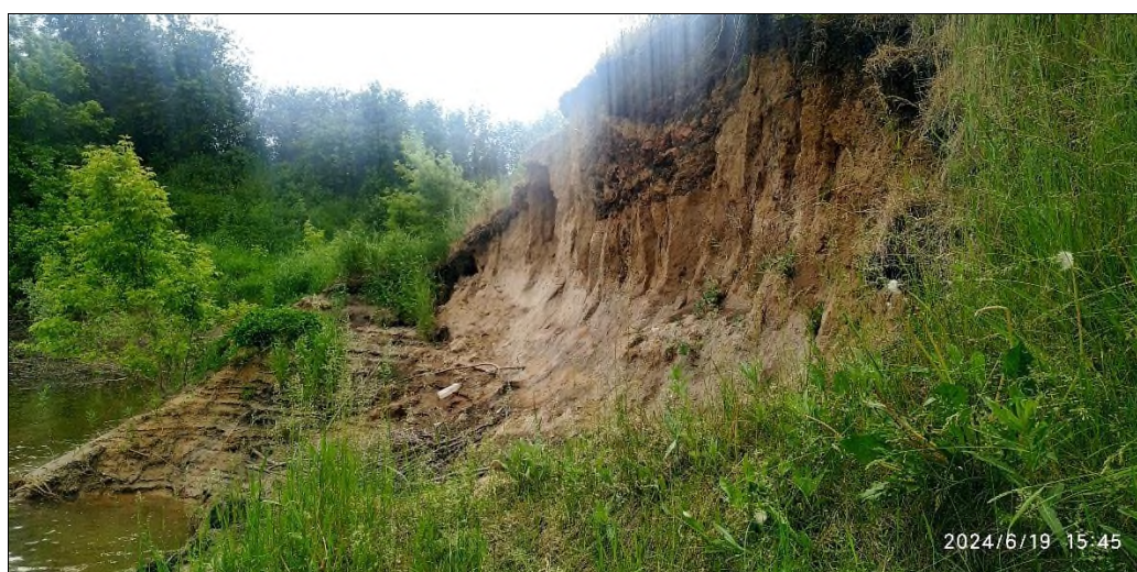
Рис. 2.2.131. Участок развития оползневого процесса вдоль ул. Береговая, на левом берегу р. Ишим. Участок Абатский, Тюменская область
