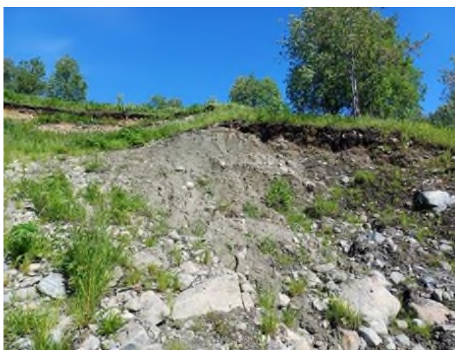
Рис. 2.2.19 Проявление оползневой процесса вблизи автобусной остановки «Контейнерная» в г. Мурманск
