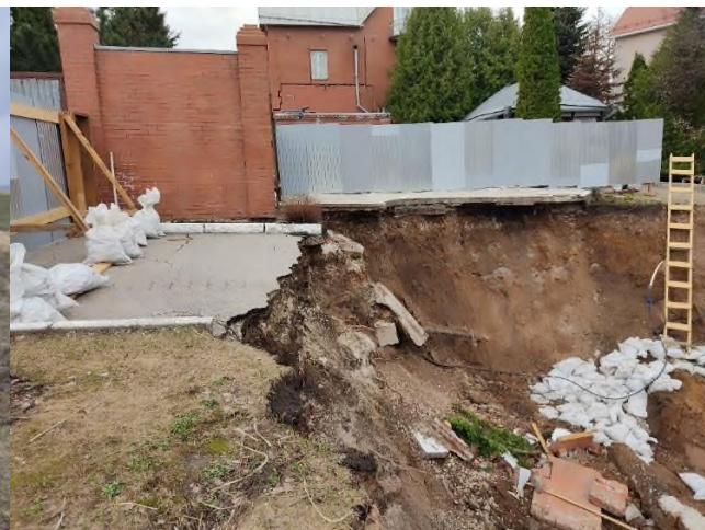
Рис. 2.2.105. Бровка надоползневого уступа и левый борт оползня на ул. Зауральская, г. Самара, Самарская область
