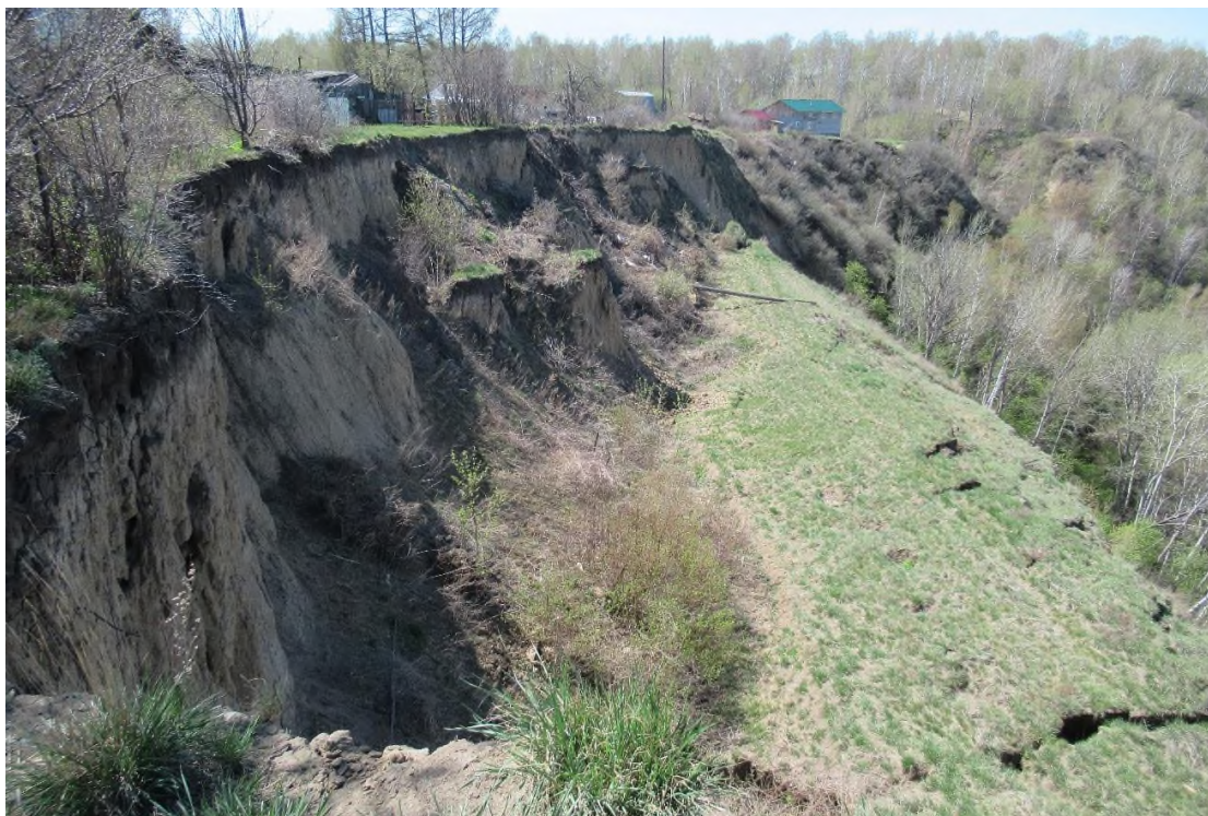
Рис. 2.2.171 Разрушение оползневого блока в СНТ «Обь». Четвёртый оползневой район, г. Барнаул, Алтайский край
