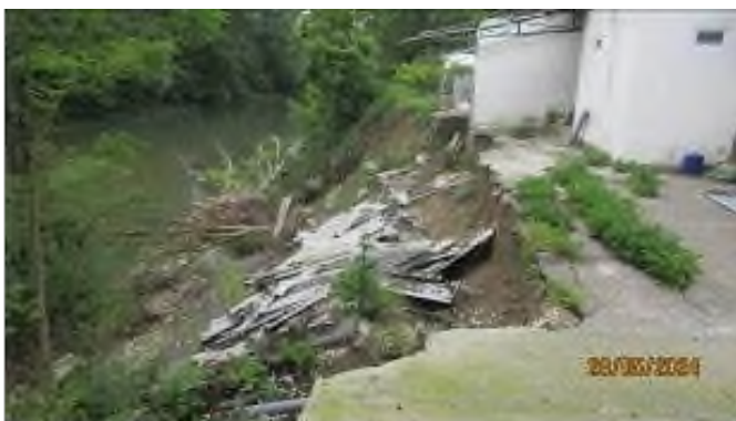
Рис. 2.2.57. Разрушение домовладения по пер. Рыбному № 20, вследствие активизации оползня на правобережном уступе р.Пшеха в г.Хадыженске, Апшеронский район, Краснодарский край
