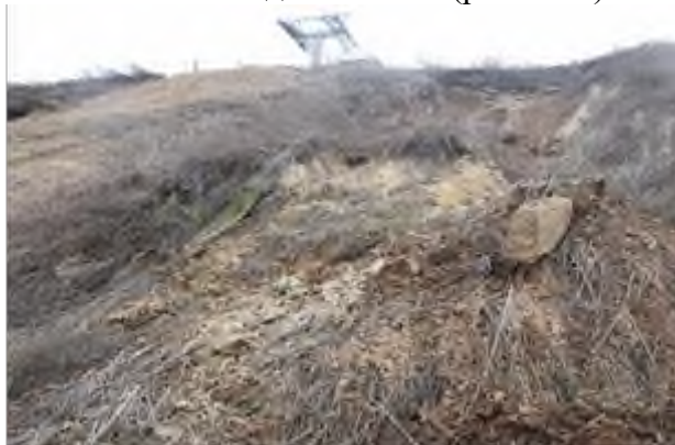
Рис. 2.2.98. Оползни под станцией канатной дороги, г. Нижний Новгород, Нижегородская область
