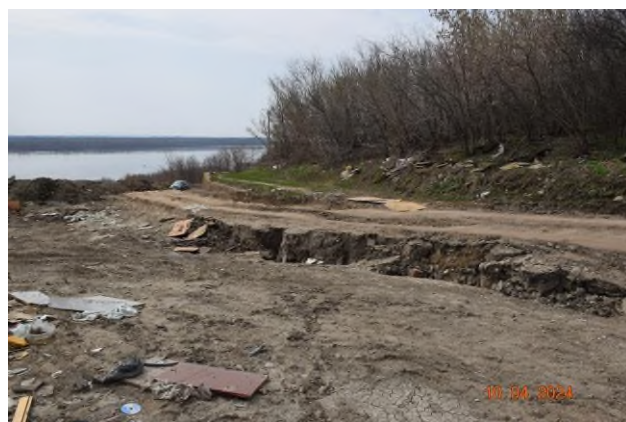
Рис. 2.2.109. Трещины с вертикальным смещением на оползне на ул.Красноармейской, г. Вольск,Саратовская область
