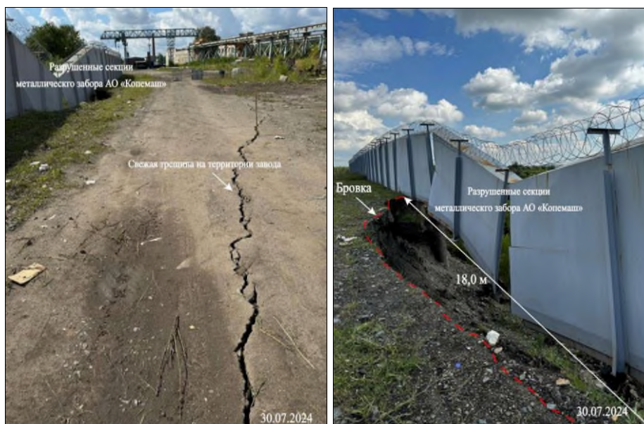
Рис. 2.2.152. Участок разрушения оползневым процессом ограждения АО «Копемаш» и трещины на технологической дороге. Копейский участок оперативного обследования, г. Копейск Челябинская область
