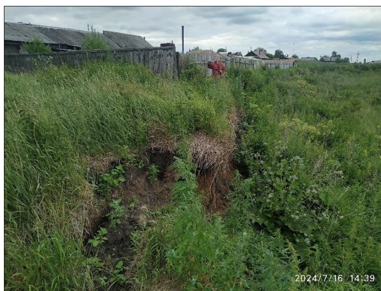
Рис. 2.2.120. Оползень в д. Верхняя Иленка по ул. Жукова. Верхне-Иленский участок, Свердловская область
