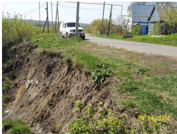
Рис. 2.2.85. Стенка срыва и бровка нового оползневой цирка в районе ул. Пионерская, г. Краснослободск, Республика Мордовия
