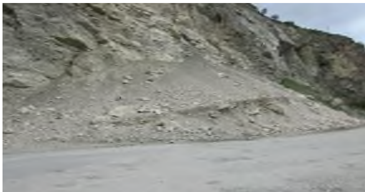
Рис.2.2.68. Перекрытие породами участка автодороги в результате обвала на участке автодороги Карадах - Голотль. Гунибский район, Республика Дагестан.
