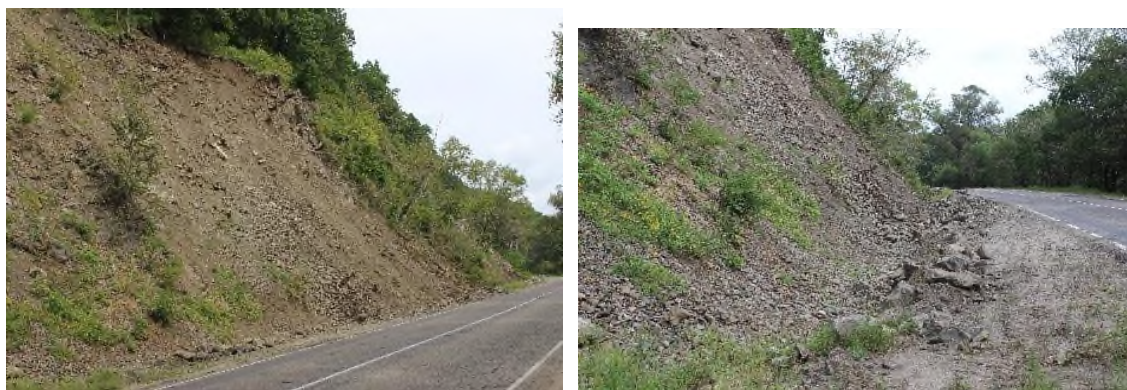
Рис. 2.2.196. Проявления осыпного процесса на участке 244,3 км автодороги Осиновка-Р. Пристань, ПН «Шумный» в Чугуевском МО, по состоянию на 28.08.2024 г.
