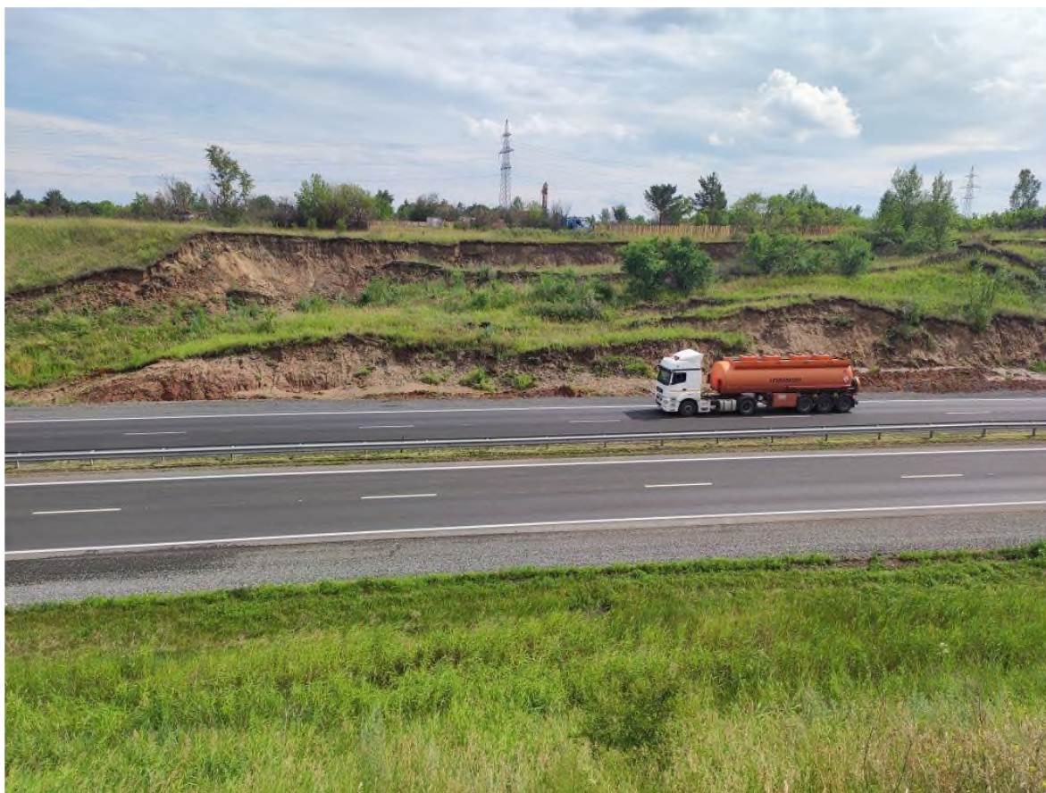
Рис. 2.2.170 Оползневые процессы на участке автодороги Р-257 Братский мост, Алтайский район, Республика Хакасия
