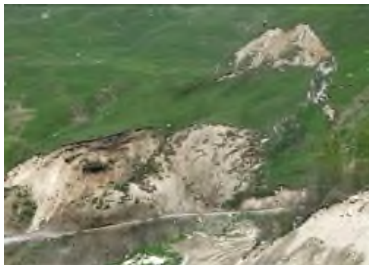
Рис. 2.2.72. Оползень на участке автодороги Камунта – В. Згид (16,5 км), Алагирский район, Республика Северная Осетия – Алания
