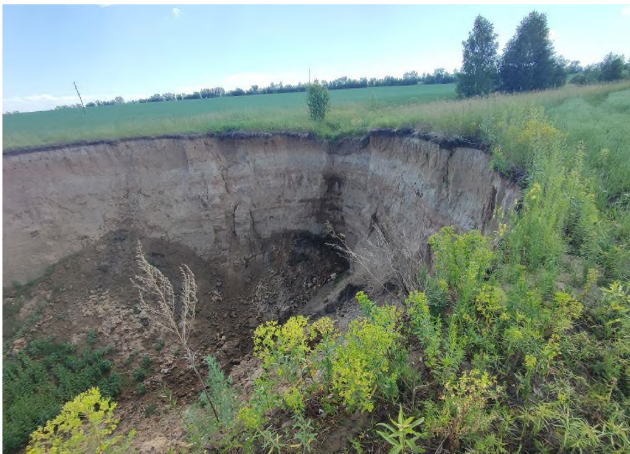
Рис. 2.2.177 Вершина «Основного» оврага на 98 км участка автодороги Минусинск-Беллык, Краснотуранский район, Красноярский край
