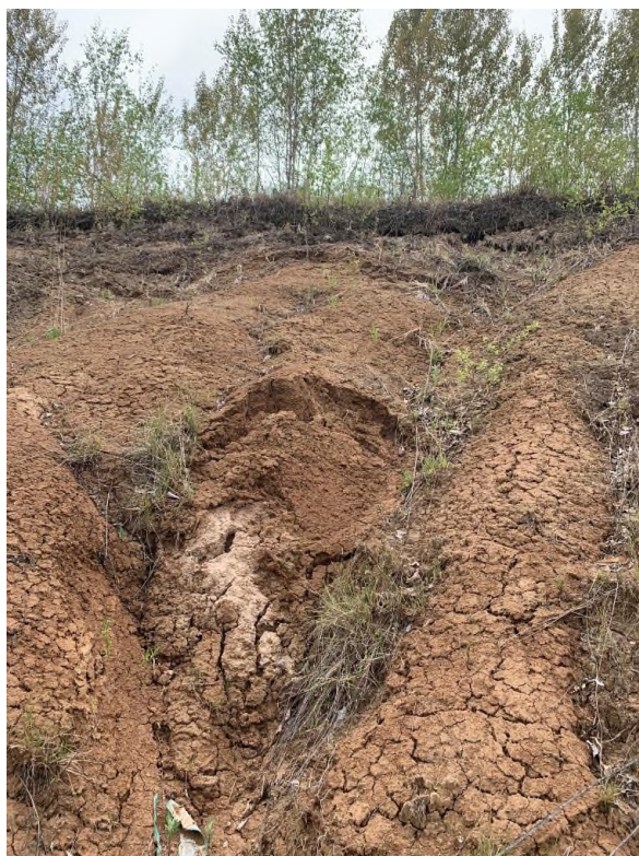
Оползание грунта с образованием эрозионного вреза ПН 27-1110-001 на 117 км А-370 Вяземский район
