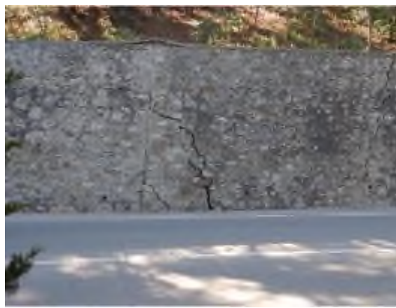
Рис. 2.2.51. Деформации на верховой подпорной стене Алушкинского шоссе в результате активизации оползня, г.о. Ялта, пгт. Ореанда, Республика Крым
