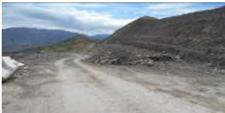
Рис.2.2.67. Оползневые массы на участке автодороги Гуниб-Ругуджа км 4,4, Гунибский район, Республика Дагестан.
