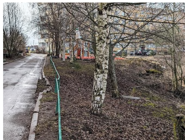
б) смещение бетонного поребрика в сторону падения склона у дома № 6
