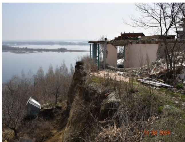
Рис. 2.2.107. Стенка срыва оползня с вертикально смещенным блоком. 9-й Тополиный проезд, г. Саратов, Саратовская область
