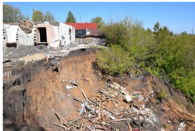
Рис. 2.2.89. Активизация оползня по ул. Водников, г. Тетюши, Республика Татарстан
