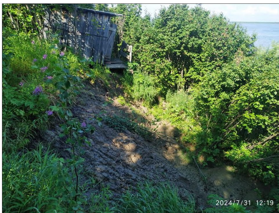
Рис. 2.2.156. Оползень на правом высоком берегу р. Обь в с. Аксарка. Аксарский участок, ЯНАО
