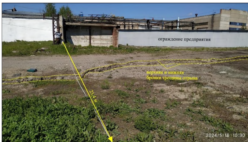
Рис. 2.2.139. Оползневой участок в районе АО «Копемаш». Замер расстояния от ограждения до бровки отрыва. Копейский участок, Челябинская область
