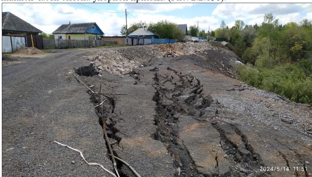
Рис. 2.2.138. Оползневой участок в районе домов № 65-77 по ул. Набережная в г. Аша. Участок Ашинский, Челябинская область
