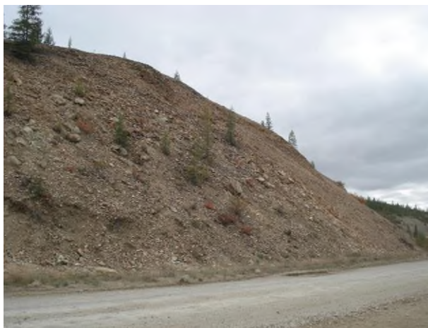
Рис. 2.2.205 Осыпной процесс на участке 1795,4 км автодороги Р504 «Колыма» Магаданская область
