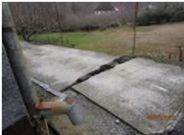
Рис. 2.2.60. Разрыв бетонного покрытия в с. Волковка в результате активизации оползня. Лазаревский район, г.о. Сочи, Краснодарский край. Дата съемки 08.02.2024 г.
