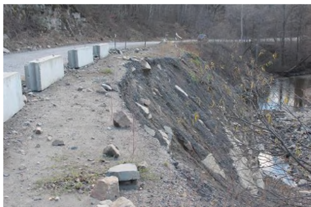
Рис. 2.2.199 Активизация обвального процесса на участке 108,4 км автодороги Р-447 Находка-Кавалерово, Приморский край
