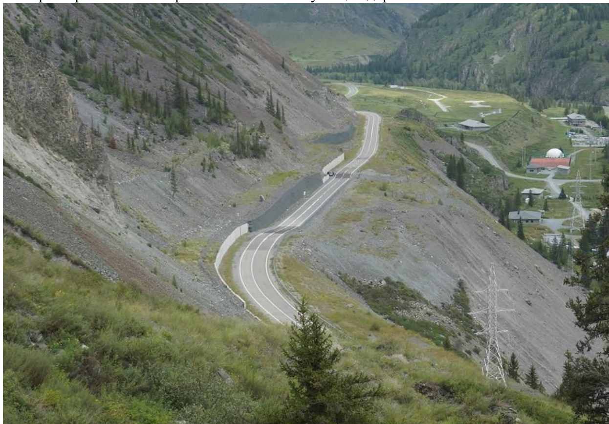
Рис. 2.2.162 Оползневые процессы на автодороге в Алтайское подворье, Республика Алтай
