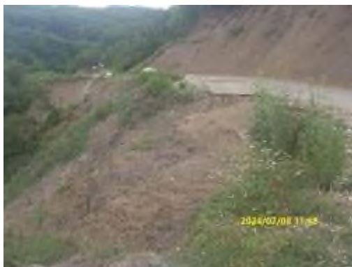
Рис. 2.2.76. Разрушение оползнем полотна автодороги с. Шуани - с. Саясан, 2,43 км, Ножай-Юртовский район, Чеченская Республика
