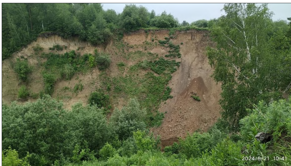
Рис. 2.2.129. Участок развития оползневой процесса на высоком берегу р. Иртыш. Тобольский участок, Тюменская область
