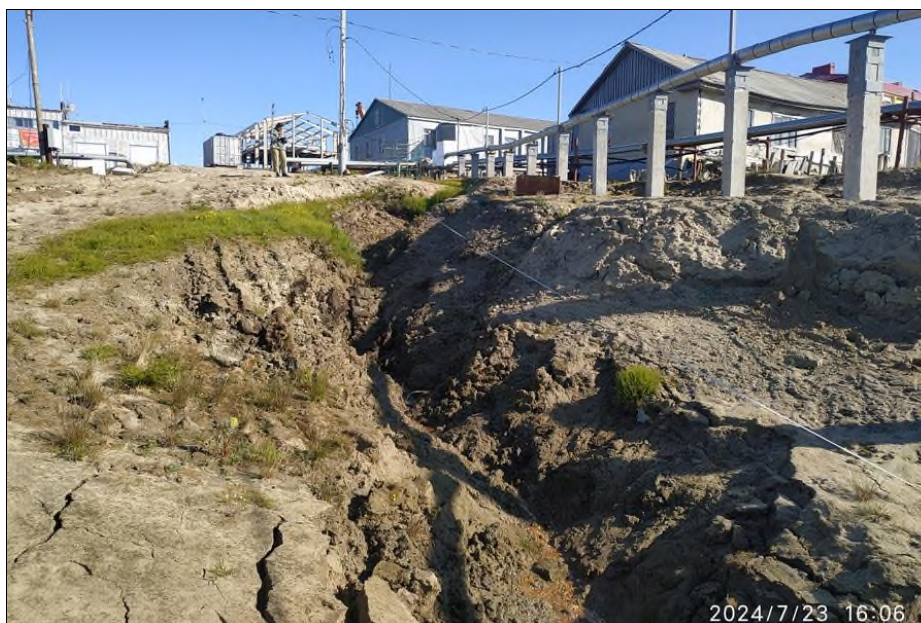
Рис. 2.2.157. Овражная термоэрозия на участке поверхностного водозабора в с. Сеяха (ТН 13а). Сеяхинский пункт наблюдений, ЯНАО
