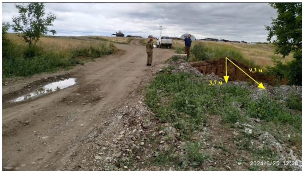
Рис. 2.2.150. Вершина оврага в пос. Тогузак в районе дома № 2 по ул. Правобережная Троицкий участок Челябинская область
