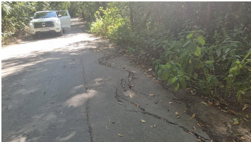
Рис. 2.2.41. Трещина закола оползневого блока пород в районе Хорошево-Мневники возле Троицкой Церкви, г. Москва.
