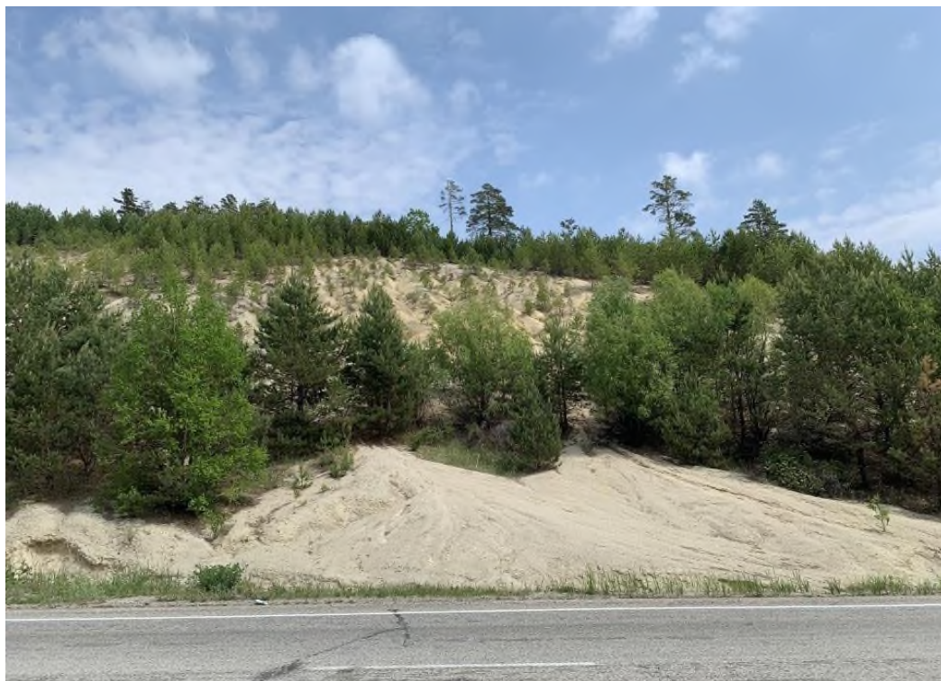
Рис. 2.2.212. Осыпные проявления на 88 км автодороги Свободный-Благовещенск, Благовещенский район, Амурской области.
