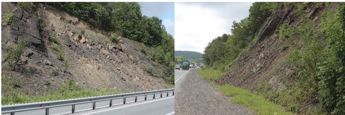
Рис. 2.2.197. Проявления обвально-осыпного процесса на участке 717,35 км автодороги А-370 в 0,67 км западнее ст. Сиреневка Надеждинского муниципального района Приморского края, по состоянию на 26.08.2024 г.
