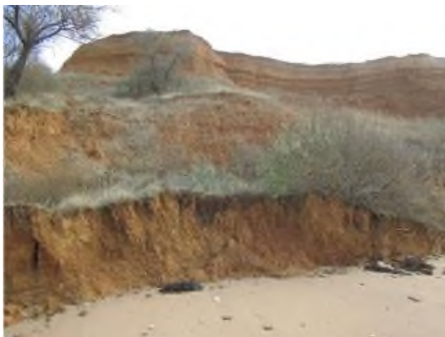
Рис. 2.2.48. Оползневые ступени в с. Береговое, муниципальный округ Феодсоия, Республика Крым.
