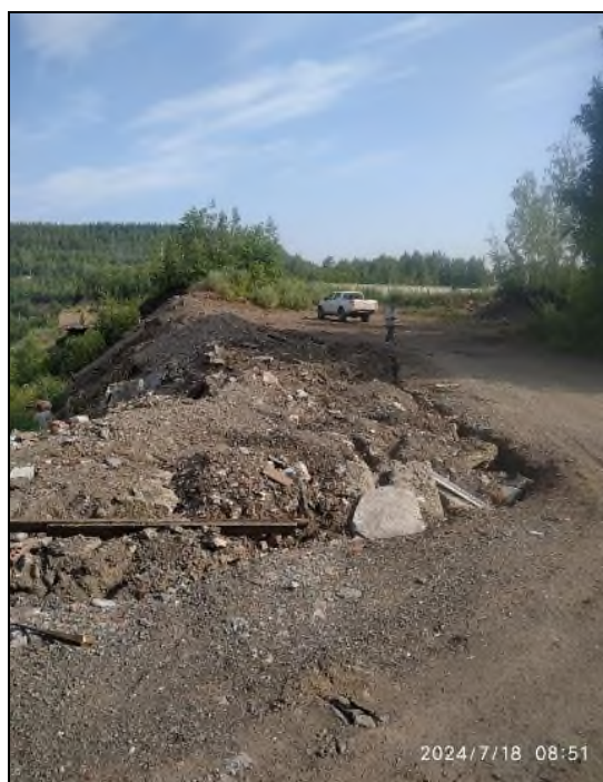
Рис. 2.2.122. Оползень на борту Меднорудянского карьера. Участок Нижнетагильский, Свердловская область
