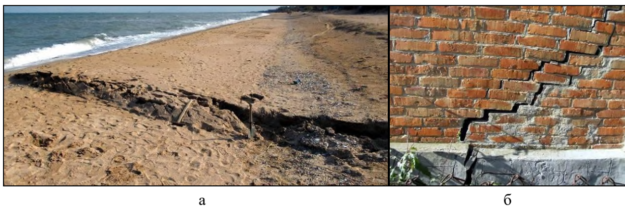
Рис. 1.11 Возникновение разрывных смещений и крупных трещин на побережье при извержении подводного грязевого вулкана Голубицкий, 2015 г. а - смещение на песчаном пляже; б - трещины в фундаменте и стенах зданий.
