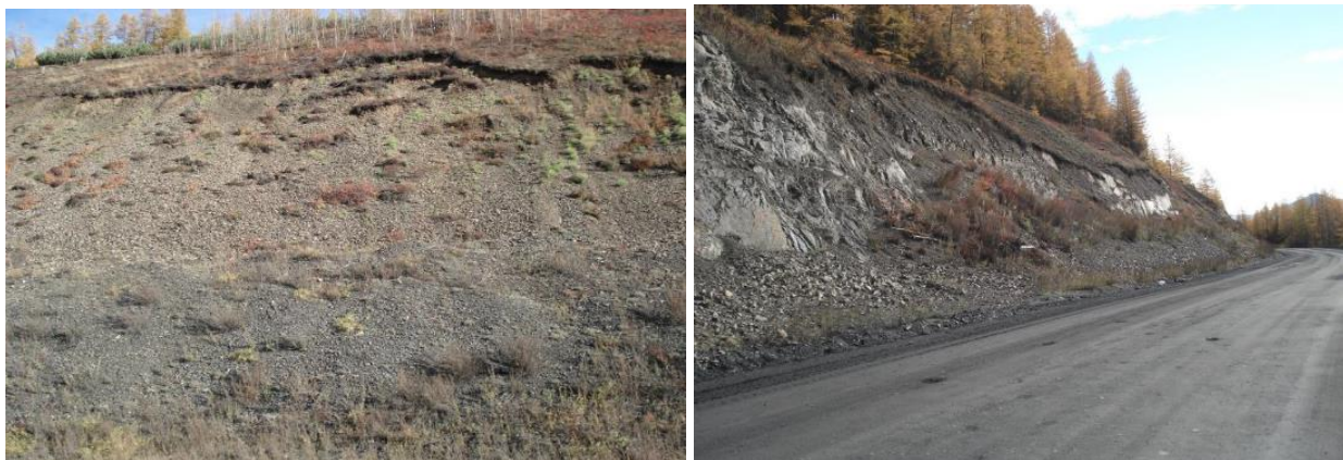
Рис. 2.38. Осыпные конусы у подножия на ПН Сусуманский, 1405 км и 1412 км автодороги «Колыма» Магаданская область, фото 05.09.2024 г.
