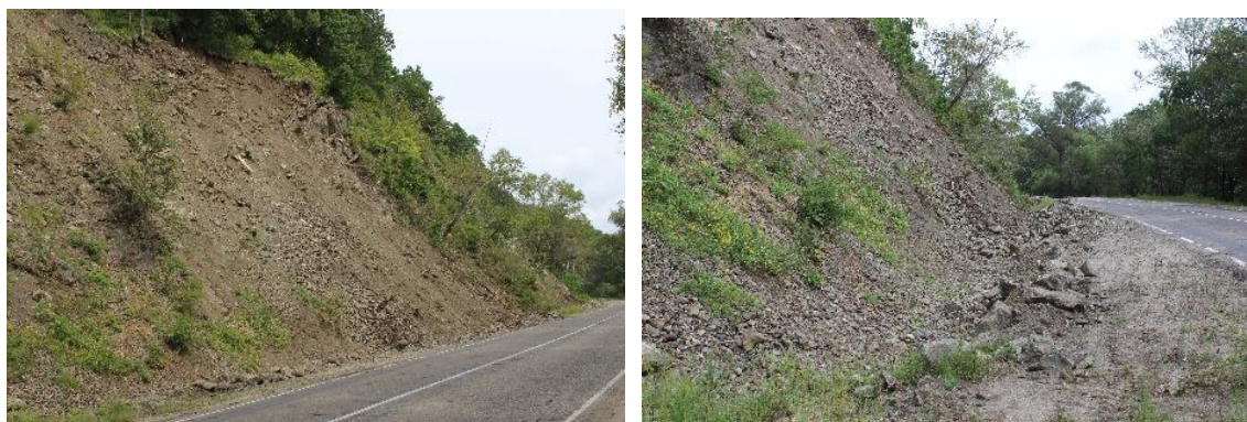
Рис. 2.19. Проявления осыпного процесса на участке 244,3 км автодороги Осиновка-Р. Пристань, ПН «Шумный» в Чугуевском МО, по состоянию на 28.08.2024 г.
