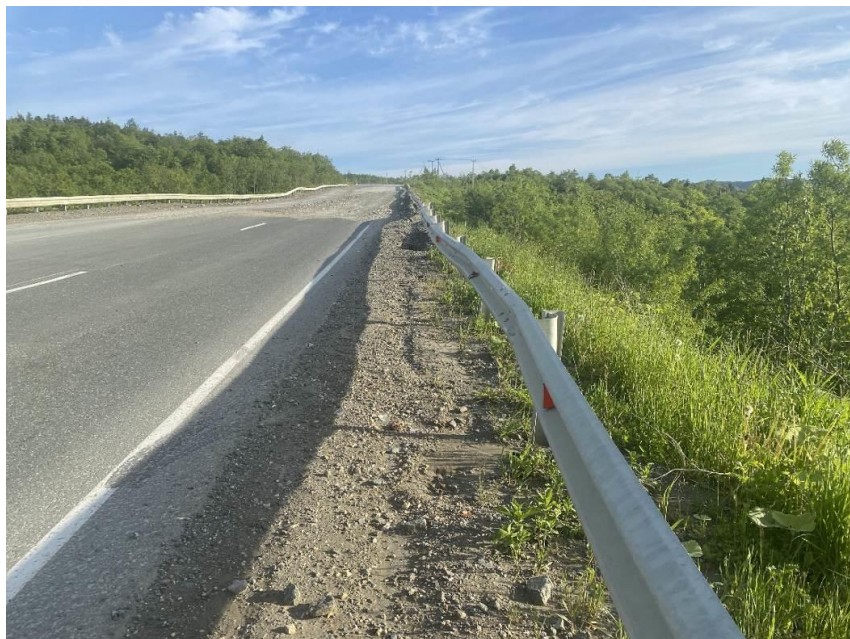
Рис. 2.48. Участок проявления просадочного процесса на дороге Южно-Сахалинск – Оха
