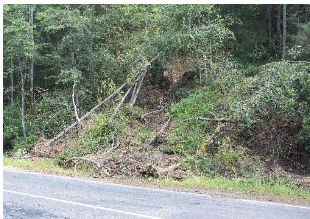
Рис.2.15. Активизация оползневой процесса на участке 314,5 км автодороги Осиновка – Р. Пристань расположенном в 8,5 км с-в п. Горнореченский Кавалеровского района
