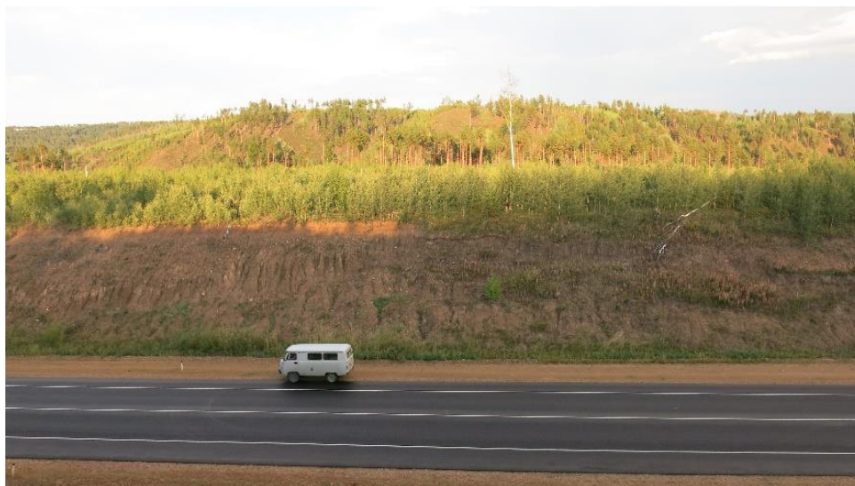
Рис. 2.54. Выположенный склон на левой стороне дороги А-167, на котором возобновилось развитие оползневого процесса
