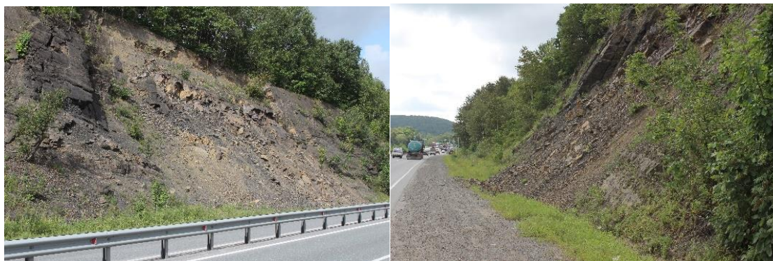
Рис. 2.21. Проявления обвально-осыпного процесса на участке 717,35 км автодороги А-370 в 0,67 км западнее ст. Сиреневка Надеждинского муниципального района Приморского края, по состоянию на 26.08.2024 г.
