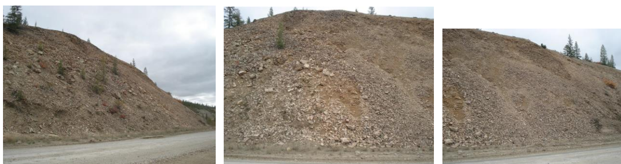
Рис. 2.37. Обвально-осыпной процесс на участке 1795,4 км автодороги Р504 «Колыма» Магаданская область по состоянию 04.09.2024г. (ПН «Талый»)
