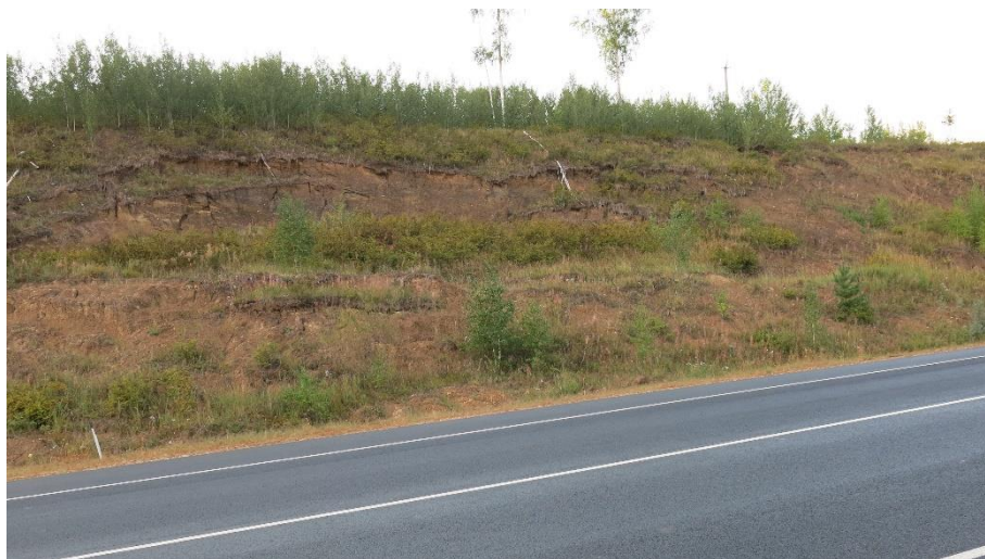
Рис. 2.53. Южная часть оползня на 70-ом км автодороги А-167 Забайкальский край
