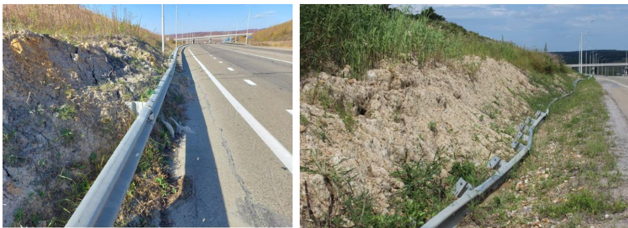
Рис. 2.14. Участок 677,7 км автодороги А370 «Уссури» Разрушение леерного ограждения в результате активизации оползневой процесса (вал выпирания) на ПН «Уссурийский»
