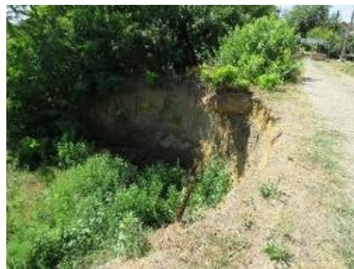
Рис. 2.24. Оползень по ул.Егорлыкской в ст-це Новотроицкой Изобильненского МО
