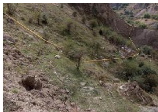
Рис. 2.16. Деформация трубы газопровода и опор
