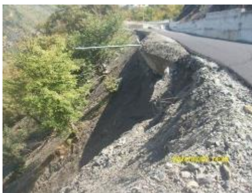
Рис. 2.14. Джейрахский район, с. Даттах разрушение обочины автодороги с покрытием длиной 15 м, шириной 2 м Фото ООО «Центр ГИДИС»
