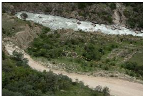
Рис. 2.15. Активный участок оползня на нижнем откосе а/д Урвань-Уштулу (А-154).
