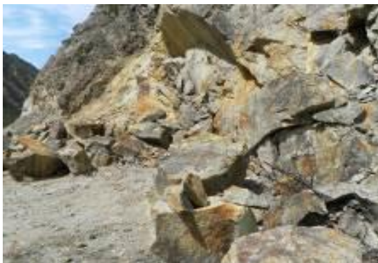
Рис. 2.19. Обвал на участке автодороги Мацута-Дунта, км 9,7, Ирафский район.
