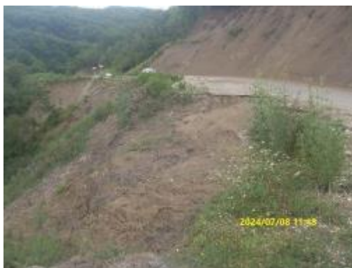
Рис. 2.21. Разрушение оползнем полотна автодороги с. Шуани - с. Саясан, 2,43 км.
