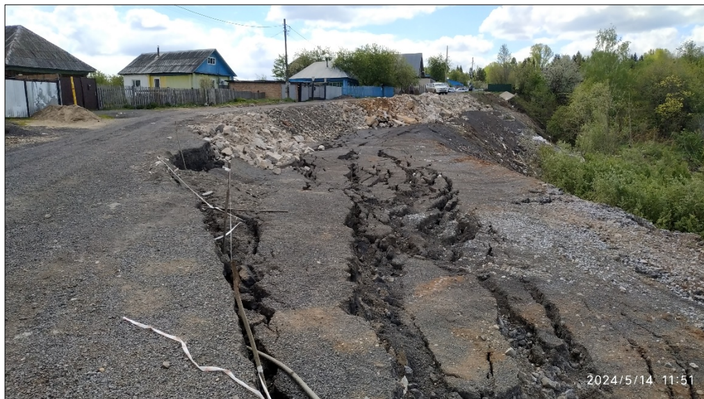
Рис. 2.53. Оползневой участок в районе домов № 65-77 по ул. Набережная в г. Аша (ТН 5). Участок Ашинский, Челябинская область
