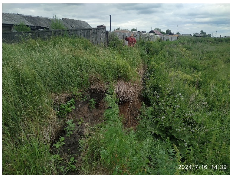
Рис. 2.29. Оползень в д. Верхняя Иленка по ул. Жукова. Верхне-Иленский участок, Свердловская область
