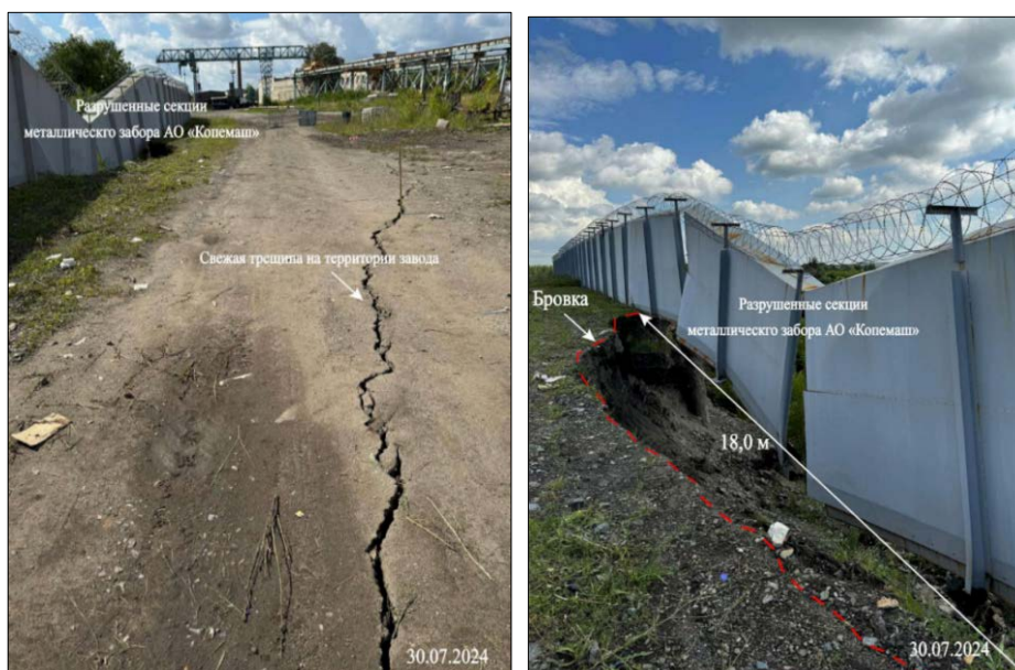
Рис. 2.70. Участок разрушения оползневым процессом ограждения АО «Копемаш» и трещины на технологической дороге. Копейский участок оперативного обследования, г. Копейск Челябинская область
