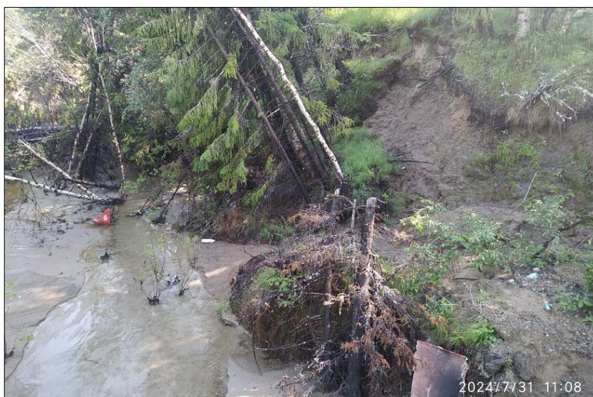
Рис. 2.80. Овражная термоэрозия на участке пересечения путепроводом в с. Аксарка. Участок Аксарский, ЯНАО
