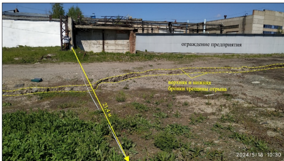
Рис. 2.56. Оползневой участок в районе АО «Копемаш». Замер расстояния от ограждения до бровки отрыва. Копейский участок, Челябинская область
