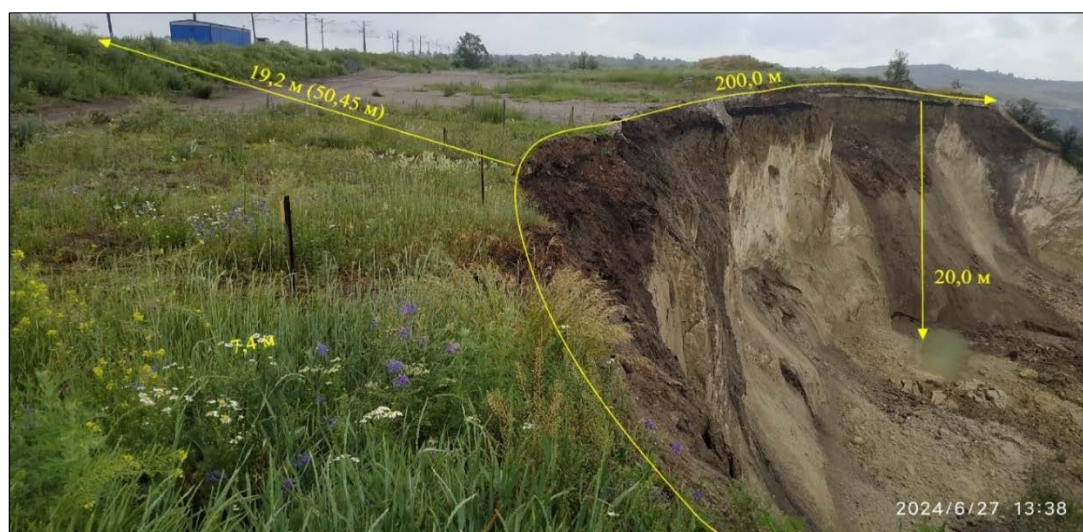
Рис. 2.58. Оползень, угрожающий железнодорожной линии. Красногорский участок, Челябинская область
