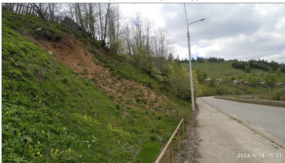
Рис. 2.55. Высыпки грунта с оползневого склона на дорогу на Катав-Ивановском участке, Челябинская область
