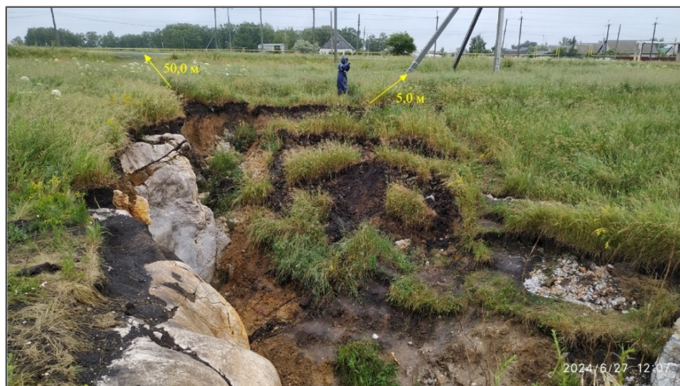
Рис. 2.62. Новый карстовый провал в ТН 6. Красногорский участок, Челябинская область
