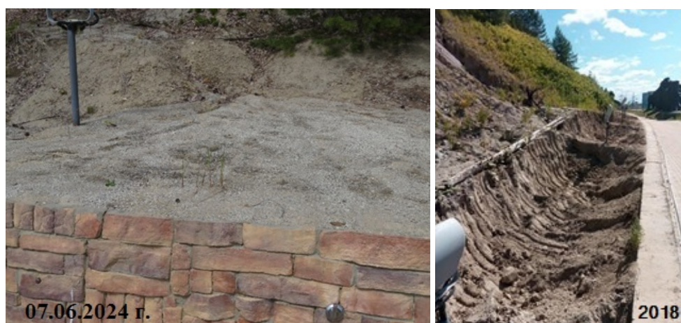
Рис. 2.72. Осыпеприемник между склоном и скульптурной группы «Мамонты», Ханты-Мансийский участок, ХМАО-Югра
