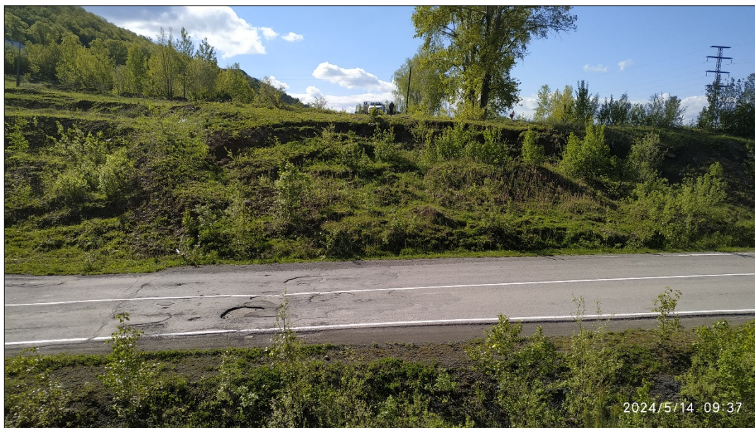
Рис. 2.51. Оползень по автодороге на ГЛК Аджигардак в ТН 1. Участок Ашинский, Челябинская область
