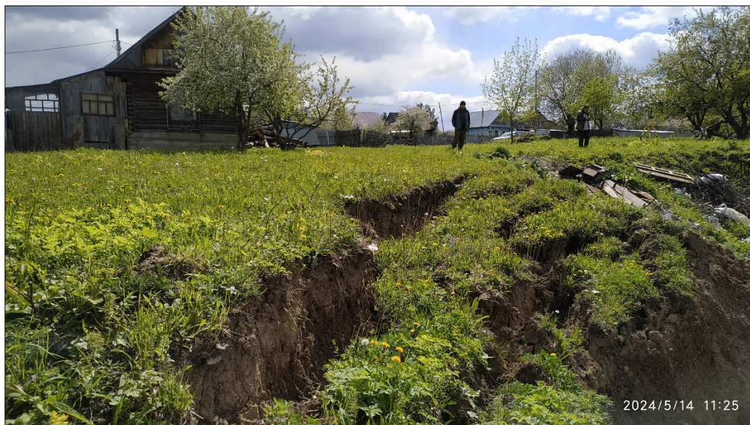
Рис. 2.52. Оползневой участок в районе дома № 30 по ул. Набережная (ТН 4). Участок Ашинский, Челябинская область
