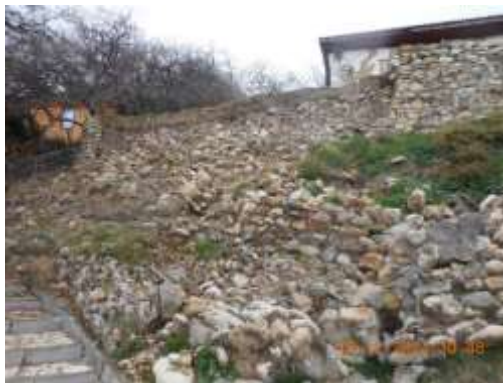
Рис. 2.60. Фиолент. Яшмовый пляж. Разрушение подпорной стены (16.12.2024 г.)
