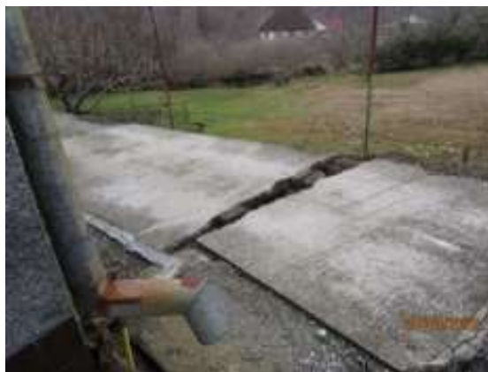
Рис. 2.19. Оползневые подвижки с разрывом бетонного покрытия в с. Волковка Дата съемки 08.02.2024
