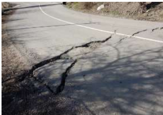
Рис. 2.47 г.о. Ялта, с. Оползневое. Деформации асфальтового покрытия в районе левого борта оползня «Восточно-Кикенеизский» (20)
