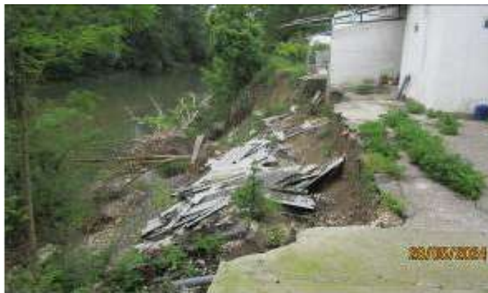
Рис. 2.15. Разрушение домовладения по пер. Рыбному № 20, вследствие оползневой активизации на правобережном уступе р. Пшеха в г. Хадыженске
