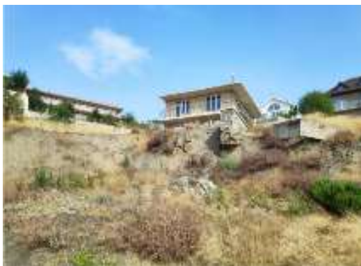
Рис. 2.51 п. Семидворье. Головная часть активной зоны оползня «Судакские ворота» (834). Зависшее основание подпорной стены
