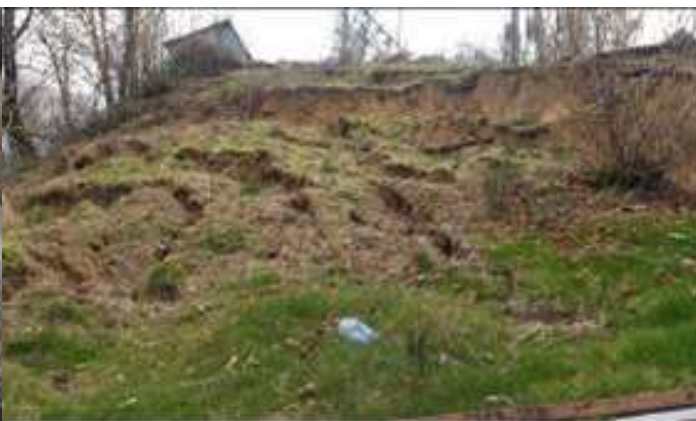
Рис. 2.20. Головная часть обширного оползня в с. Каштаны Дата съемки 27.02.2024
