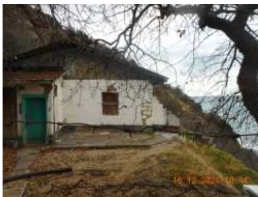
Рис. 2.61 Фиолент. Яшмовый пляж. Трещины на стенах одноэтажного каменного строения (16.12.2024 г.)
