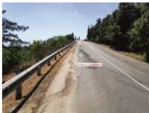
Рис. 2.49. г.о. Алушта, с. Рыбачье. Левый борт оползня «Рыбачье западный» (736). Деформации асфальтового покрытия автодороги 35 ОП РЗ 35К-005 «Алушта – Судак – Феодосия»
