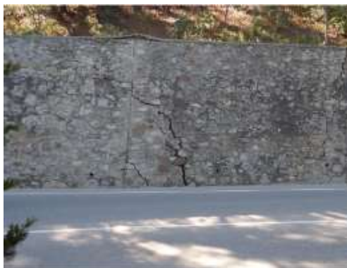
Рис. 2.48 г.о. Ялта, пгт. Ореанда. Деформации на верховой подпорной стене Алупинского шоссе, приуроченные к левому борту оползня «Золотой пляж» (50)
