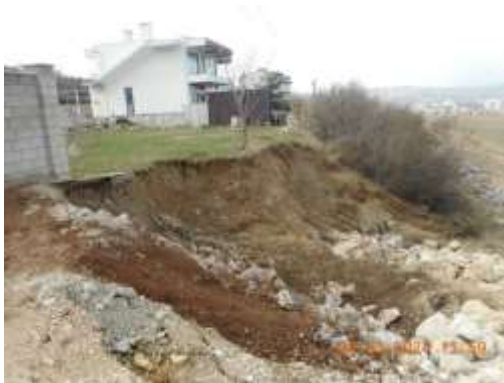
Рис. 2.59. Оползание грунта в районе придомовой территории по ул. Мускатная д. 37, 39 (05.03.2024 г.)
